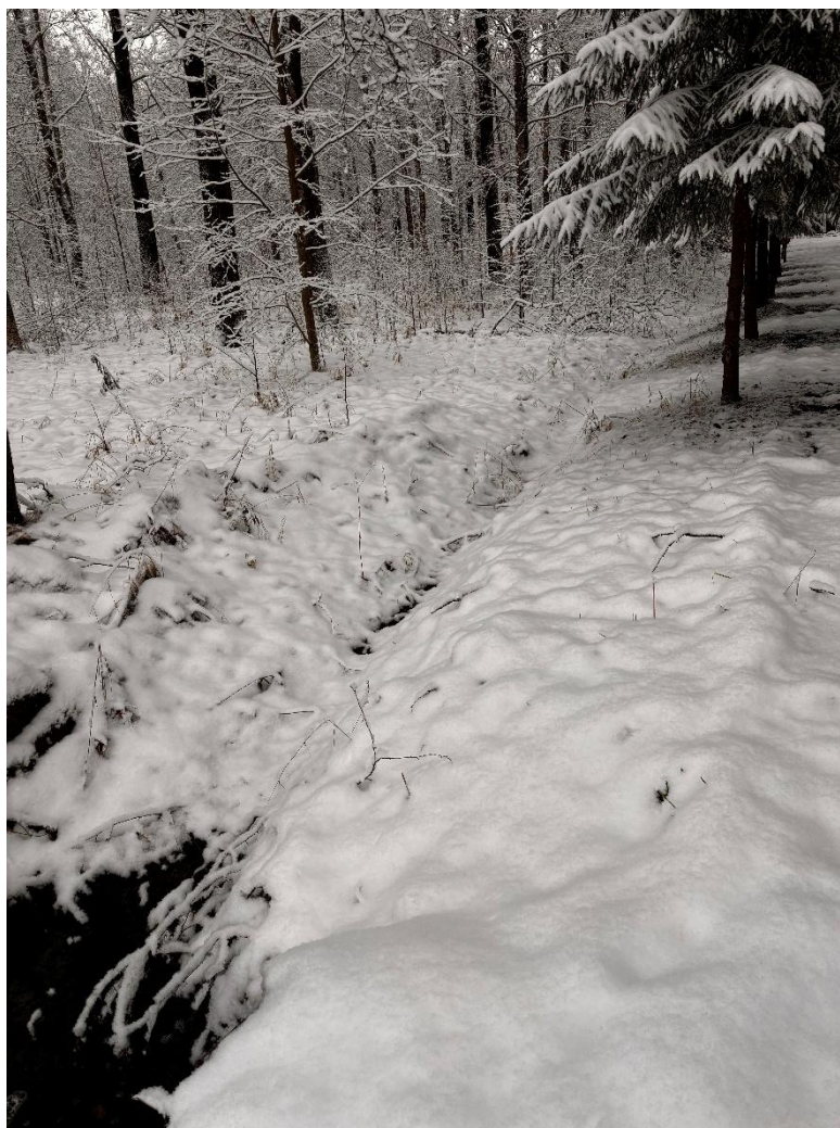
Фото 12. Дренажная канава вдоль аллеи, ведущей к памятнику. Восточная сторона.
