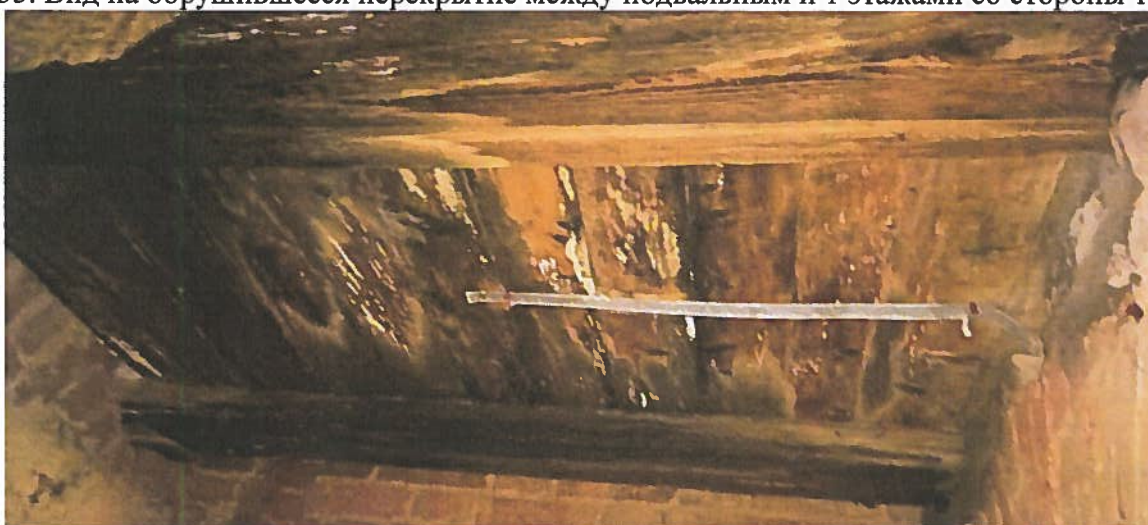
Фото 36. Вид на перекрытие между подвальным и 1 этажами со стороны подвала. Конструкция перекрытия - по деревянным балкам круглого сечения с подбором из доски. Наблюдаются следы намокания и биопоражения древесины конструкций перекрытия.
