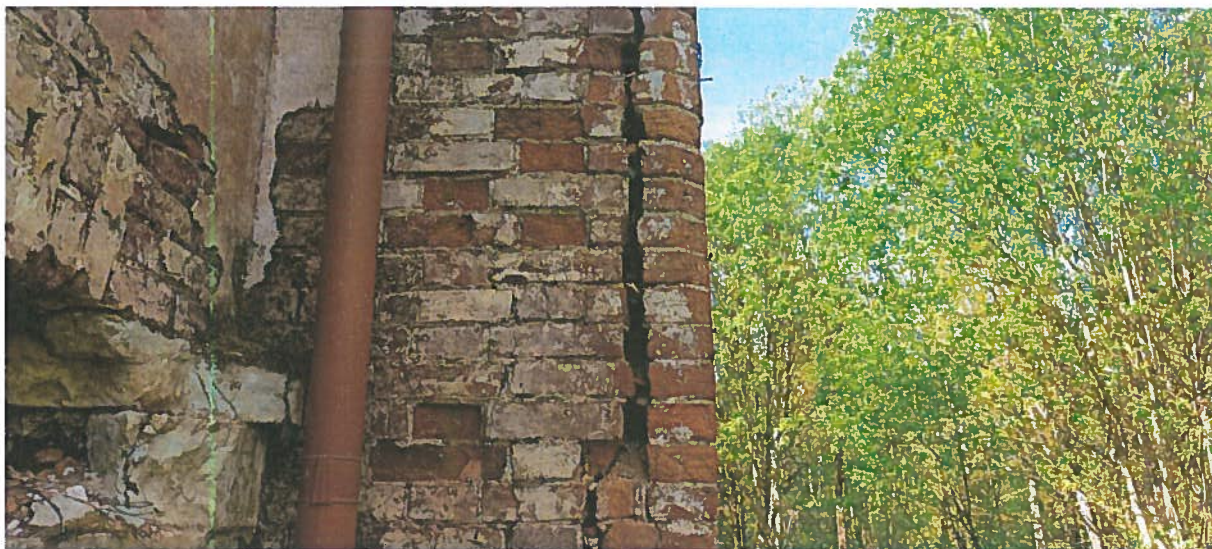
Фото 15. Состояние кирпичной кладки входа северного фасада. Наблюдаются широкие (более 1 см) трещины.
