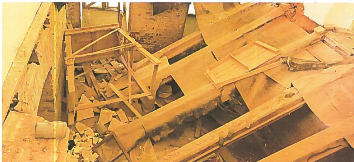
Фото 35. Вид на обрушившееся перекрытие между подвальным и 1 этажами со стороны 1 этажа.
