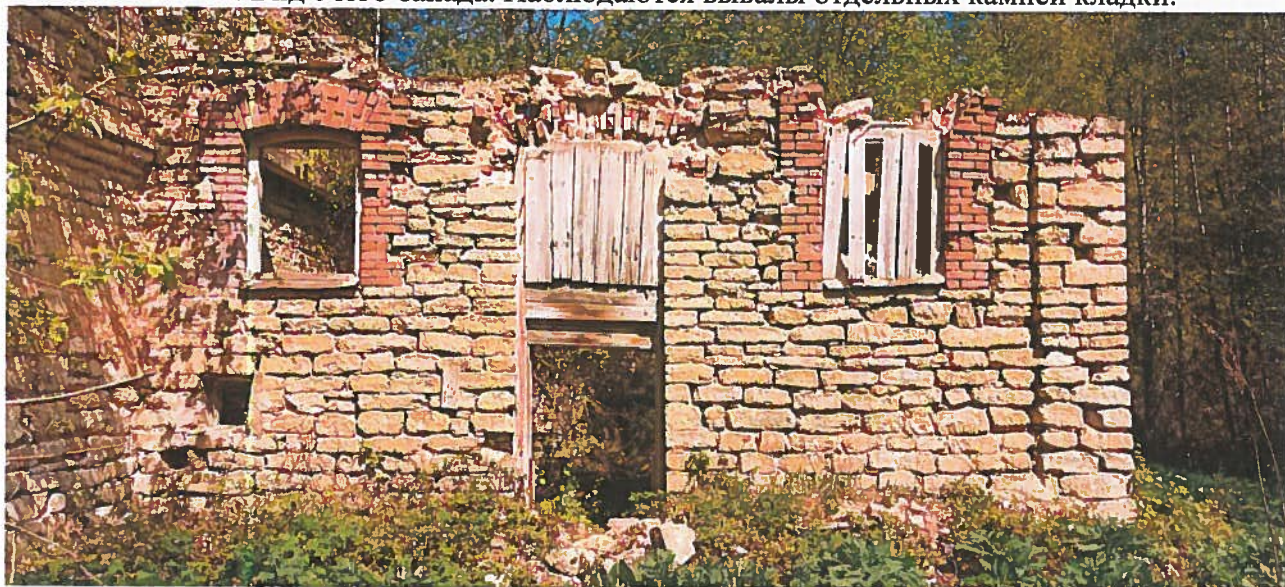
Фото 13. Фрагмент южного фасада. Венчающий карниз утрачен.
