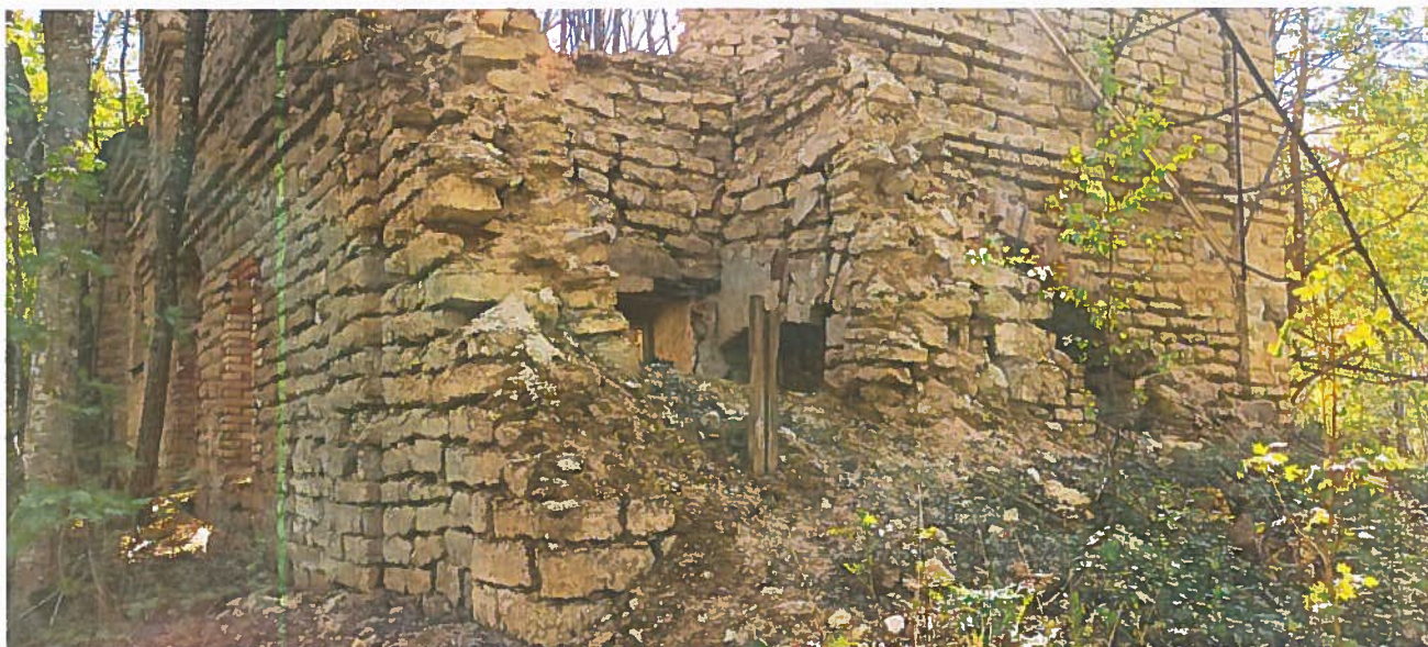
Фото 18. Вид на западный фасад. Наблюдается частичное обрушение наружных стен.
