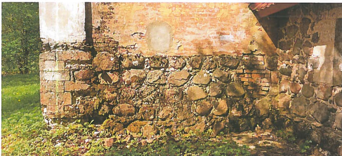
Фото 9. Вид на цоколь восточного фасада. Характер облицовки – крупные гранитные валуны без обработки на известняково-песчаном связующем растворе. Наблюдаются следы утрат отделочного слоя
