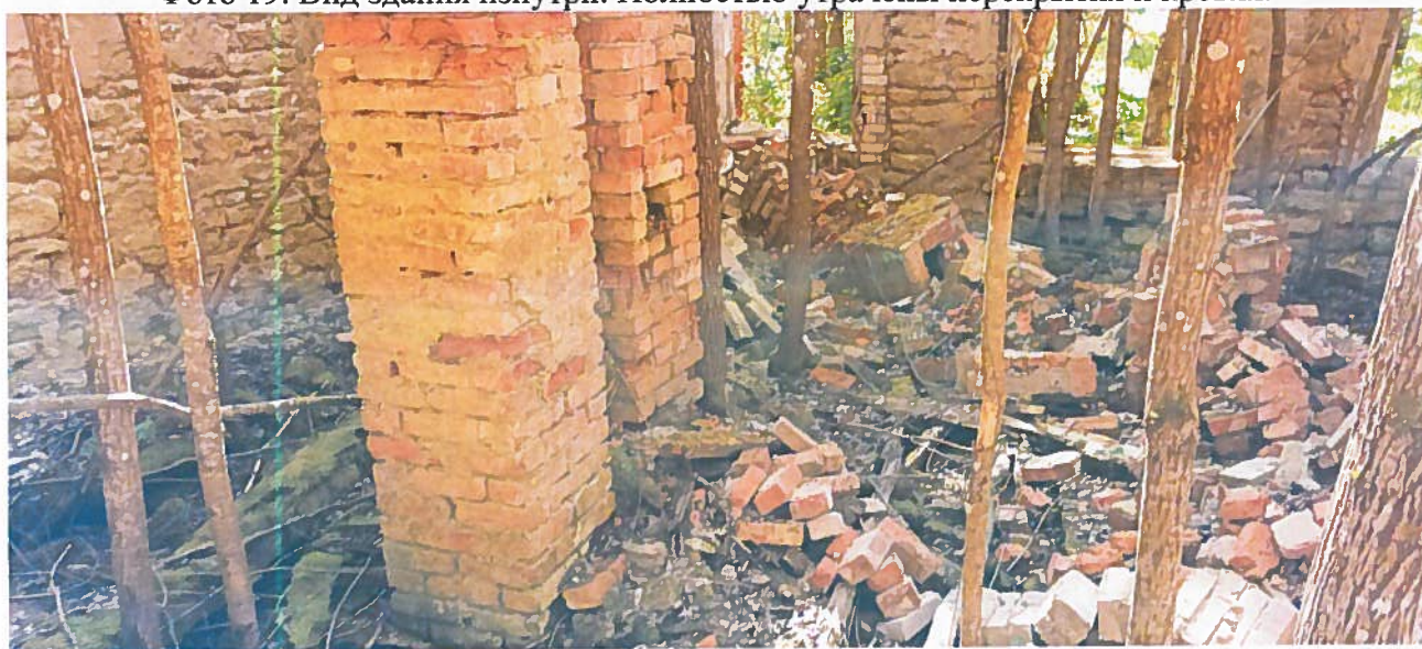
Фото 20. Вид здания изнутри. Полностью утрачены перекрытия и кровля.
