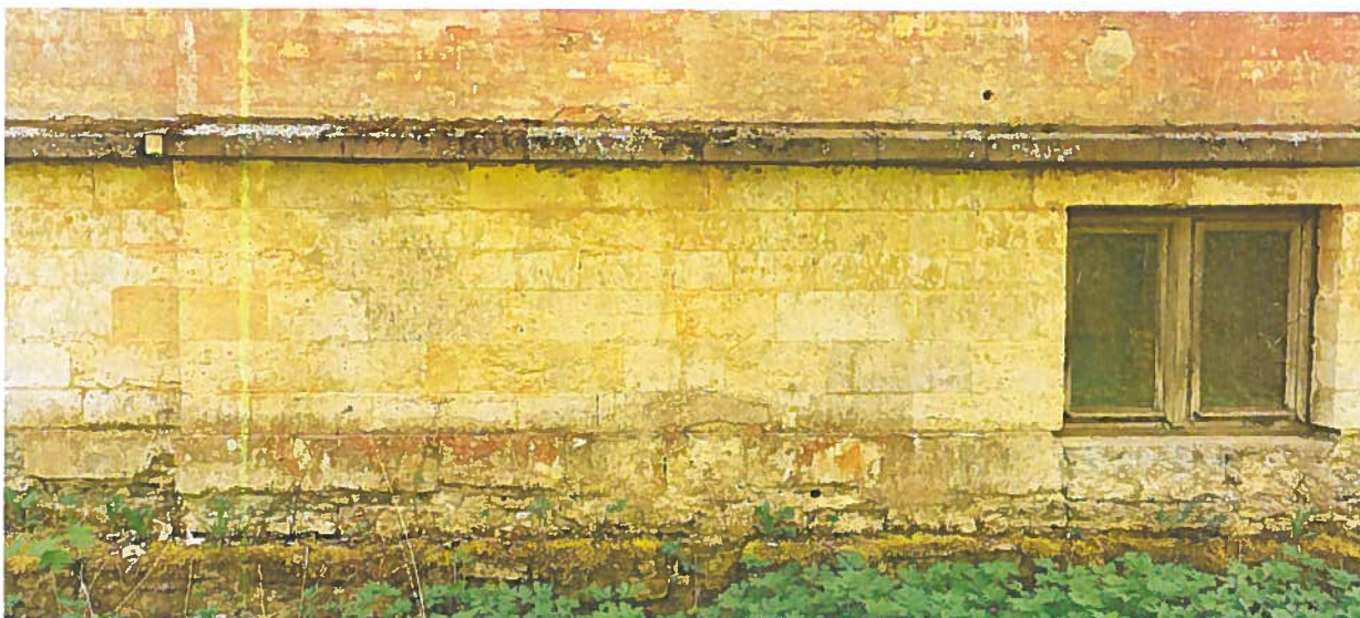
Фото 6. Вид на цоколь западного фасада. Известняковые плиты отделки имеют значительные следы сколов.
