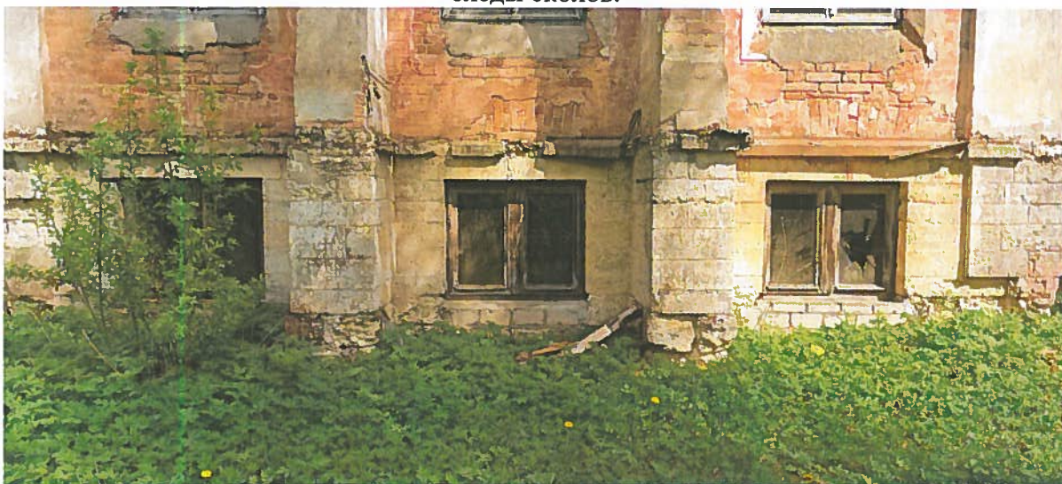
Фото 7. Вид на цоколь южного фасада. Пилоны, поддерживающие балкон 2 этажа. Наблюдаются следы утрат известняковых плит.
