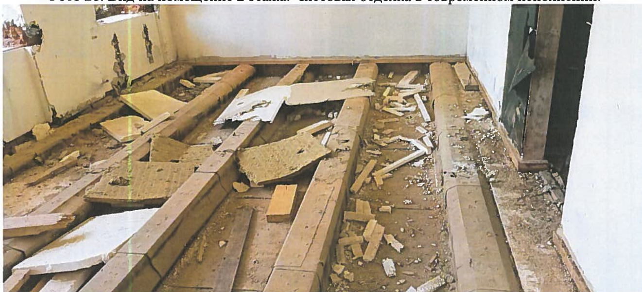
Фото 27. Вид на помещение 2 этажа. Состояние пола. Чистовая отделка утрачена до основания. Перекрытия – по деревянным балкам круглого сечения.
