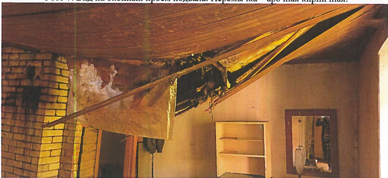
Фото 8. Вид на обрушившееся чердачное перекрытие.
