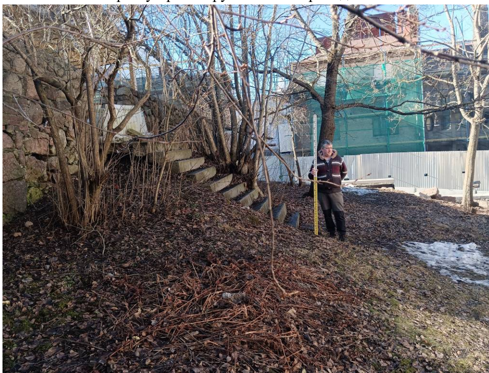
Фото 34. «Наружный газопровод до границ земельного участка, расположенного по адресу: Российская Федерация, Ленинградская область, муниципальный район Выборгский, г. Выборг, ул. Подгорная, д. 14/7 (47:01:0107001:2957). Точка фотофиксации 14. Общий вид на трассу проектируемого газопровода с ВЮВ.
