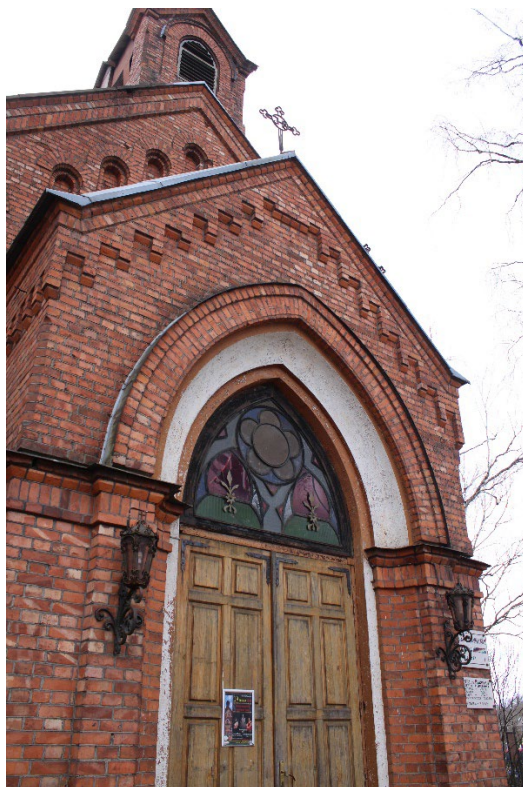
Илл. 5. Входной резалит. Фрагмент. Дата фотофиксации: 14.04.26.
