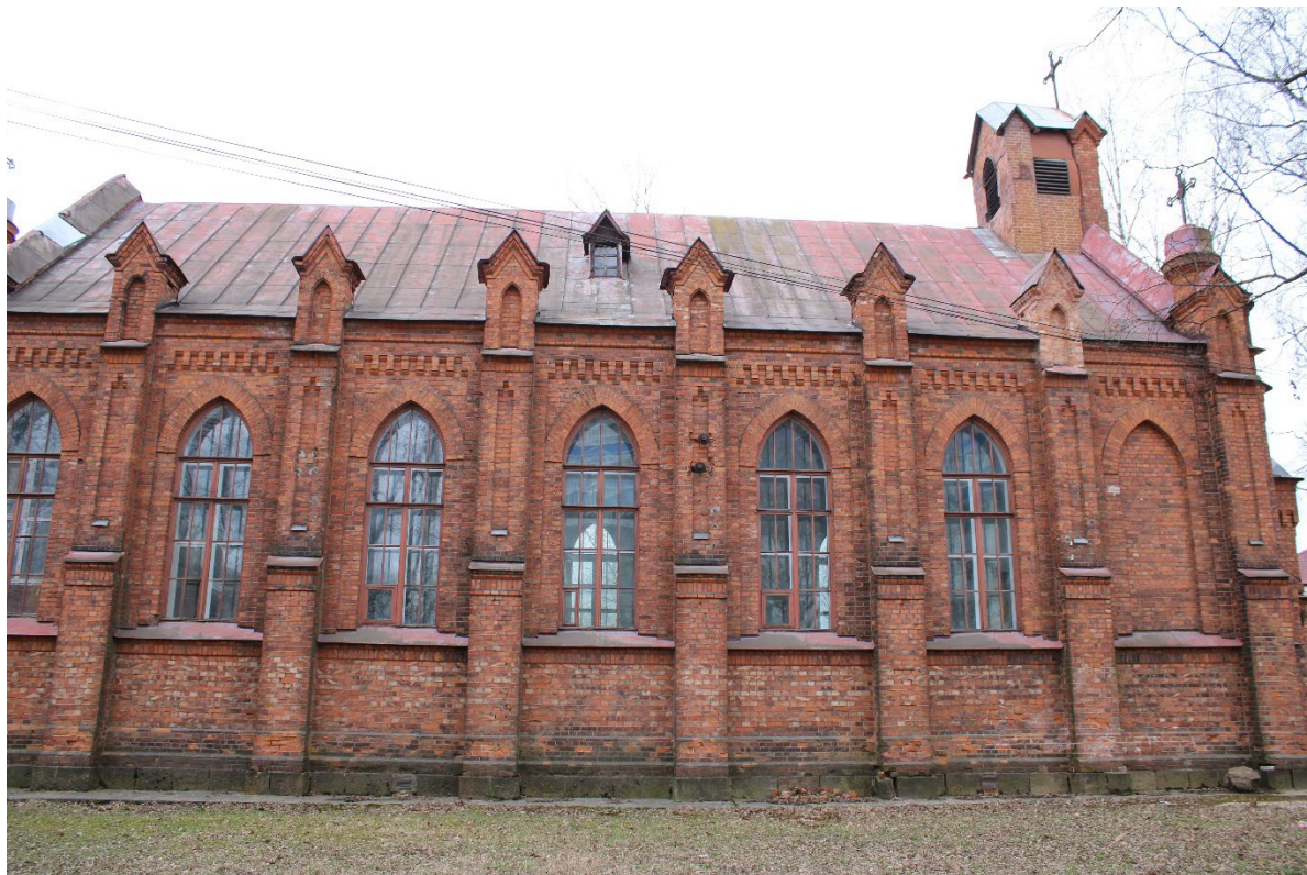
Илл. 14. Юго-восточный фасад. Слуховое окно в плоскости крыши. Фрагмент. Дата фотофиксации: 14.04.26.
