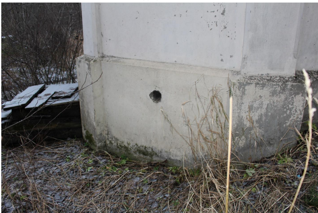
11. Отверстие в цоколе с востока.
