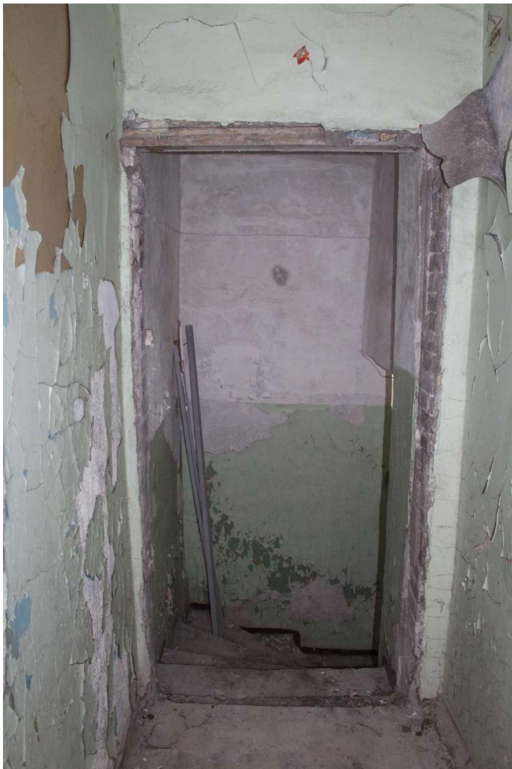
Фото 130. Выявленный объект культурного наследия «Здание школы». Вид на северную лестницу в уровне цокольного – 1-го этажей.
