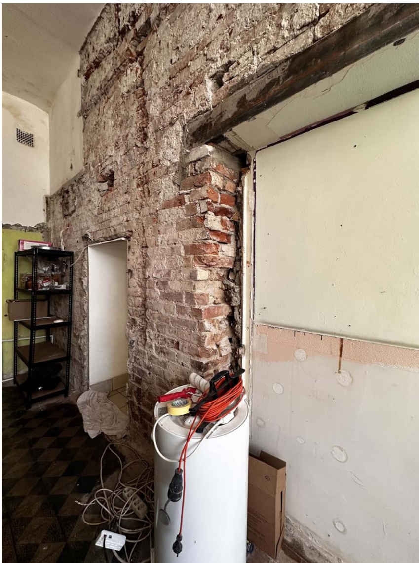
Фото 11. Пом. 1.2. Левая часть кирпичного простенка заложеного проема, пробитого в послевоенное время. Дата съемки: 17.03.2026 г. Автор съемки: Куваева Ю.П.
