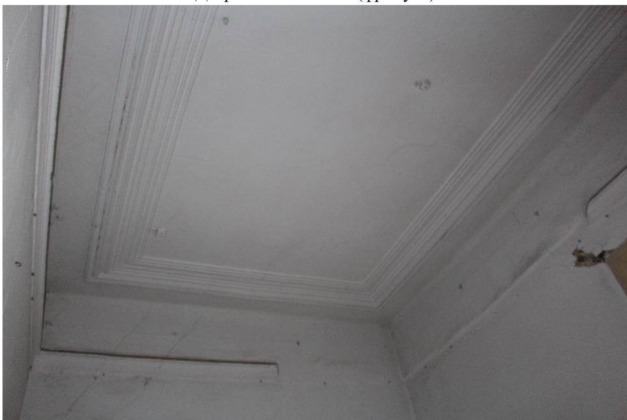
36. Фрагмент потолка помещения во дворе.
