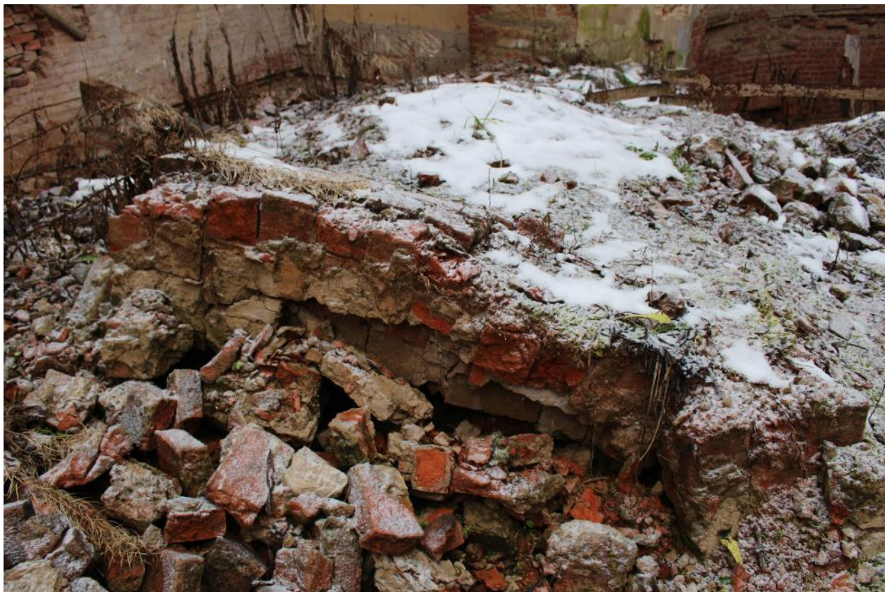
Фото 31. Фрагмент кладки обрушившегося перекрытия.
