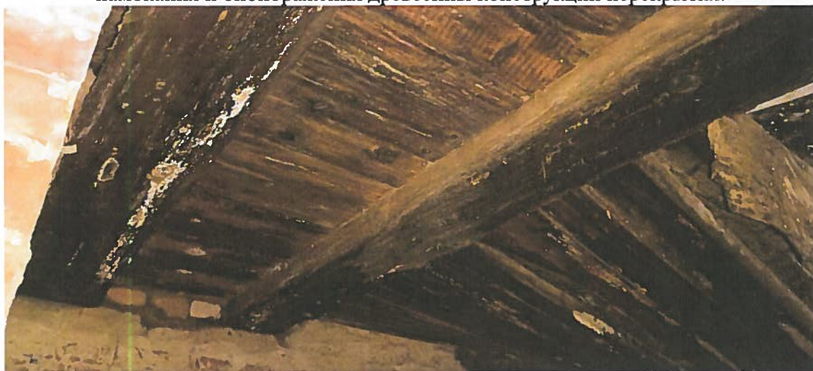
Фото 37. Вид на перекрытие между подвальным и 1 этажами со стороны подвала. Наблюдаются следы намокания и биопоражения древесины конструкций перекрытия.
