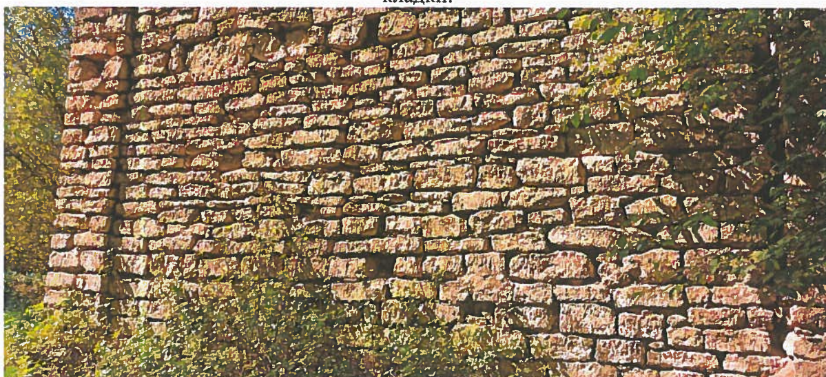
Фото 11. Фрагмент каменной кладки восточного фасада. Межшовное заполнение утрачено.
