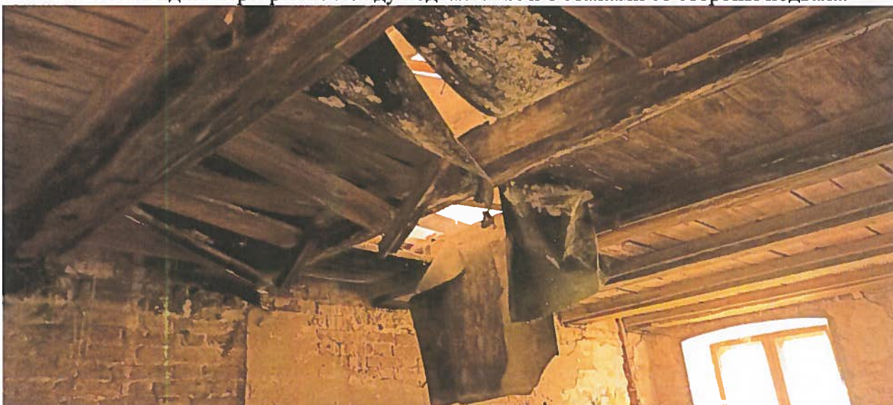
Фото 40. Вид на перекрытие между подвальным и 1 этажами со стороны подвала. Наблюдается обрушение подбора из доски и следы биопоражения балок перекрытия.
