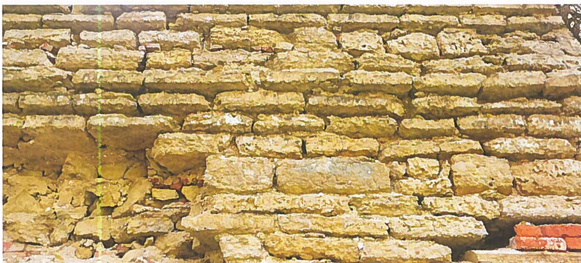
Фото 6. Фрагмент каменной кладки северного фасада. Наблюдается утрата шовного заполнения, деструкция поверхности камня.
