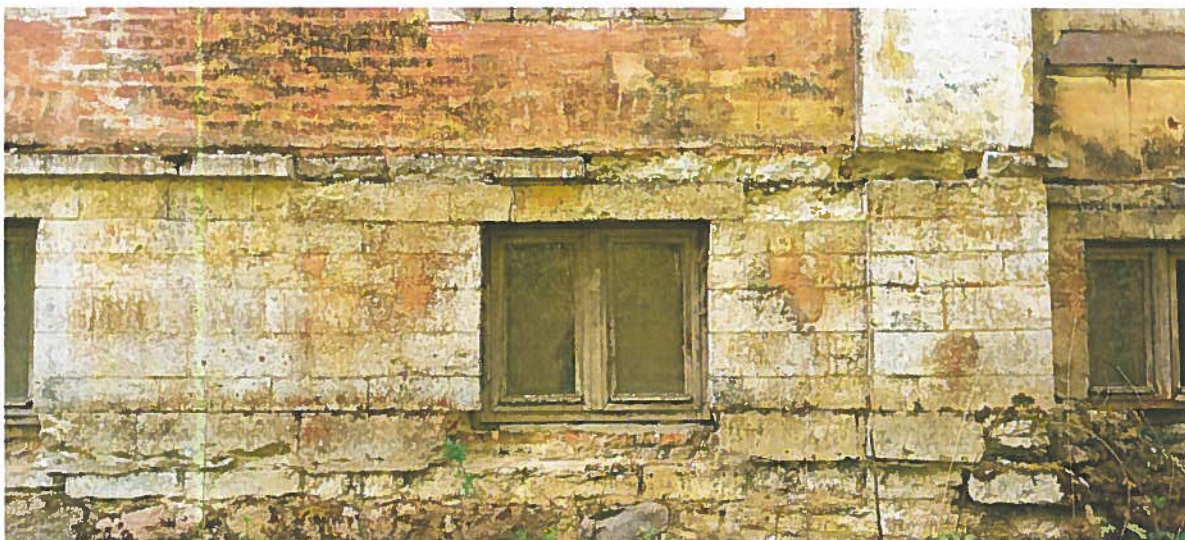
Фото 3. Фрагмент северного фасада, вид на цокольный этаж. Характер отделки – известняковые плиты. Цоколь отделен карнизом из известняковой плиты. Наблюдаются значительные следы сколов карнизной плиты.
