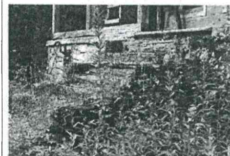
Крыльцо входа на террасу (руинировано)
