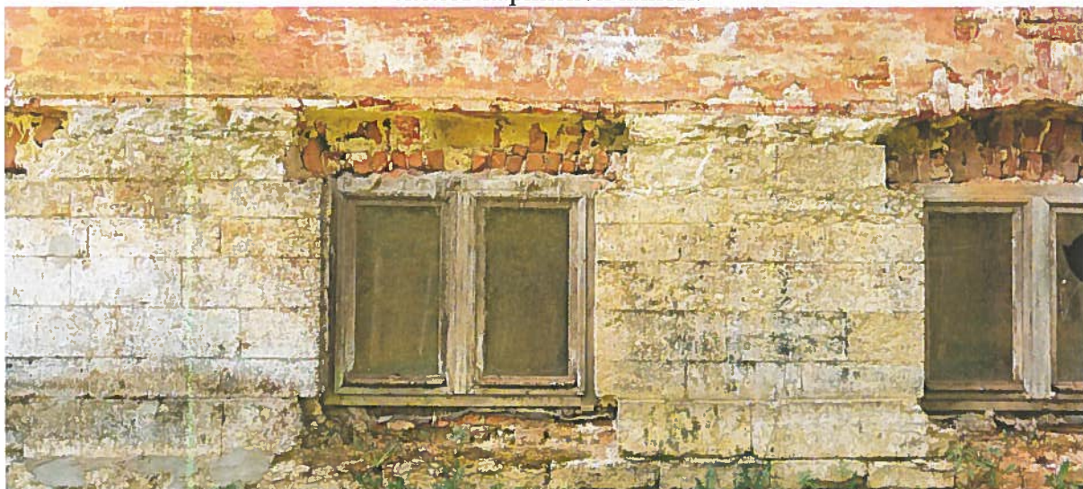
Фото 4. Фрагмент северного фасада. Вид на цокольный этаж. Наблюдается утрата кирпичных клинчатых перемычек оконных проемов.
