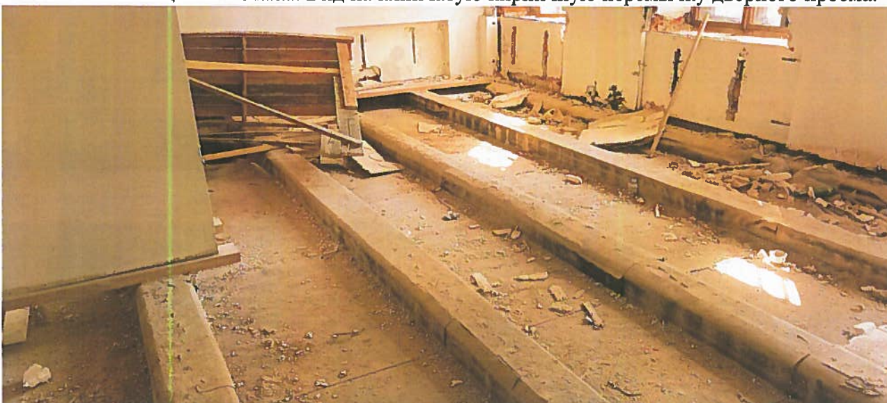
Фото 25. Помещение 1 этажа. Состояние пола. Чистовая отделка утрачена до основания. Перекрытия – по деревянным балкам круглого сечения.
