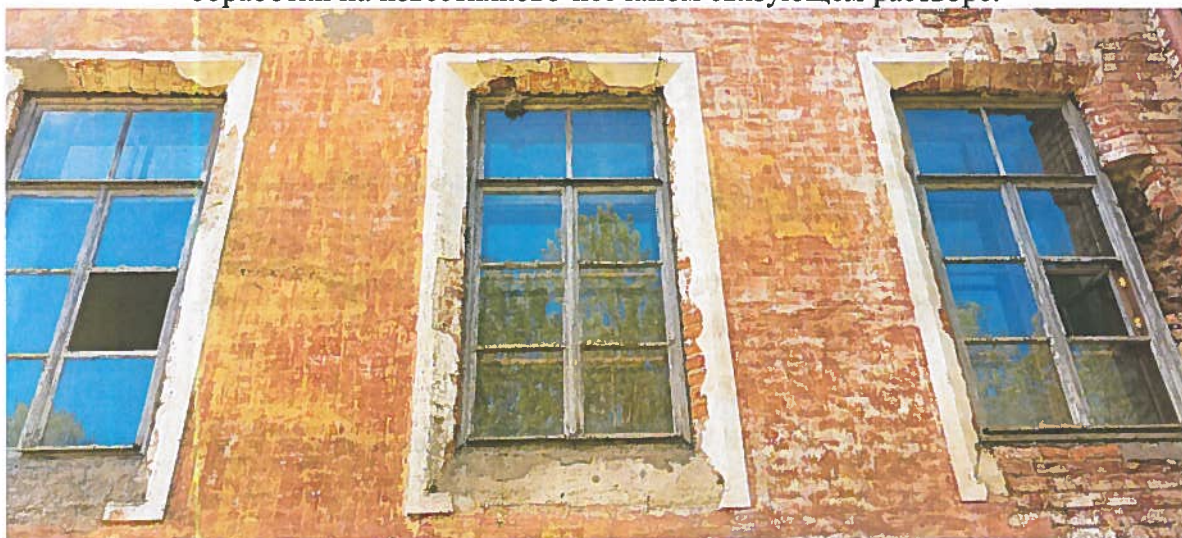
Фото 11. Фрагмент северного фасада. Оконные проемы двухэтажного объема. Наблюдаются вывалы кирпичей.
