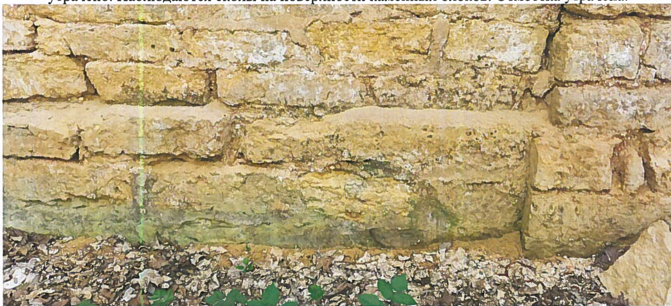
Фото 2. Вид на цоколь. Материал цоколя – обработанные каменные блоки. Шовное заполнение утрачено. Отмостка утрачена.
