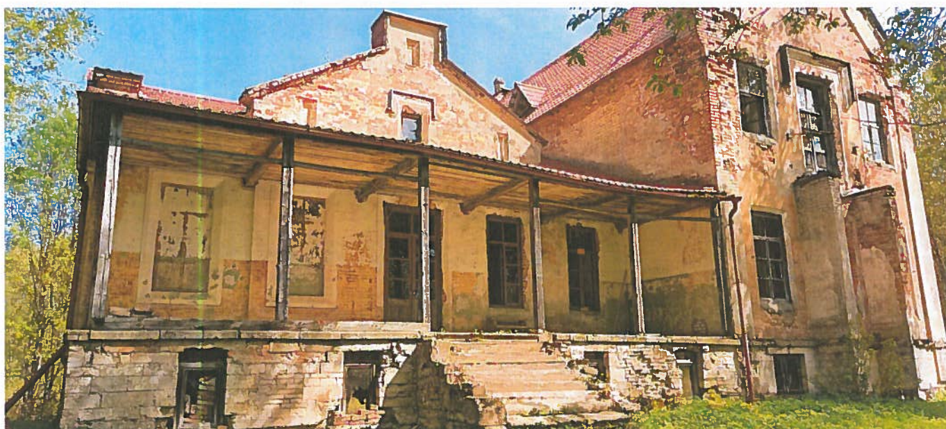
Фото 47. Общий вид южного фасада. Утрачен балкон 2 этажа.
