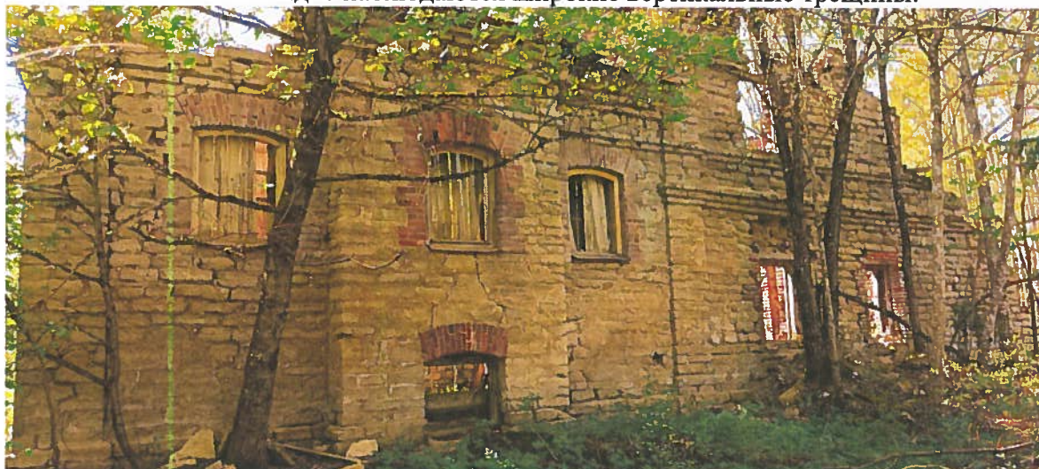
Фото 10. Общий вид северного фасада. Наблюдаются широкие вертикальные трещины каменной кладки.
