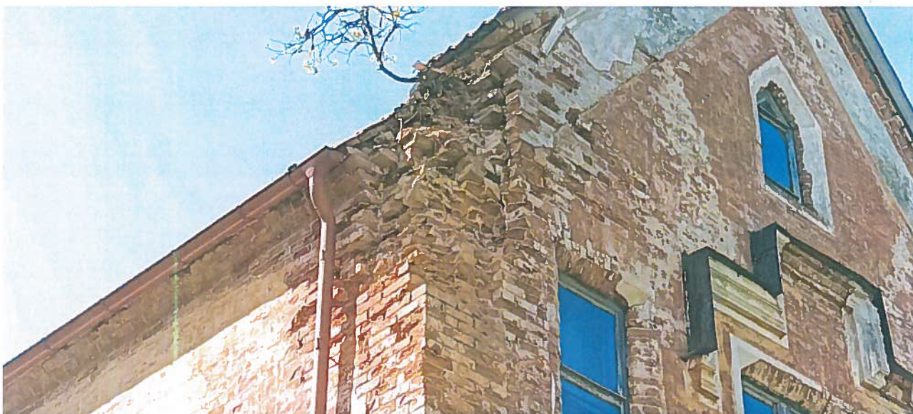
Фото 21. Состояние кирпичной кладки северного фасада. Наблюдаются следы обрушения.
