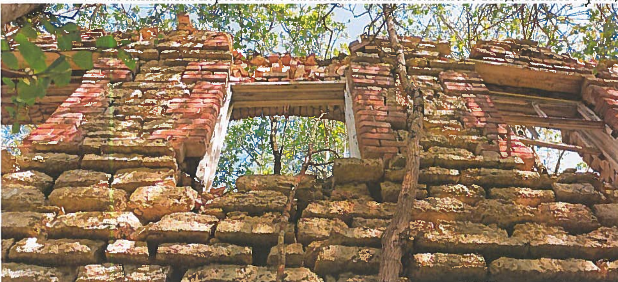
Фото 17. Вид на оконные проемы южного фасада. Обрамлены кирпичной кладкой. Заполнения оконных проемов утрачены.
