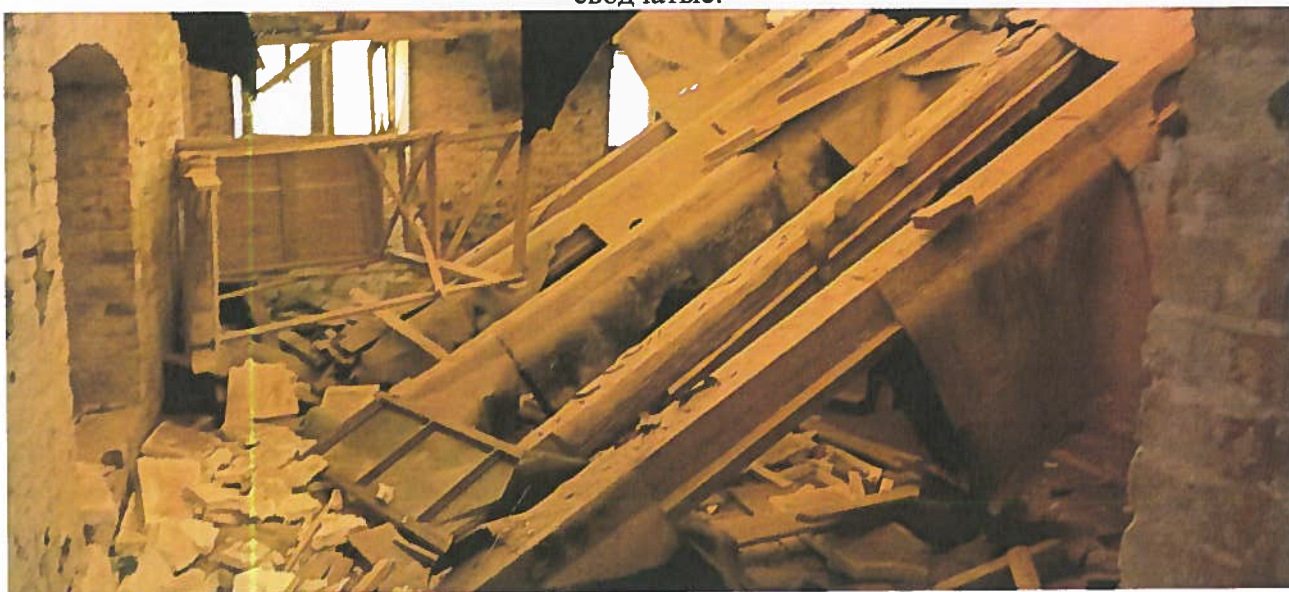
Фото 34. Вид на обрушившееся перекрытие между подвальным и 1 этажами со стороны подвала.
