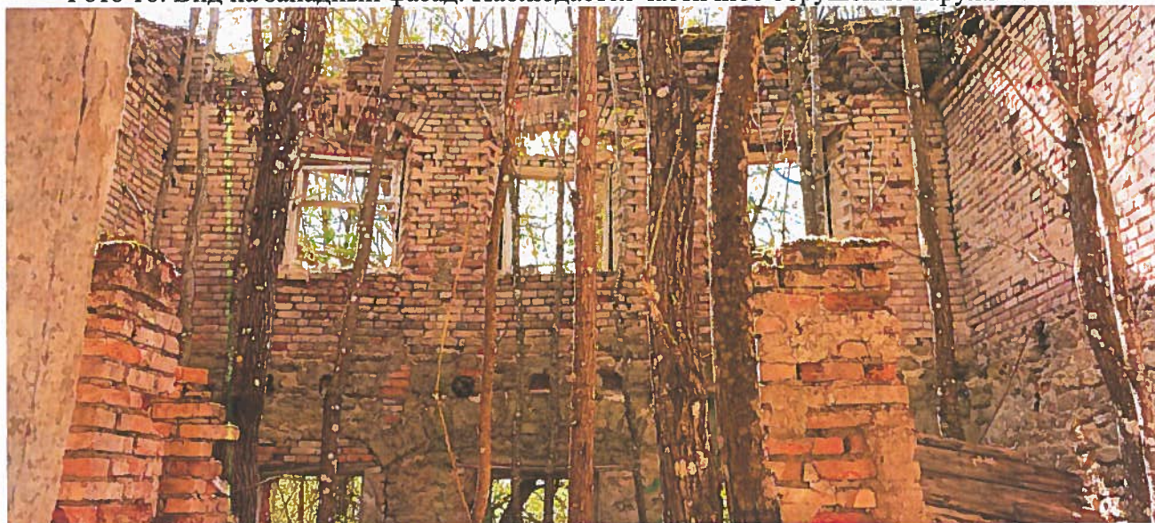
Фото 19. Вид здания изнутри. Полностью утрачены перекрытия и кровля.
