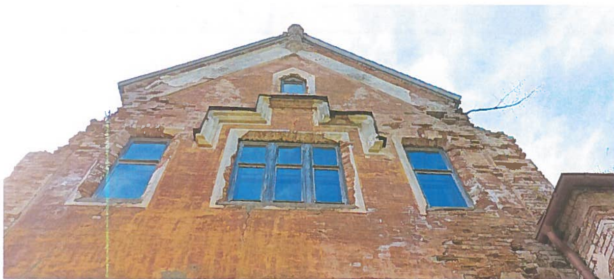
Фото 12. Фрагмент северного фасада. Вид на щипец двухэтажного объема. Наблюдаются вывалы кирпичей.
