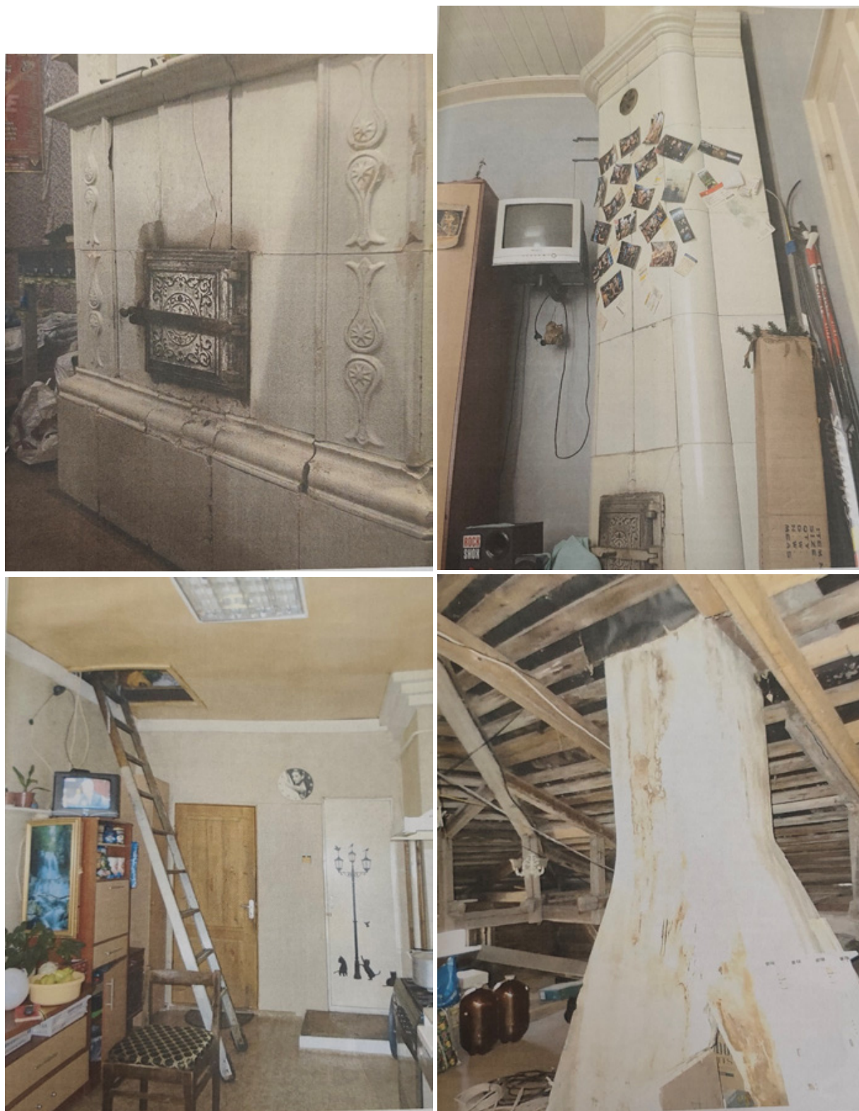
Илл. 70. Квартиры 2 и 4, чердак. Фотофиксация из Акта по результатам ГИКЭ выявленного объекта культурного наследия «Усадьба городская». ООО «ТемплГрупп». Архив Комитета по сохранению культурного наследия Ленинградской области. Оп. 14665. Д. 2137-1 (рег. № 01-10-35/2017 от 22.09.2017).
