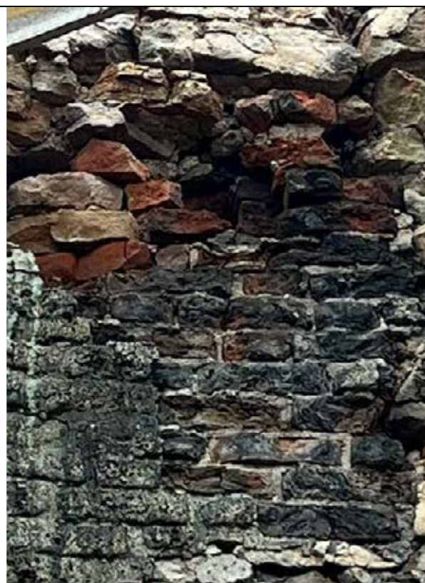
Фото №10 Вымывание кладочных швов внутренней стены
