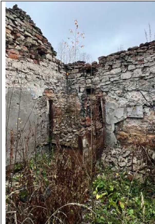
Фото №21. Разрушения кладки стен восточной пристройки
