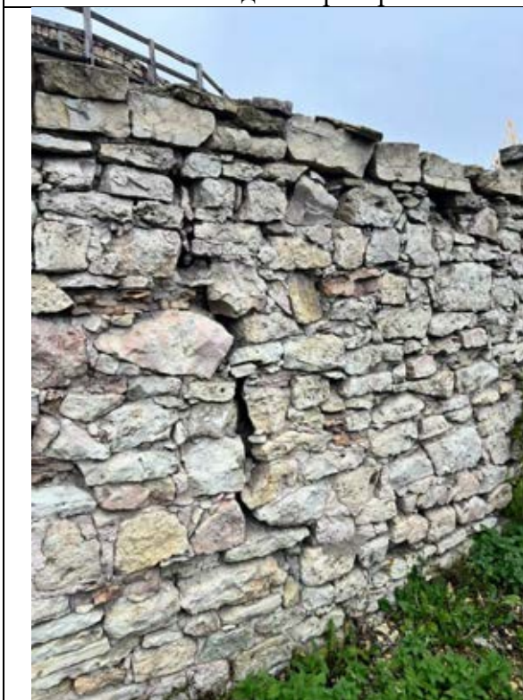
Фото №31. Вымывание кладочного шва из наружной стены
