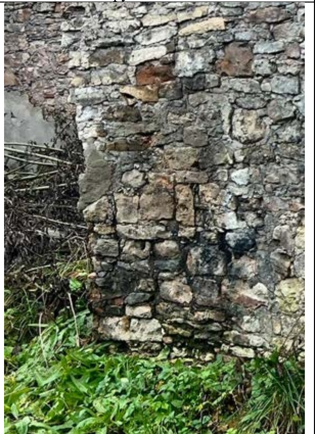
Фото №36. Следы намокания кладки наружной стены
