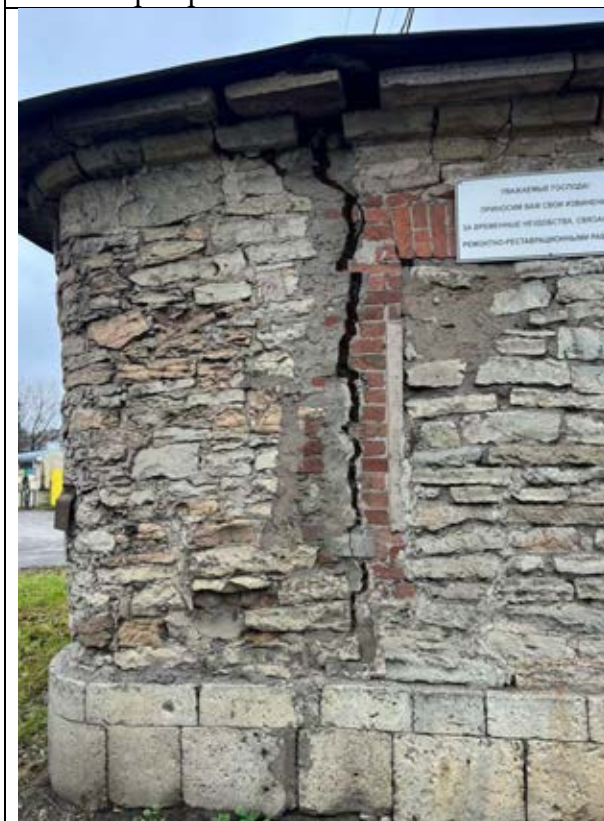
Фото №27. Вертикальная трещина раскрытием до 3 см в стене северной пристройки
