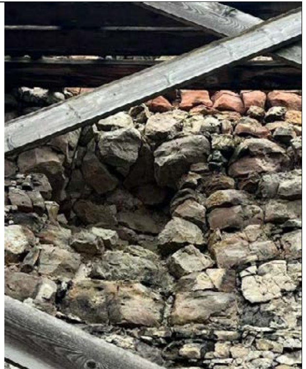
Фото №2 Нарушение целостности кладки внутренней стены
