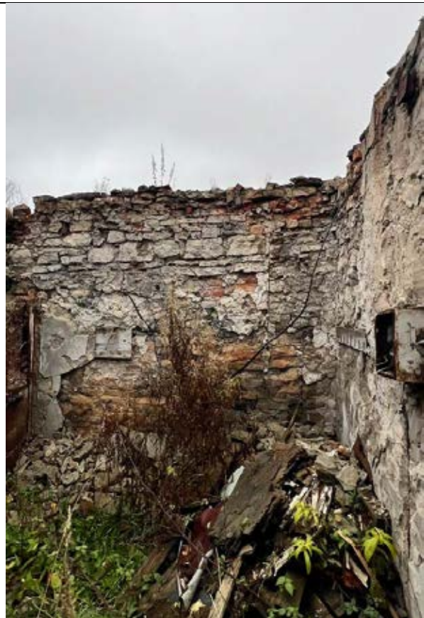
Фото №22. Разрушения кладки стен восточной пристройки
