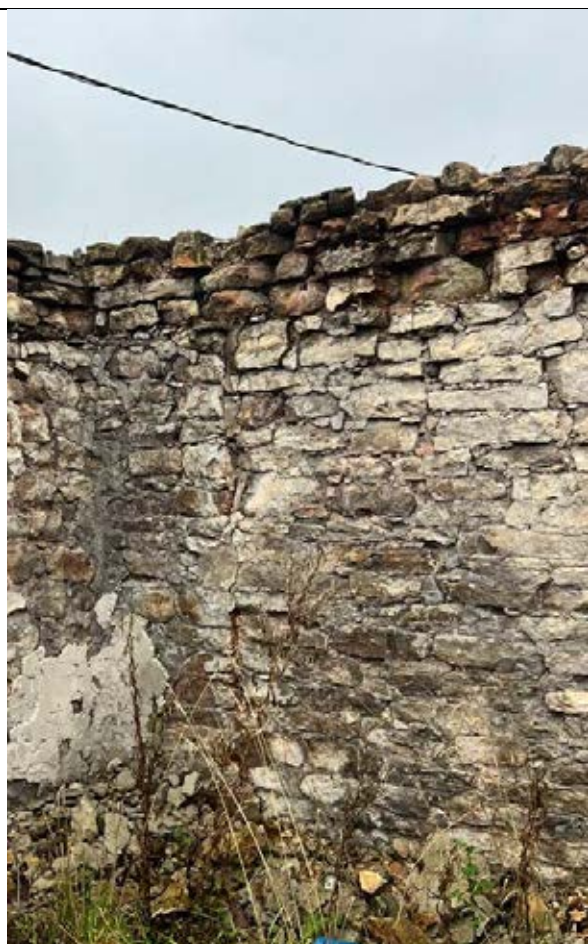
Фото №18. Размывание кладочных швов в стене южной пристройки
