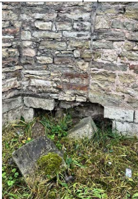
Фото №28. Разрушение кладки стены западной пристройки
