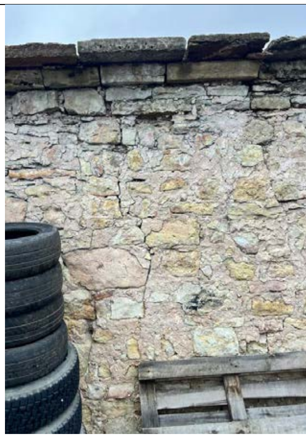
Фото №30. Вертикальная трещина раскрытием до 7 мм в стене южной пристройки
