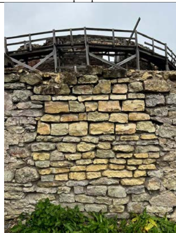
Фото №32. Вымывание кладочного шва из наружной стены
