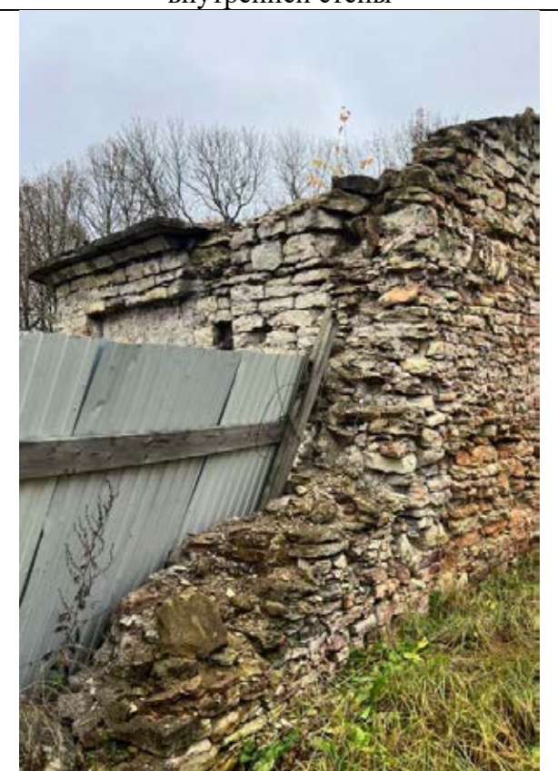
Фото №16 Разрушение части наружной стены
