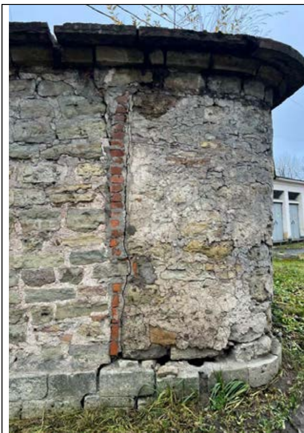
Фото №29. Вертикальная трещина раскрытием до 5 мм и разрушение кладки стены западной пристройки
