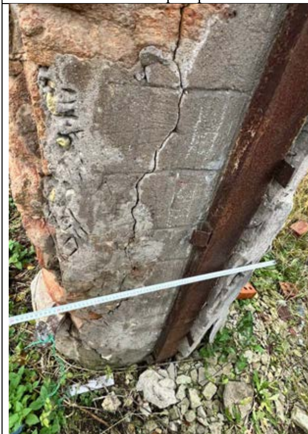
Фото №23. Трещина раскрытием до 5 мм в проеме восточной пристройки
