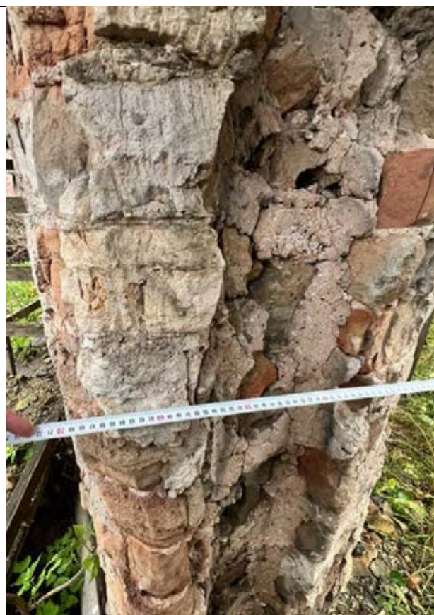
Фото №14 Разрушение кладки проема внутренней стены
