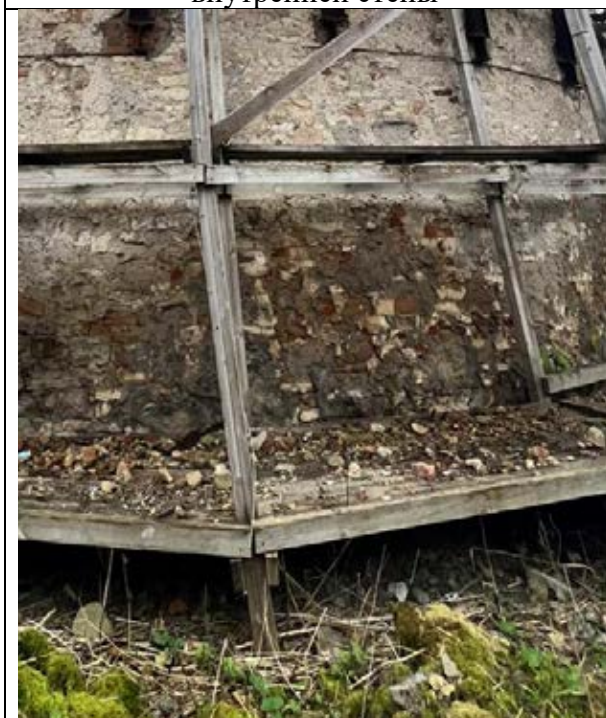
Фото №11 Намокание кладки внутренней стены
