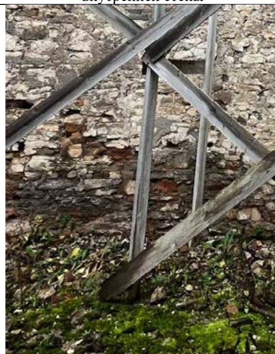
Фото №12 Намокание кладки внутренней стены
