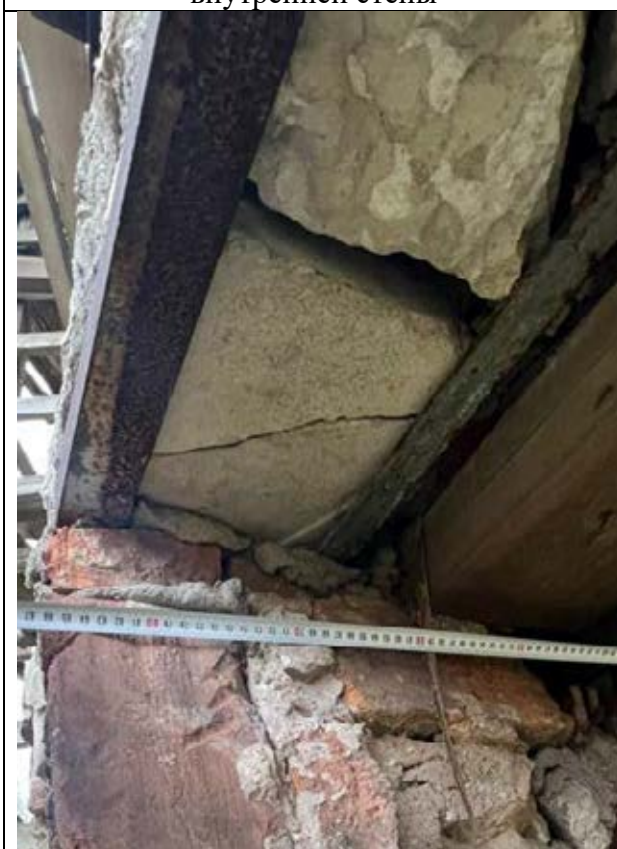
Фото №15 Разрушение камней кладки проема внутренней стены
