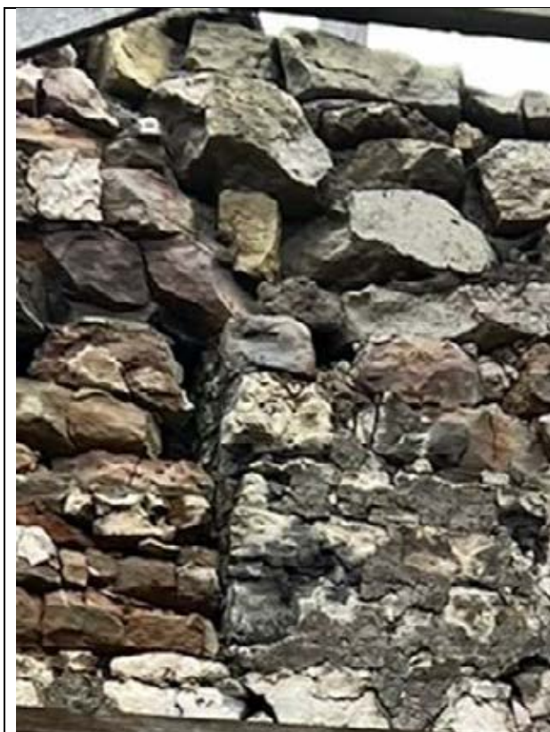
Фото №9 Вымывание кладочных швов внутренней стены
