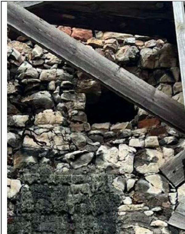
Фото №1 Нарушение целостности кладки внутренней стены
