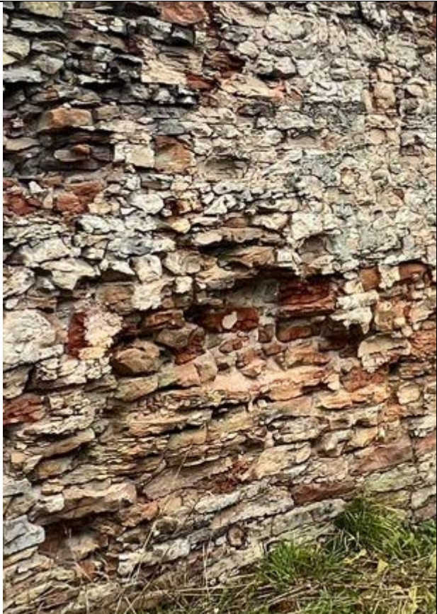
Фото №34. Нарушение целостности кладки наружной стены
