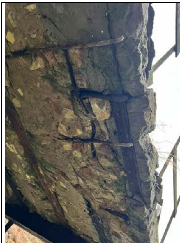
Фото №25. Оголение и коррозия армирования плиты балкона
