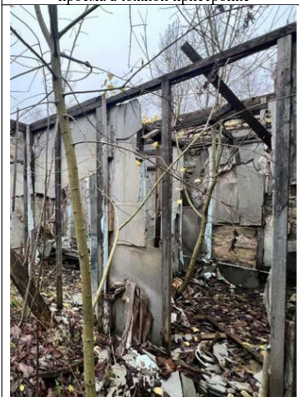
Фото №19. Разрушенные перегородки и строительный мусор в западной пристройке
