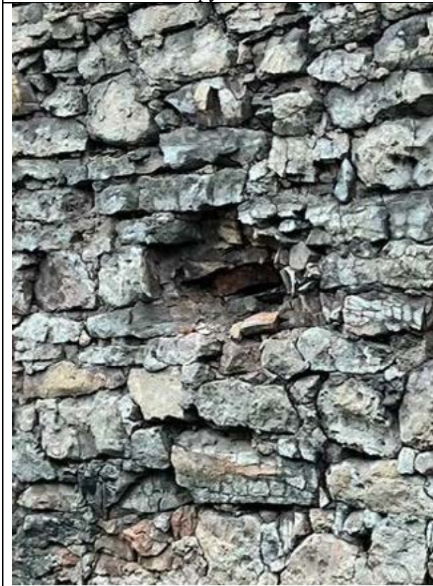
Фото №35. Нарушение целостности кладки наружной стены
