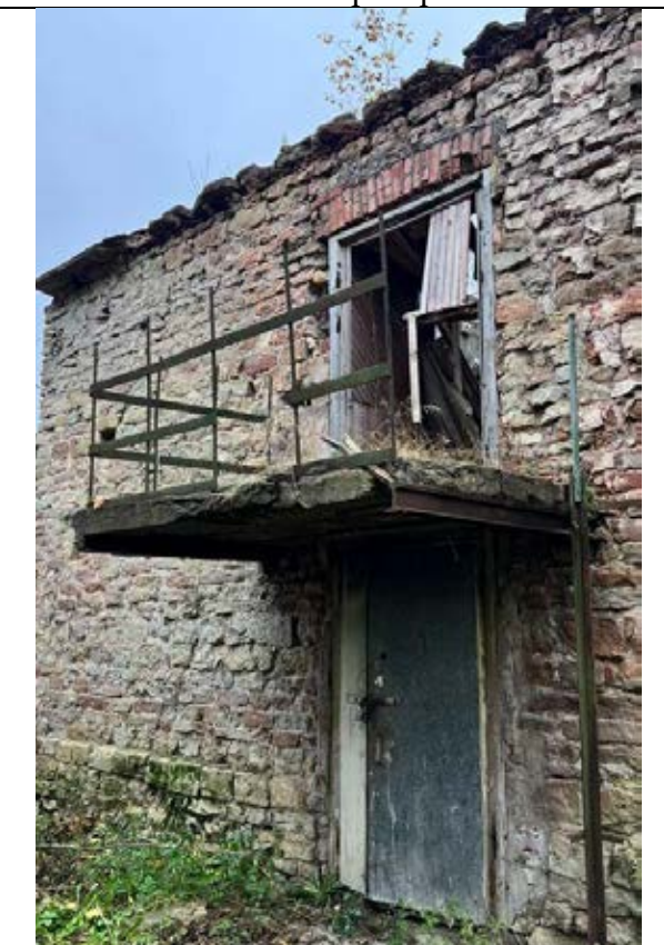
Фото №24 Разрушение защитного слоя бетона балкона юго-восточной пристройки
