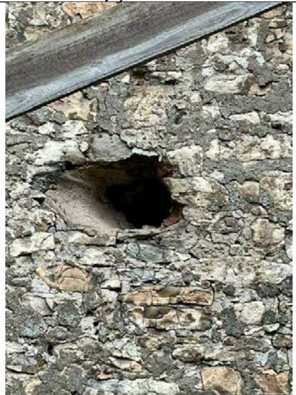
Фото №4 Нарушение целостности кладки внутренней стены
