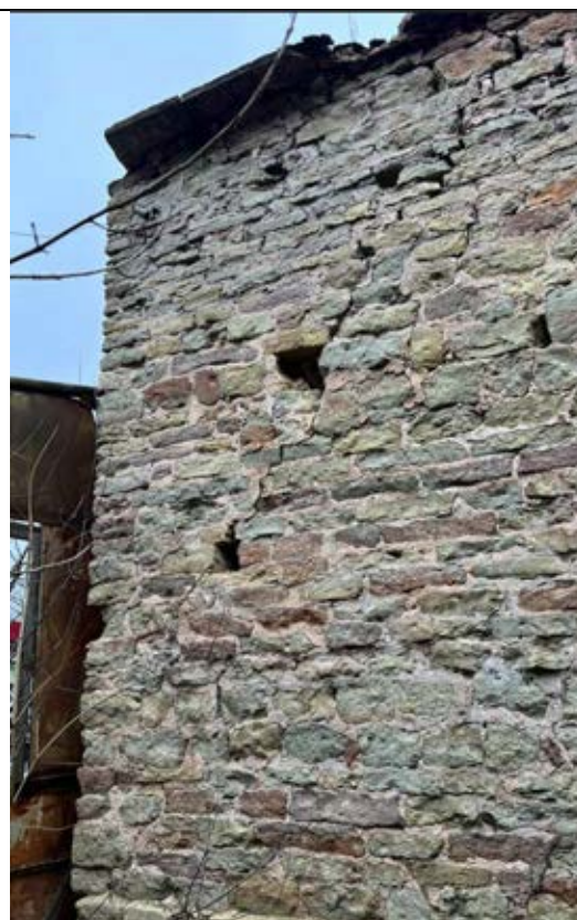
Фото №26. Наклонная трещина в стене юго-восточной пристройки
