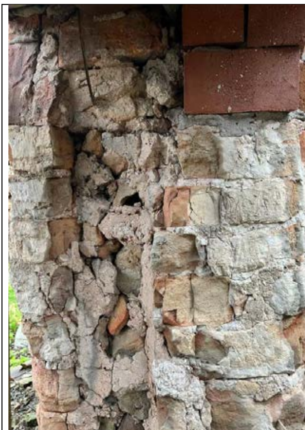
Фото №13 Разрушение кладки проема внутренней стены
