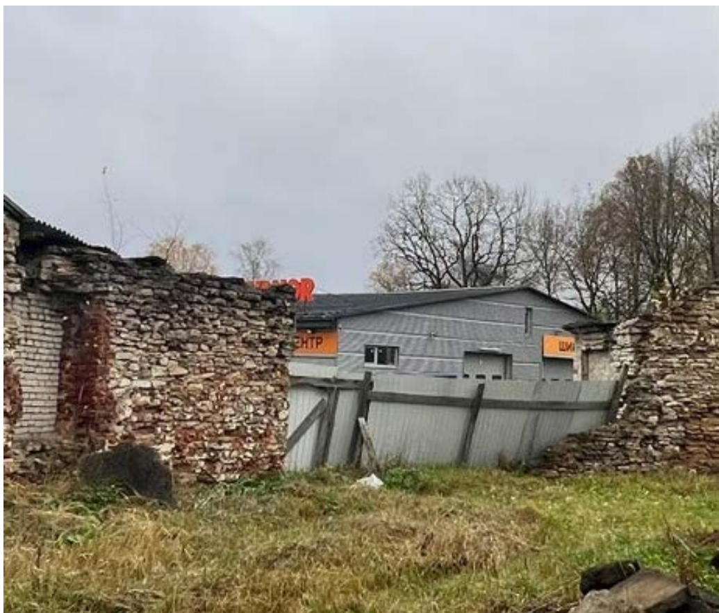
Фото Б.7 – Разрушенный участок наружной
