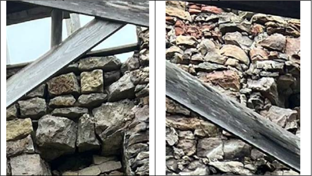
Фото №7 Вымывание кладочных швов внутренней стены
