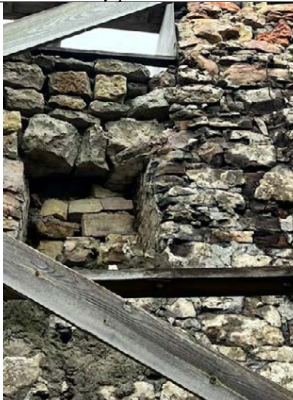
Фото №3 Нарушение целостности кладки внутренней стены
