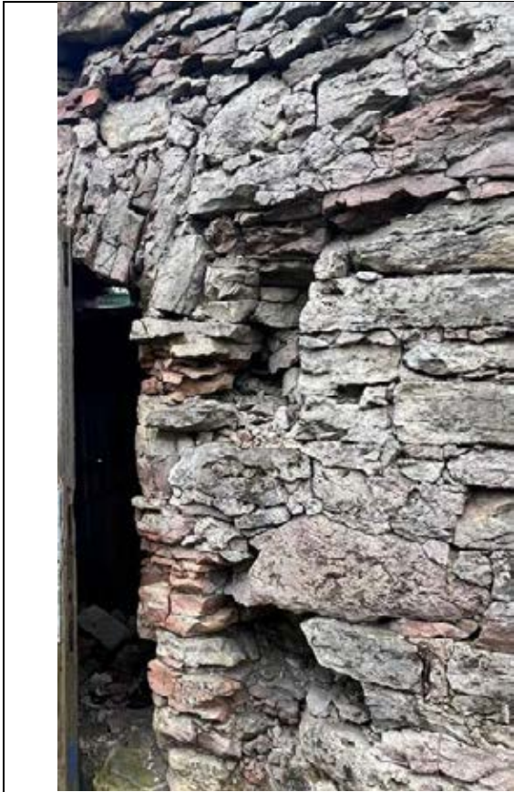
Фото №33. Нарушение целостности кладки наружной стены
