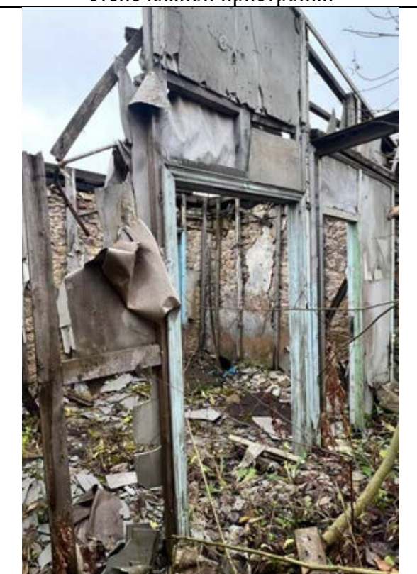
Фото №20. Разрушенные перегородки и строительный мусор в западной пристройке
