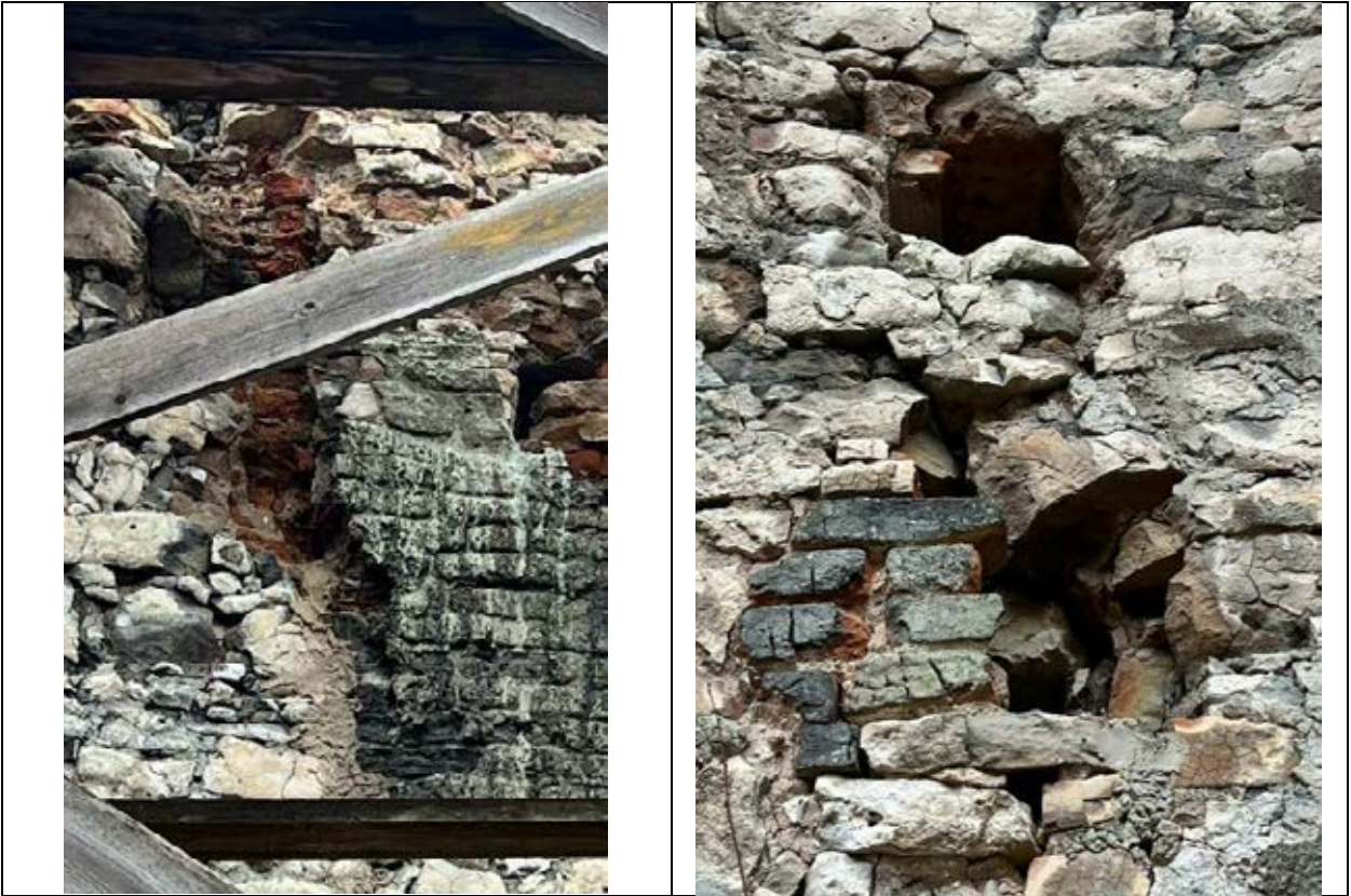
Фото №5 Нарушение целостности кладки внутренней стены
