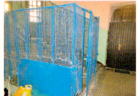
Ограждение лифтовой шахты. ЛК-7
