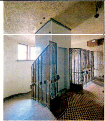
Ограждение лифтовой шахты ЛК-1
