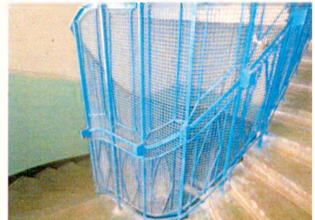
Ограждение лифтовой шахты. ЛК-7
