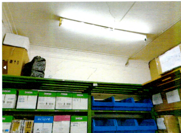
Вид на галтель в пом.20
