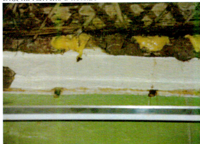
Вид на галтель в пом.8
