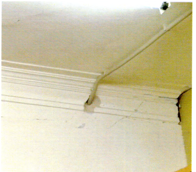
Вид на галтель в пом. 20
