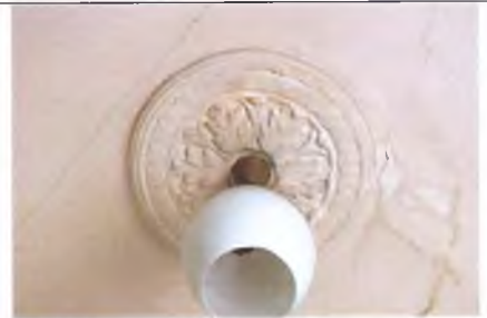
Потолочная розетка (пом. 1.1, 2.2, 2.3, 2.10, 2.13)
