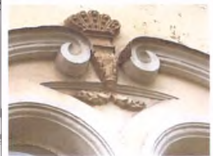
Центральная часть сандрика проемов Ю-3 лицевого фасада, 2-ой ярус (ризалиты), фото 2006 г.
