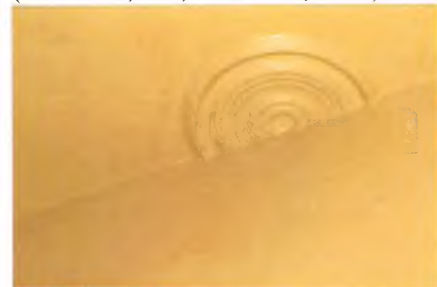
Потолочная розетка (пом. 1.5)
