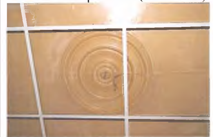
Потолочная розетка (пом. 1.13)
