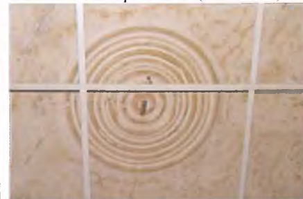
Потолочная розетка (пом. 1.12)
