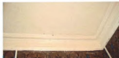
тянутый карниз по периметру
