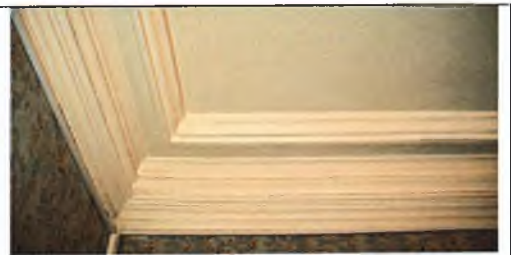
тянутый карниз по периметру
