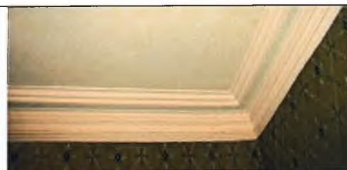
тянутый карниз по периметру
