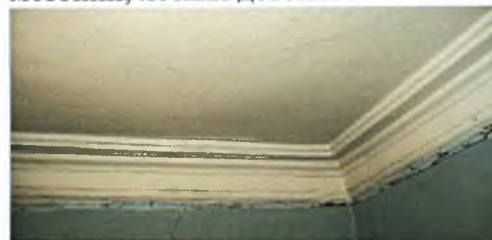
тянутый карниз по периметру
