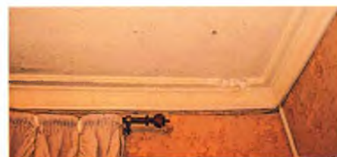
тянутый карниз по периметру
