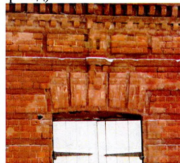
Рустованные лучковые сандрики с фигурными замковыми камнями (южный, восточный и западный фасады)
