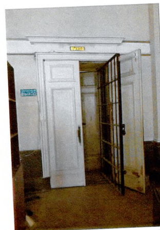
Двери между пом. 1.5 и ЛК-2
