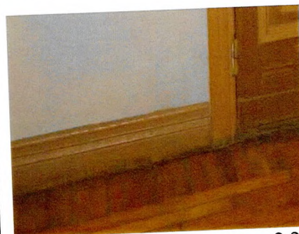
Деревянный плинтус, пом. 2.2
