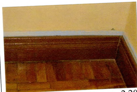
Деревянный плинтус, пом. 2.20
