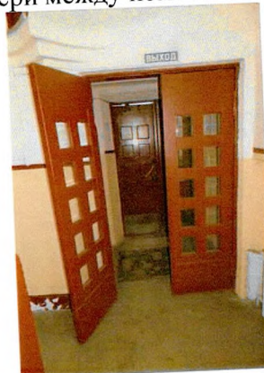
Двери между пом. 1.6 и ЛК-1
