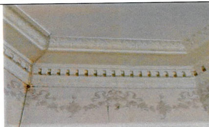
Карниз потолка (пом. 2.16)
