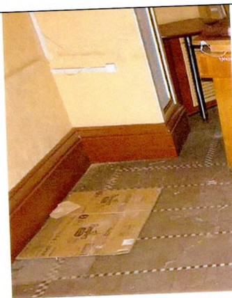
Деревянный плинтус, пом. 1.3
