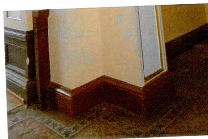
Деревянный плинтус, пом. 1.5
