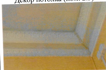
Карниз потолка (пом. 2.13)
