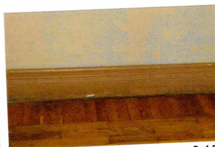
Деревянный плинтус, пом. 2.17
