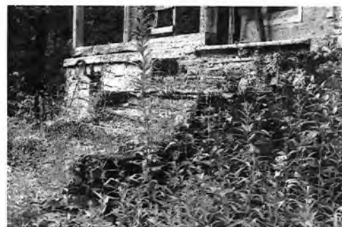
Крыльцо входа на террасу (руинировано)
