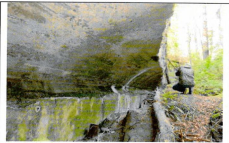
Фрагмент разрушенной конструкции потерны
