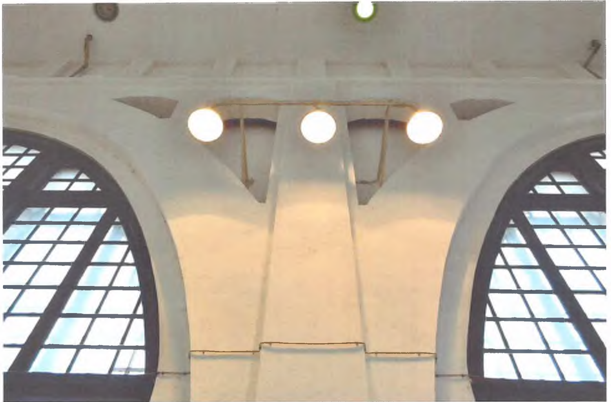
Фото 29. Ленинградская область, г. Волхов, Волховская ГЭС. Первый этаж. Фермы машинного зала. Вид с северо-запада.
