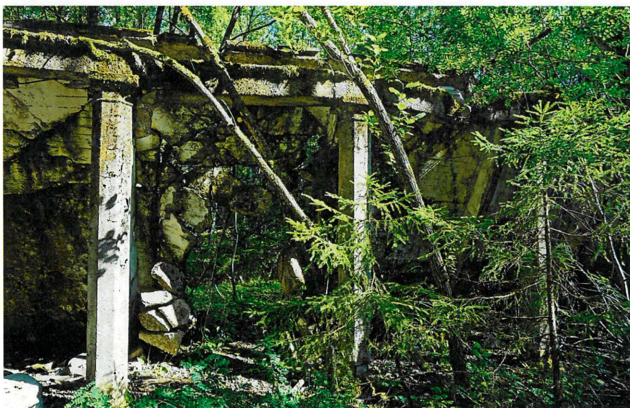
Фото 3. Части разрушенной постройки рядом с фрагментом цоколя. Вид с юго-запада
