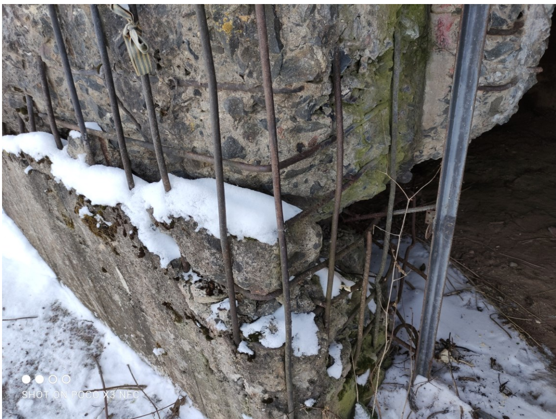
Фото 4. Разрушенная часть стены ДОТа.
