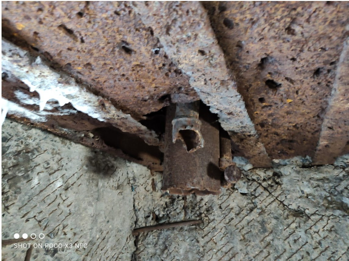
Фото 5. Перекрытие ДОТа. Металлические элементы находятся в неудовлетворительном состоянии.
