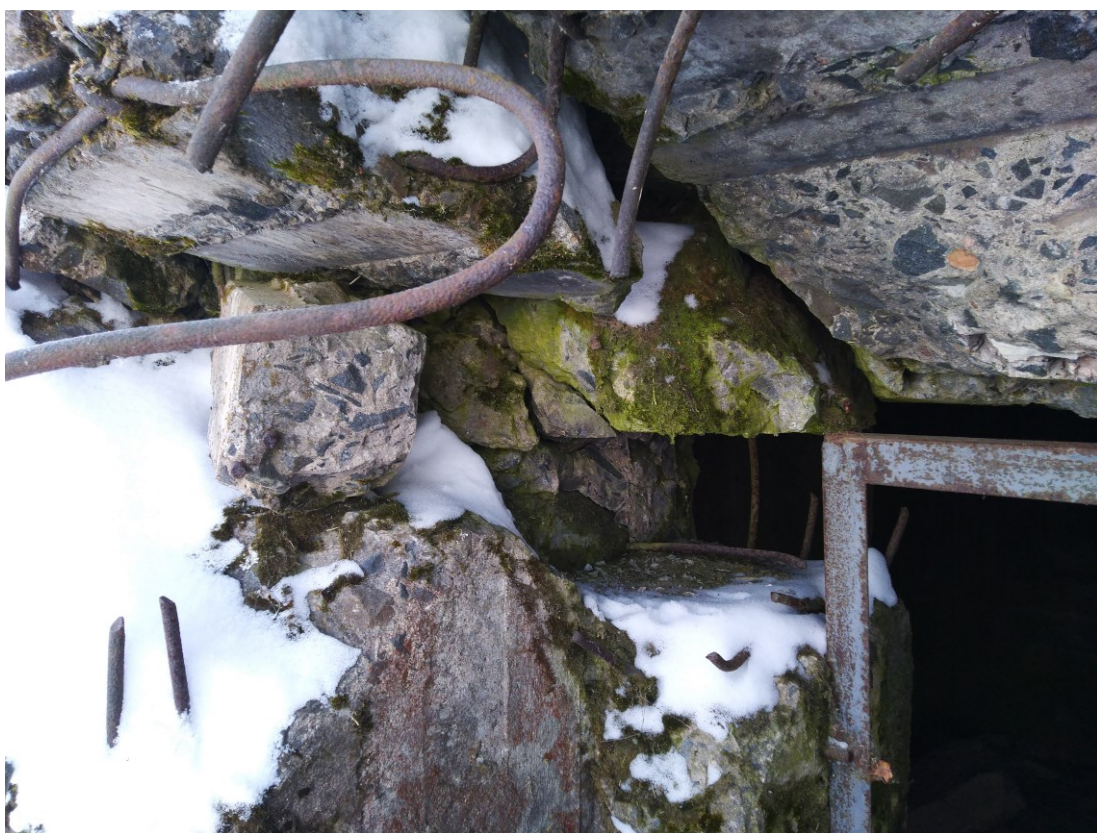
Фото 4. Трещина в стене ДОТа. 10.12.2021.
