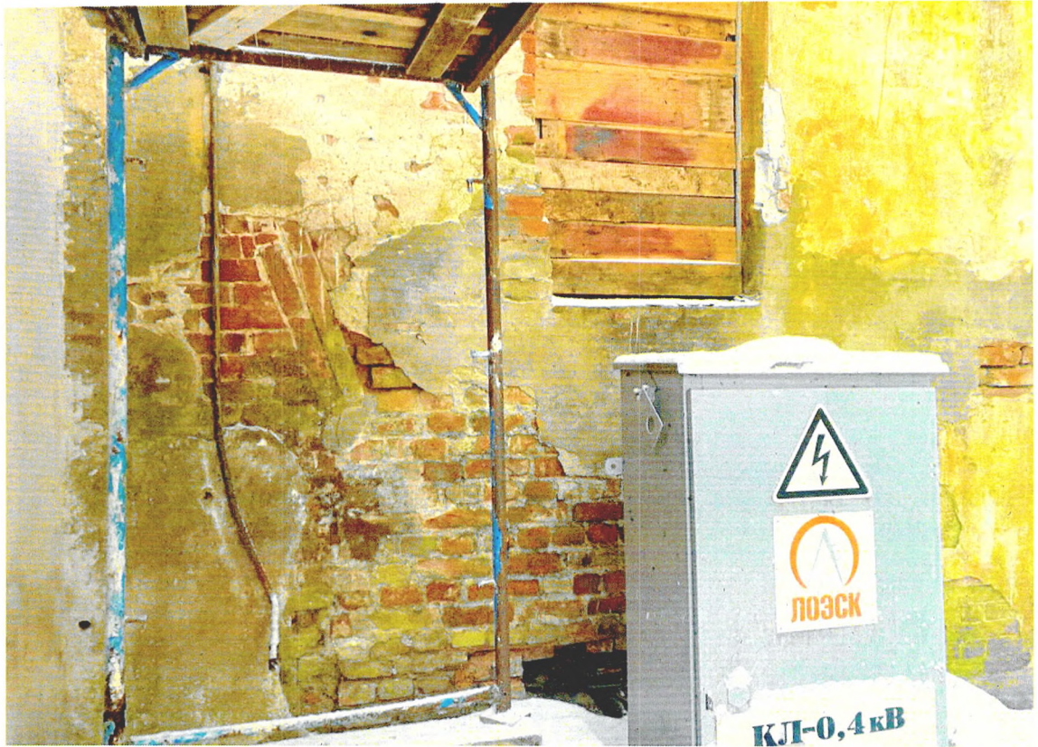
Фото 4. «Дом жилой купеческий» стена дворового фасада 24.01.2023г.
