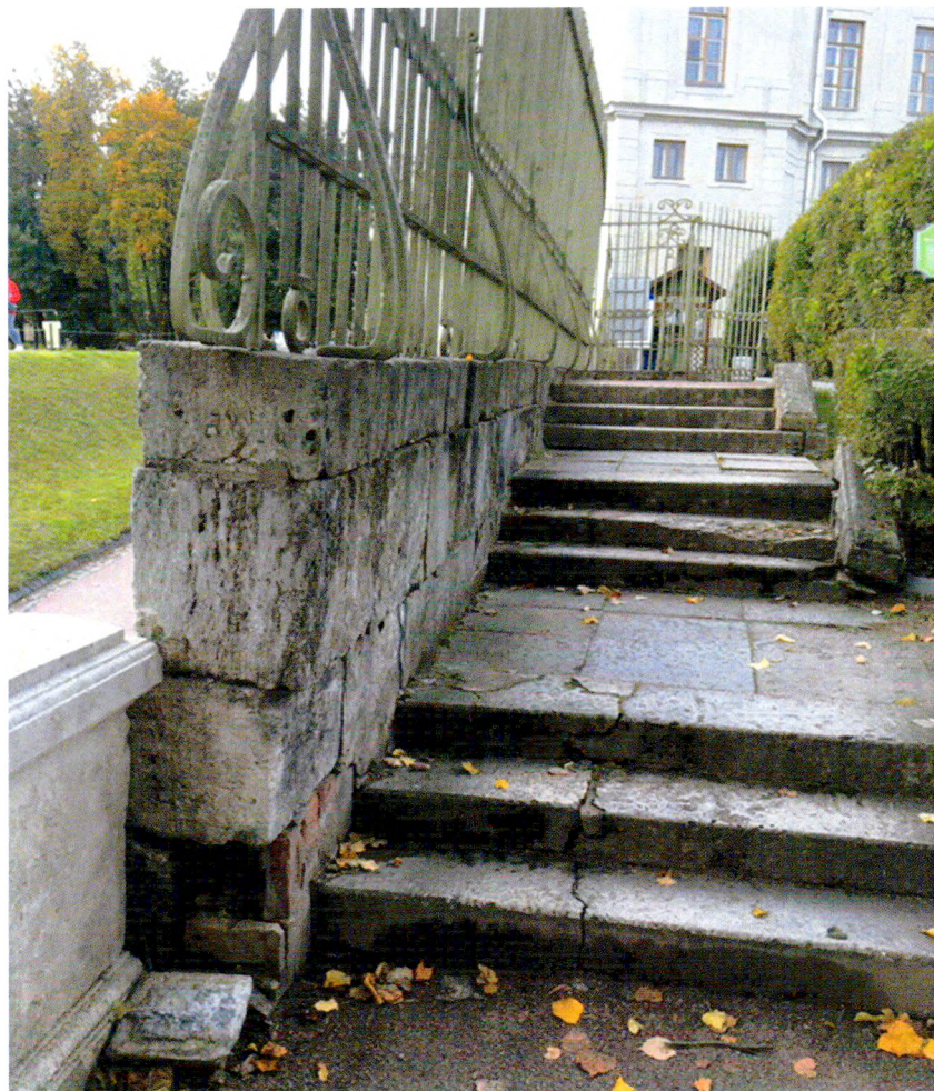
Фото 4. «Терраса Собственного садика и металлическая ограда». Состояние каменной подпорной стенки и каменной лестницы.
