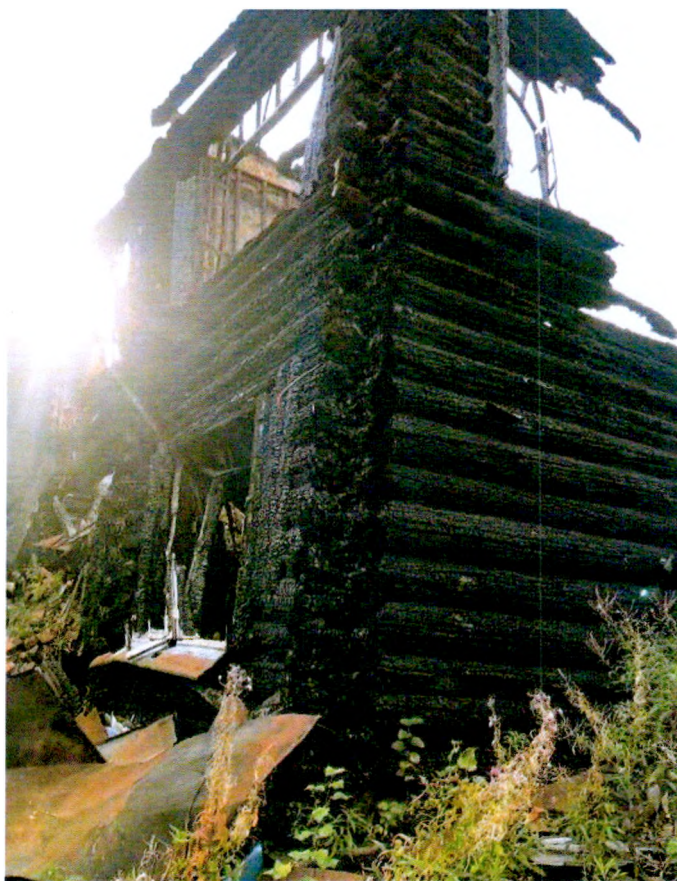
Фото 5. «Главный дом» деревянная часть здания после пожара.
