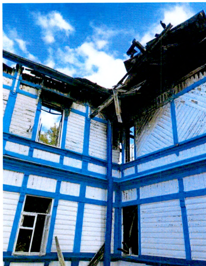
Фото 12. «Главный дом» сохранившаяся часть здания после пожара южный фасад.
