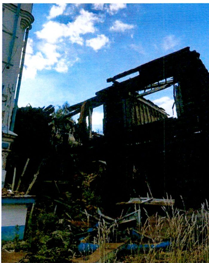
Фото 3. «Главный дом» часть здания после пожара.
