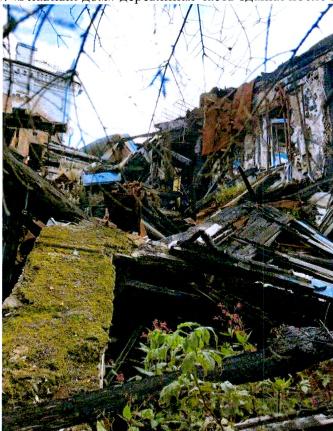
Фото 7. «Главный дом» деревянная часть здания после пожара.
