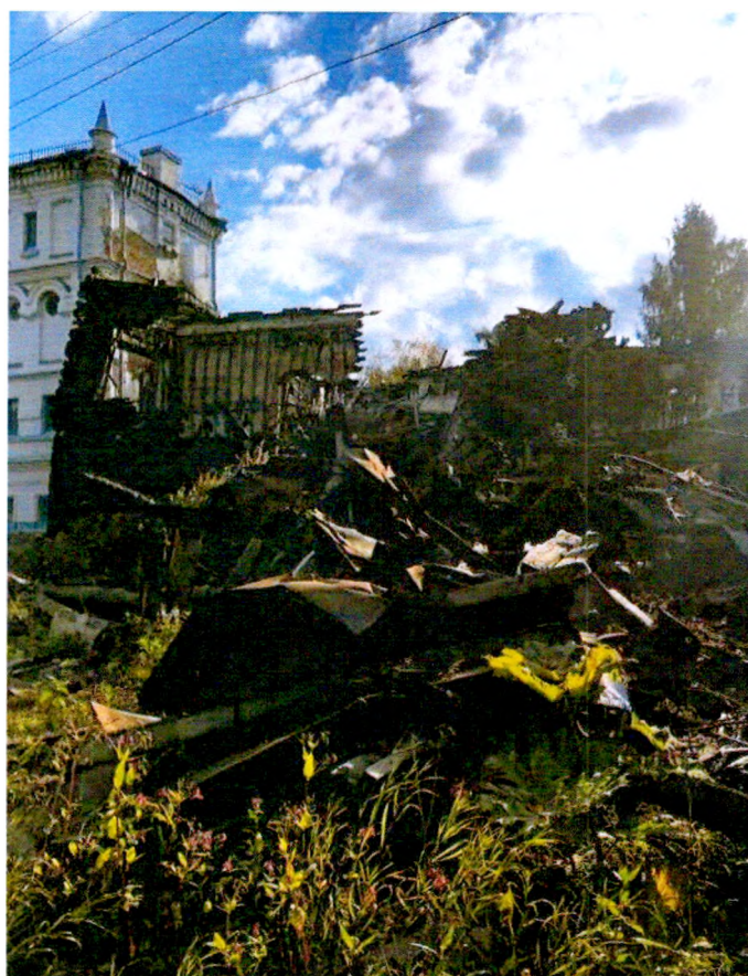
Фото 6. «Главный дом» деревянная часть здания после пожара.
