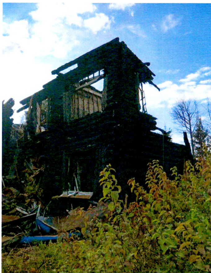
Фото 4. «Главный дом» деревянная часть здания после пожара.
