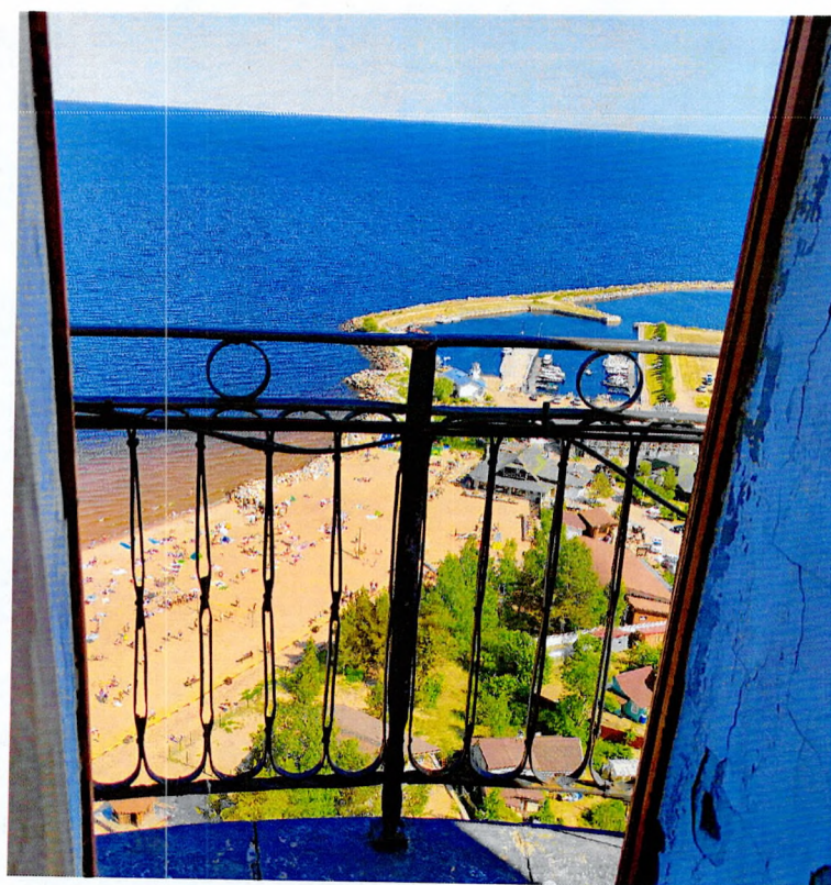
Фото 13. «Осиновецкий маяк» перильное ограждение верхнего яруса, на металлическом ограждении наблюдаются утраты, частичное отслоение лакокрасочного покрытия.
