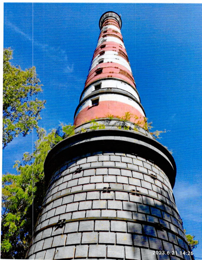
Фото 3. «Асиновецкий маяк» общий вид западного фасада сооружения, сорная растительность на цоколе.
