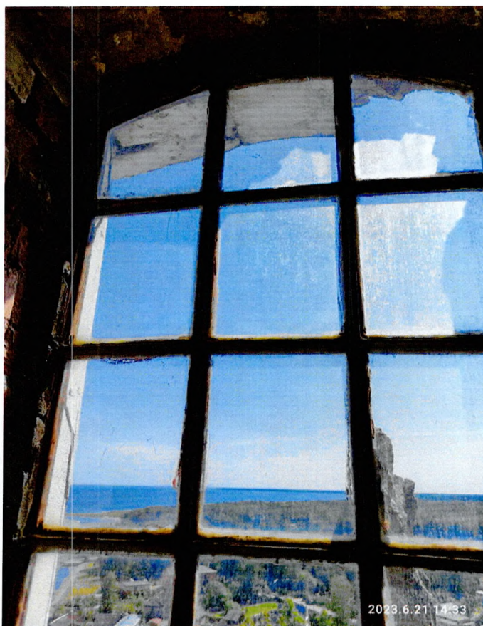
Фото 12. «Осиновецкий маяк» оконное заполнение в основном объёме сооружения, наблюдается расслоение оконной замазки.
