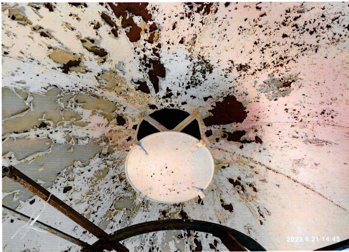
Фото 10. «Осиновецкий маяк» металлический купол сооружения, наблюдается отслоение лакокрасочного покрытия.
