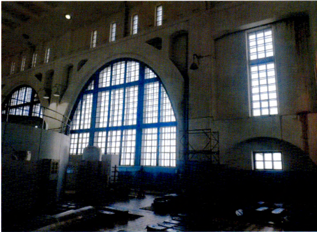
Фото 31. Ленинградская область, г. Волхов, Волховская ГЭС. Первый этаж. Фермы машинного зала. Вид с северо-запада.
