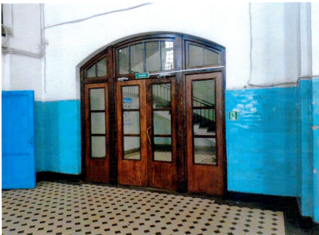
Фото 29. Волховская ГЭС. Первый этаж. Историческая дверь в машинный зал. Вид с юго-востока.
