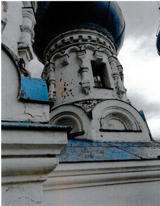
Фото 10. «Церковь Егерской слободки». Трещины в штукатурном слое на главках.
