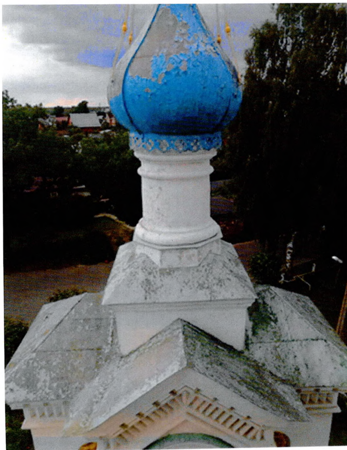
Фото 11. Отслоение лакокрасочных материалов от металлической кровли.
