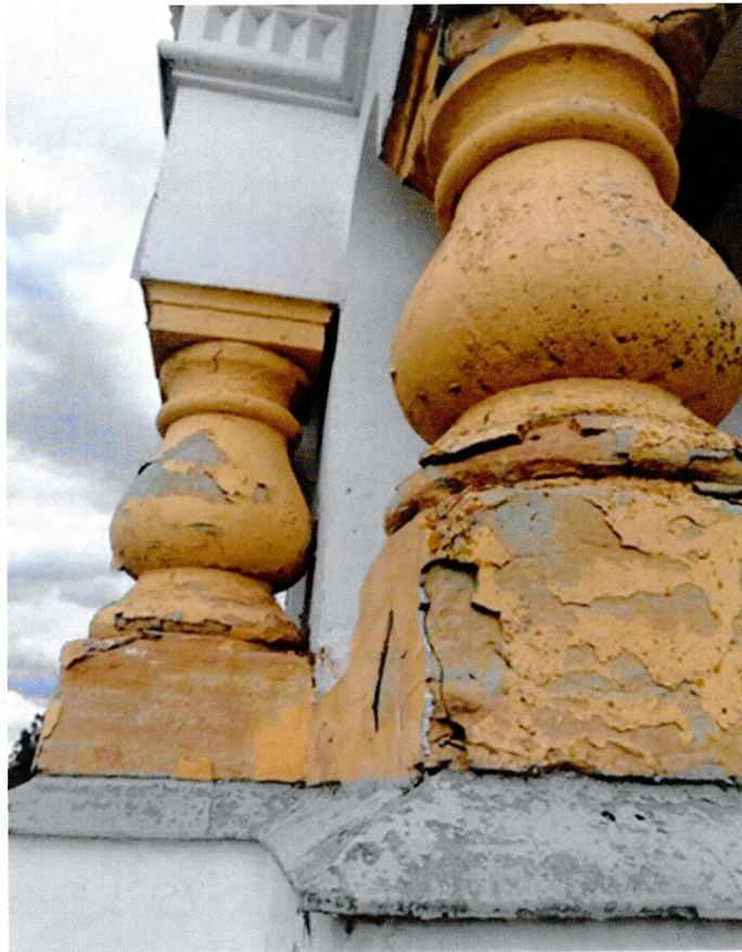
Фото 12. «Церковь Егерской слободки». Трещины в штукатурном слое на главках.
