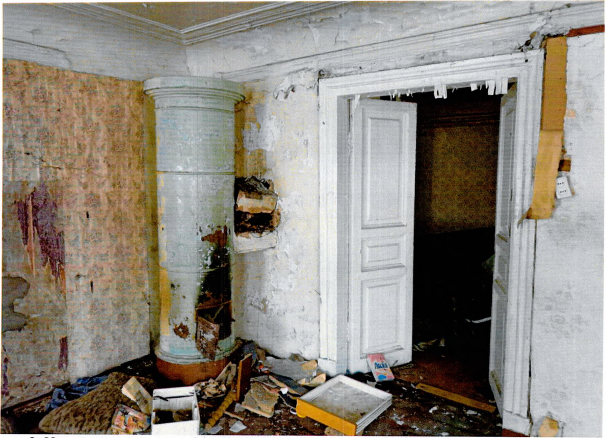
Фото 9. Интерьер помещения 2 этажа. Круглая металлическая печь, деревянные филенчатые двери, тянутый профилированный штукатурный карниз.
