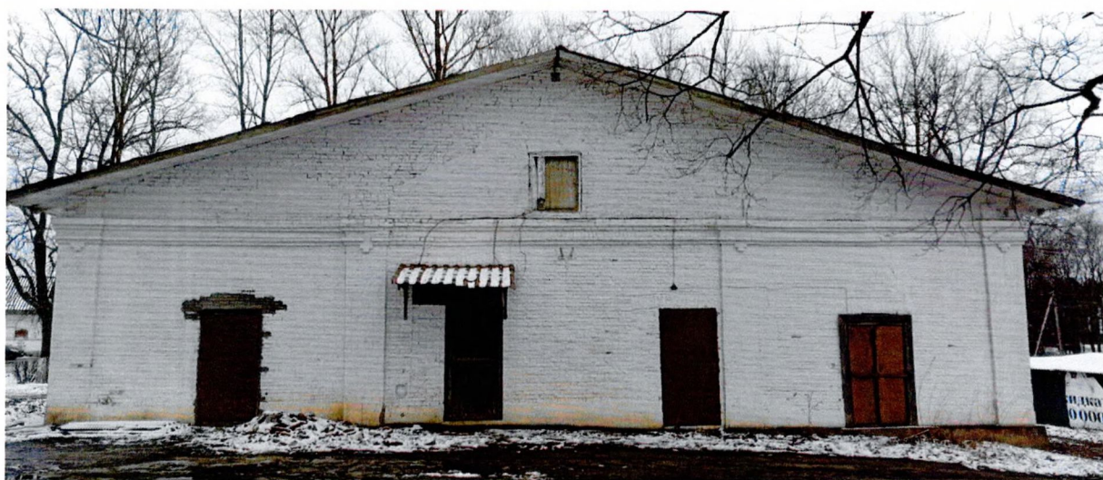
Фото 1. Общий вид западного фасада. Наружные стены кирпичные. Поверхность фасада – кирпичная кладка с покраской. Декор в виде профилированного карниза и четырех пилястр.
