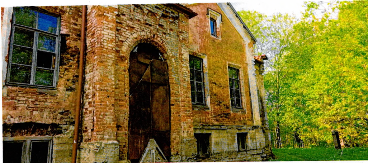
Фото 3. Вид на главный вход северного фасада. Дверной проем – арочный. Наблюдаются значительные следы намокания и деструкции кирпичной кладки и вывалы отдельных кирпичей.
