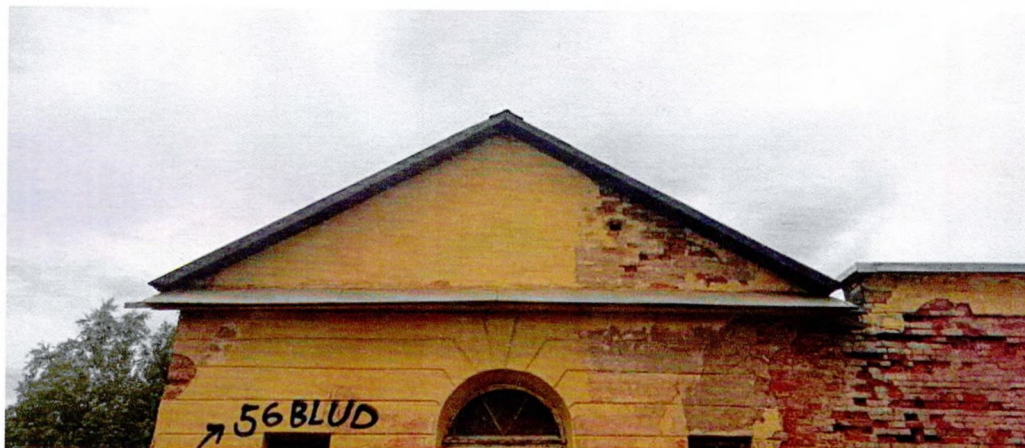
ФОТО 6. Вид на фронтон левого флигеля. Наблюдается утрата штукатурного слоя.
