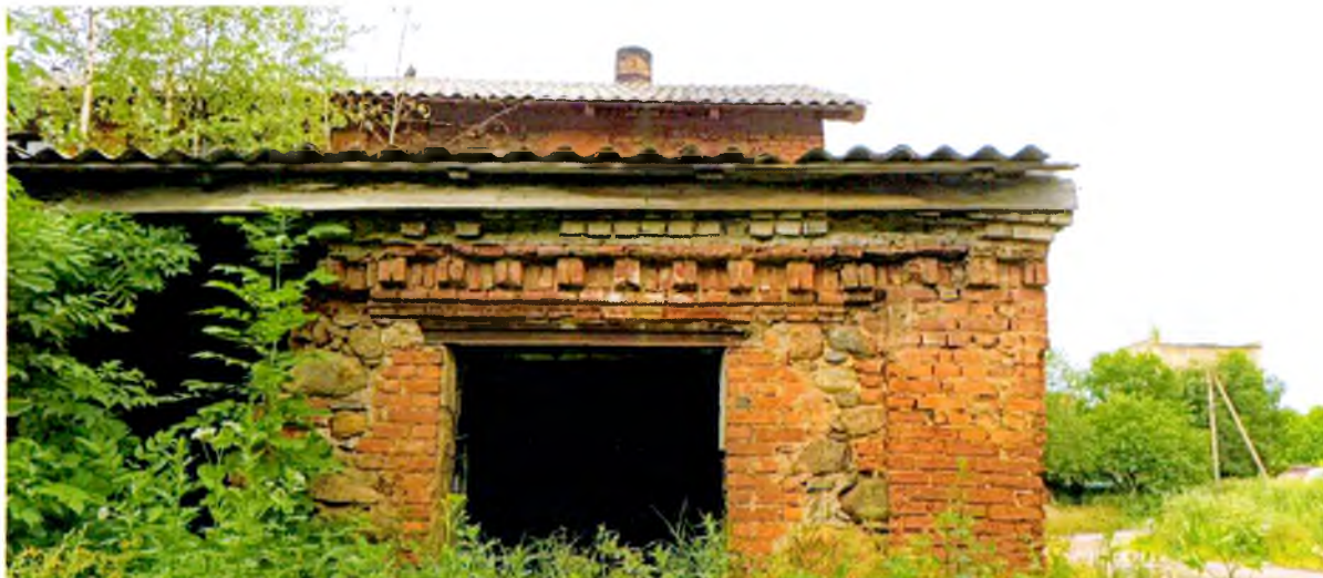
ФОТО 3. Фрагмент западного фасада. Часть кладки наружных стен выполнена из гранитных валунов на связующем известковом растворе, часть стен представляет собой кирпичную кладку.
