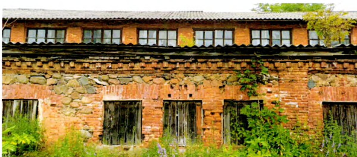
ФОТО 1. Фрагмент восточного фасада. Часть кладки наружных стен выполнена из гранитных валунов на связующем известковом растворе, часть стен представляет собой кирпичную кладку, прямоугольные оконные проемы имеют клинчатую кирпичную перемычку.
