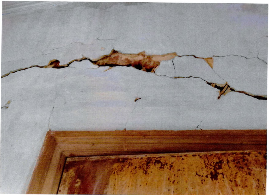
Фото 18. «Церковь Преображенья», трещины в штукатурки и кирпичной кладки над дверным проёмом в колокольне.
