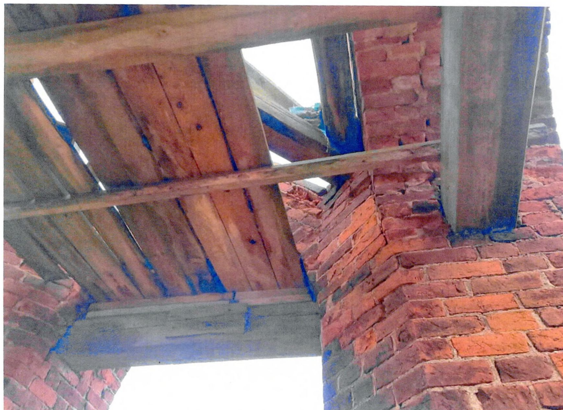
Фото 35. «Церковь Преображенья», сохранившиеся деревянные конструкции на ярусе звона колокольни.
