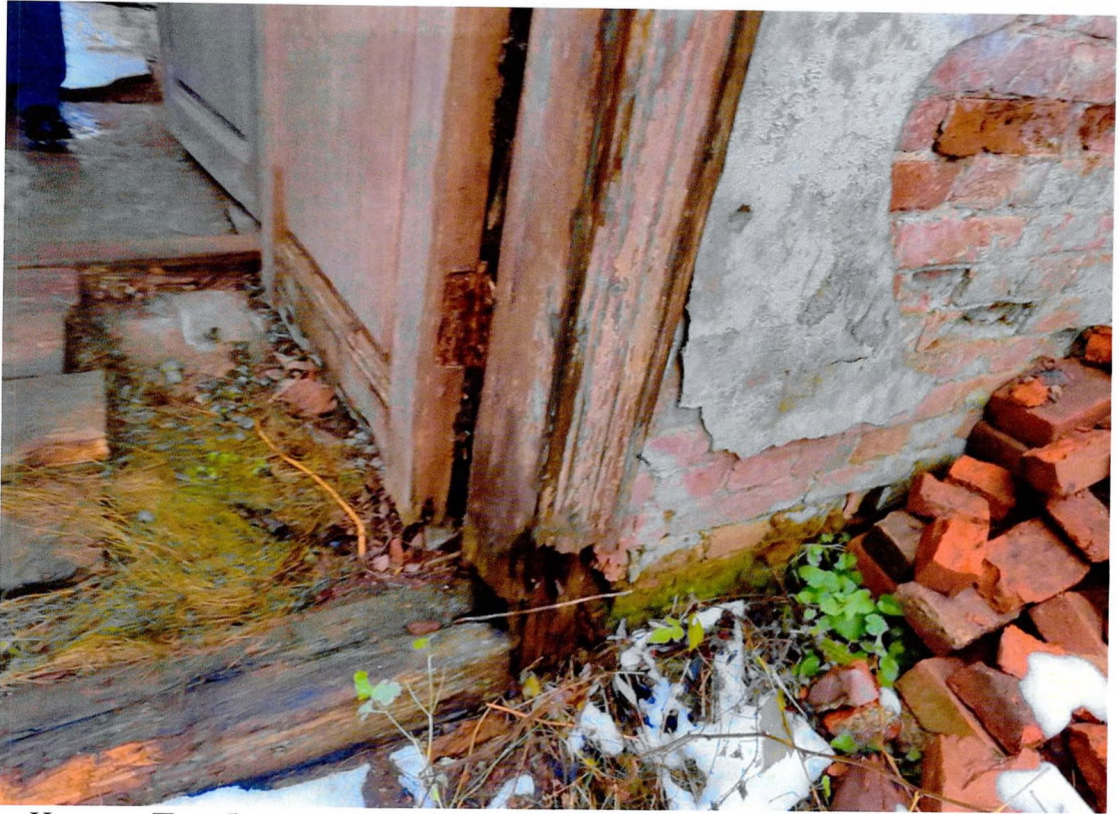
Фото 28. «Церковь Преображенья», прогнившие деревянные дверные заполнения внутри здания.
