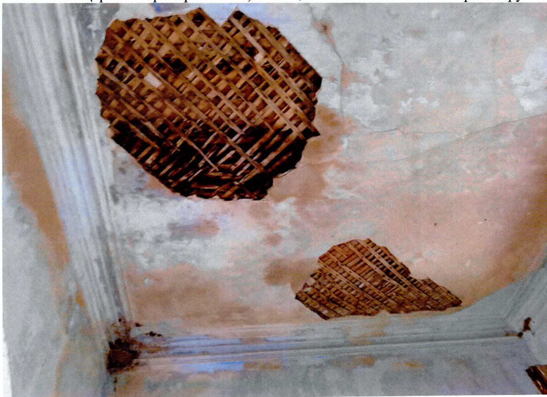
Фото 17. «Церковь Преображенья», протечки в перекрытии первого яруса, отслоения штукатурки вызванные от протечек.
