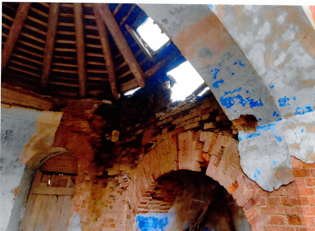
Фото 24. «Церковь Преображенья», кирпичная кладка апсиды деформирована, зафиксированы вывалы.
