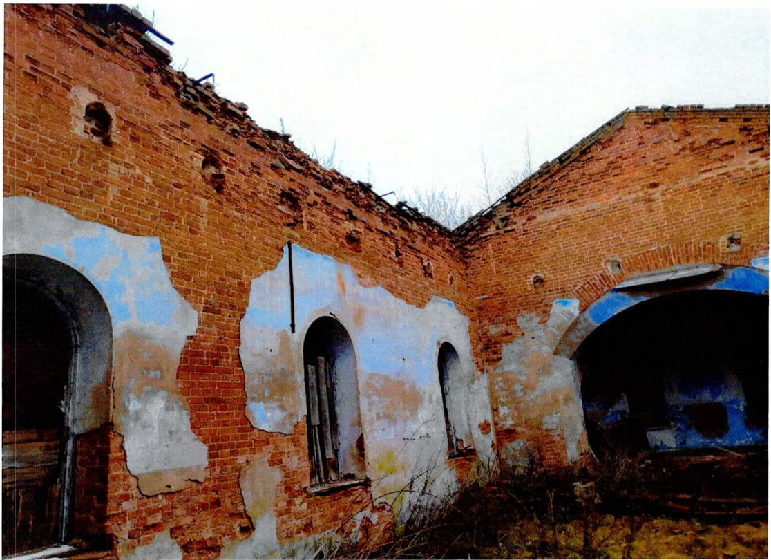
Фото 20. «Церковь Преображенья», деструкция кирпичной кладки и осыпание венчающего карниза.
