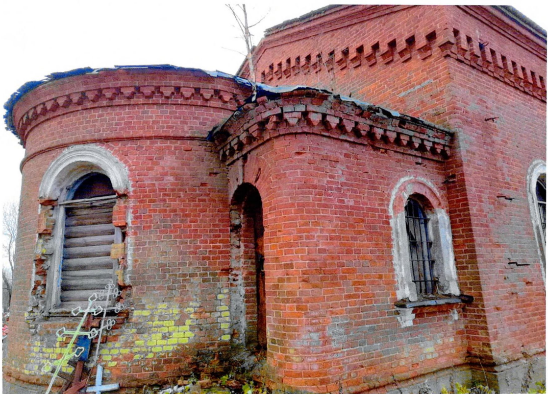
Фото 7. «Церковь Преображенья», служебный вход со стороны апсиды здания, следы биопоражений на кирпичной кладки.
