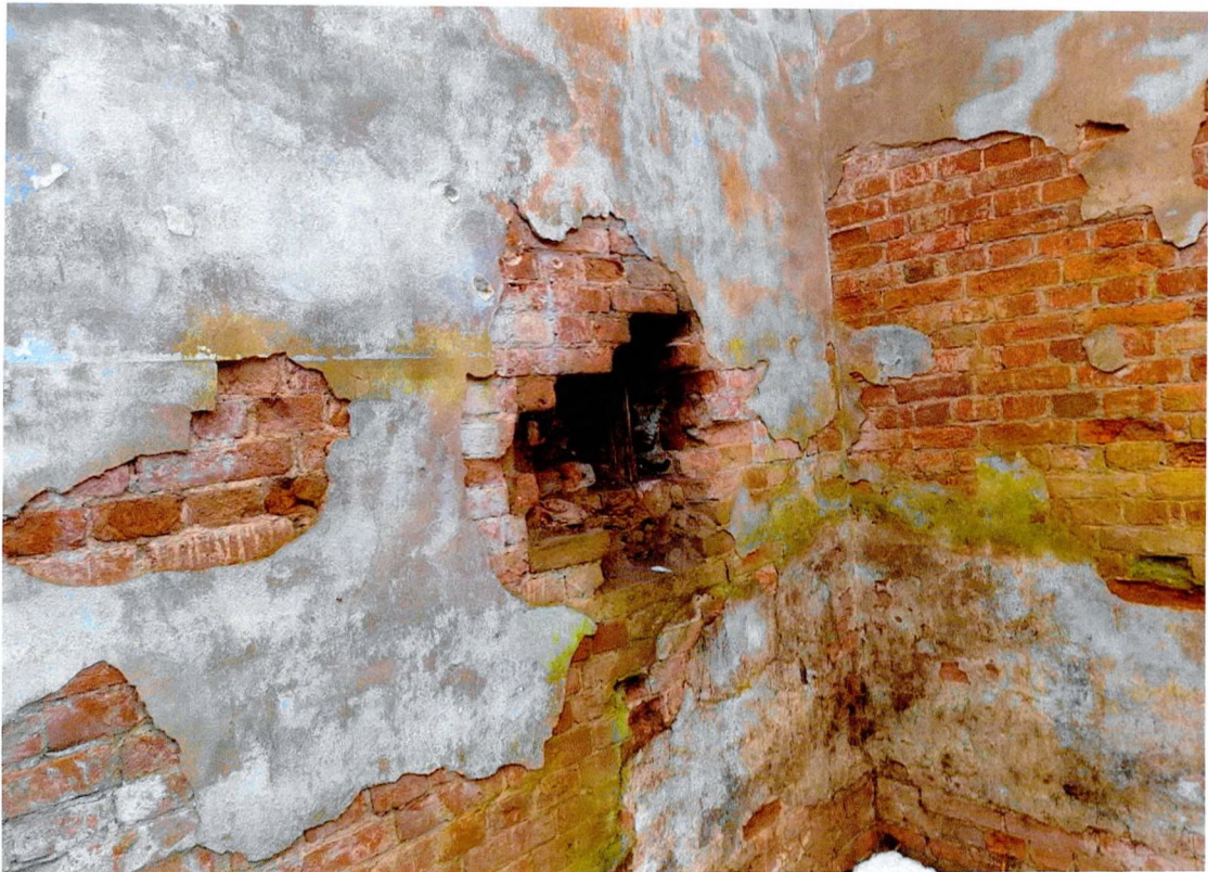
Фото 29. «Церковь Преображенья», дымовая труба устроенная в стене здания.
