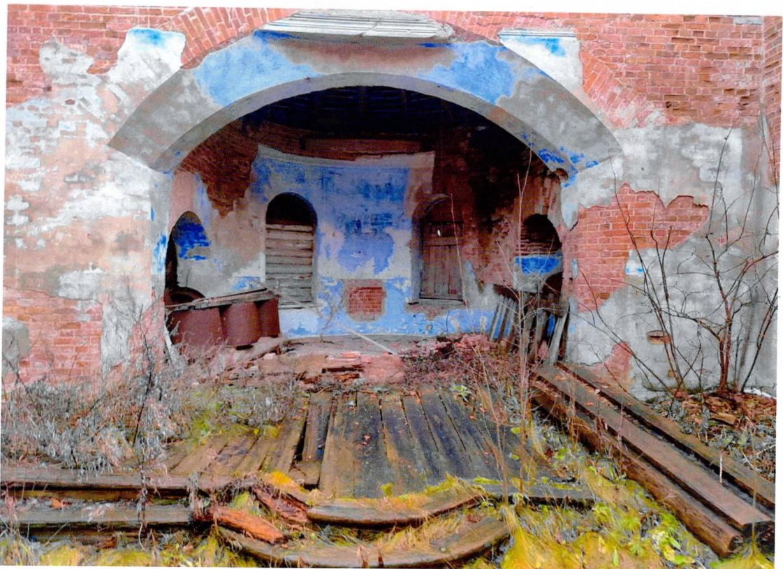
Фото 22. «Церковь Преображенья», апсида, деревянные половицы деструктивированы, находятся в аварийном состоянии.
