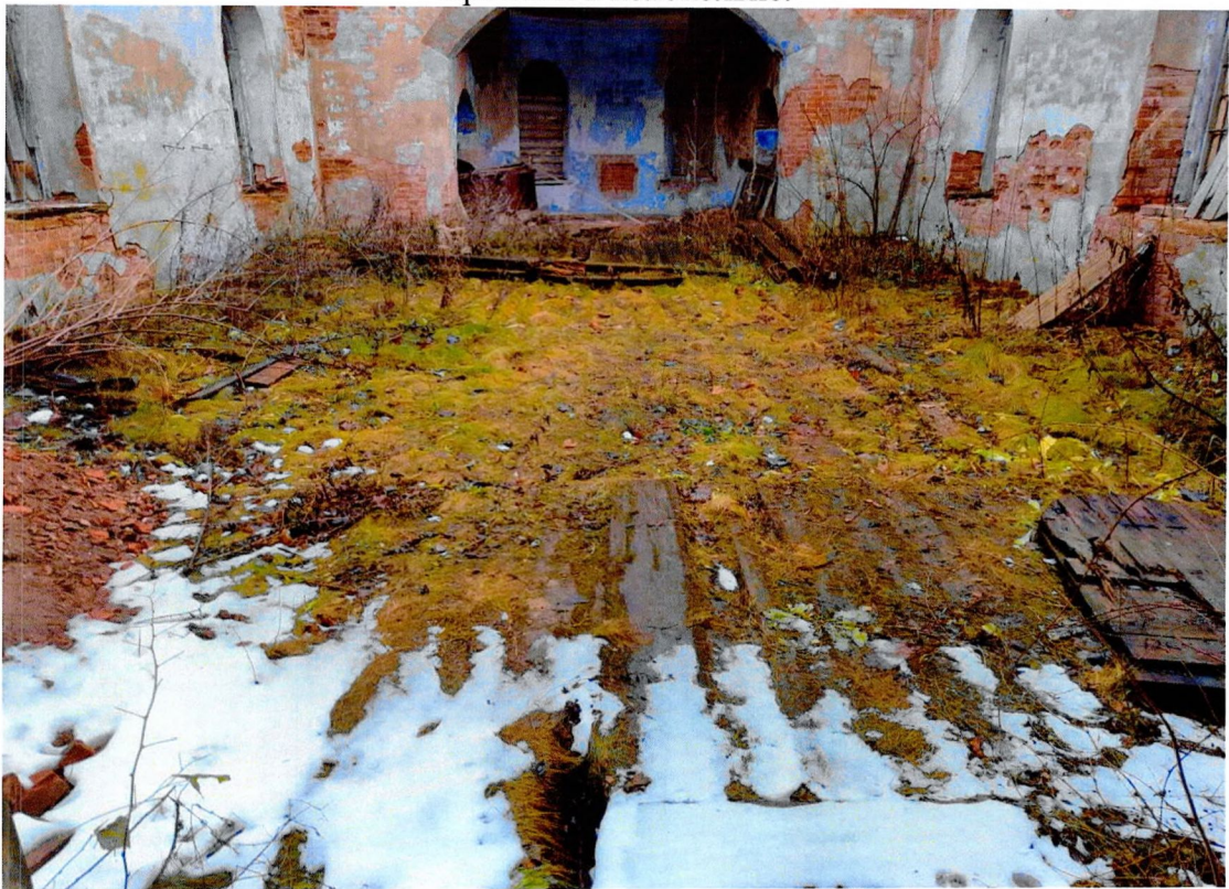
Фото 19. «Церковь Преображенья», помещение в основном объеме здания, половые доски прогнили, наблюдаются осыпания штукатурки и кирпича со стен, произрастает сорная растительность.
