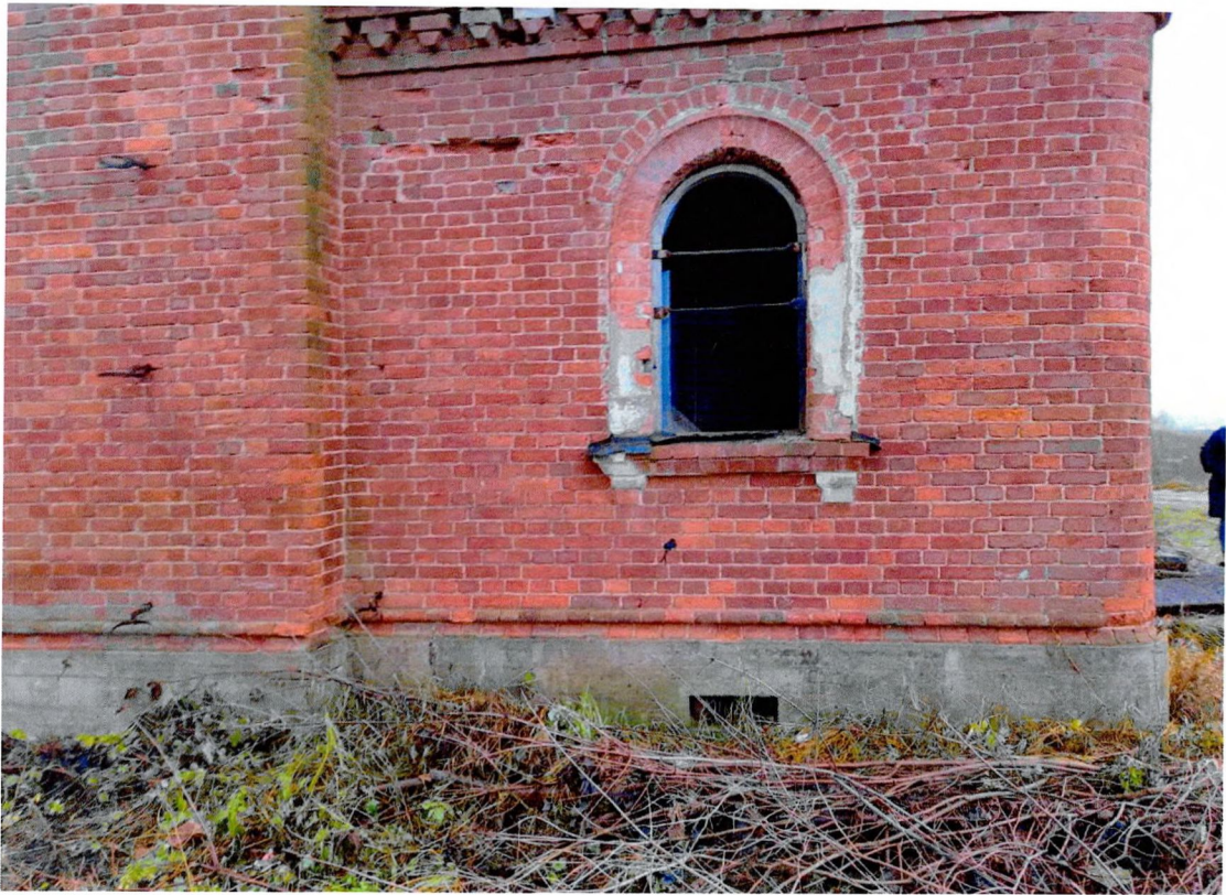
Фото 4. «Церковь Преображенья», отсутствует решетка и оконное заполнение в помещении колокольни.
