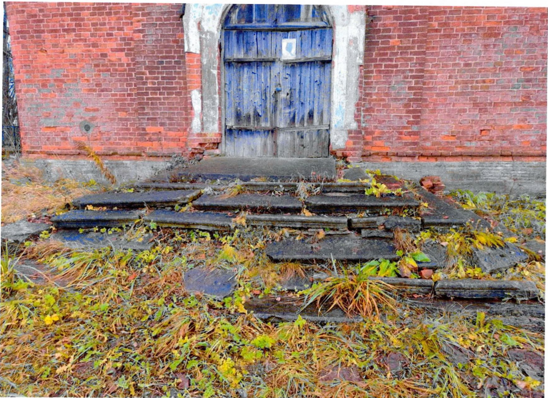
Фото 2. «Церковь Преображенья», каменная лестница у центрального входа в здание, известняковые ступени смещены, имеют множественные сколы, трещины и расслоения по пластам.
