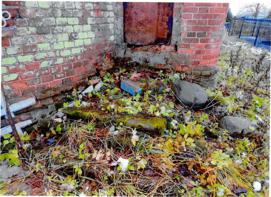
Фото 8. «Церковь Преображенья», разрушенная каменная лестница служебного входа.
