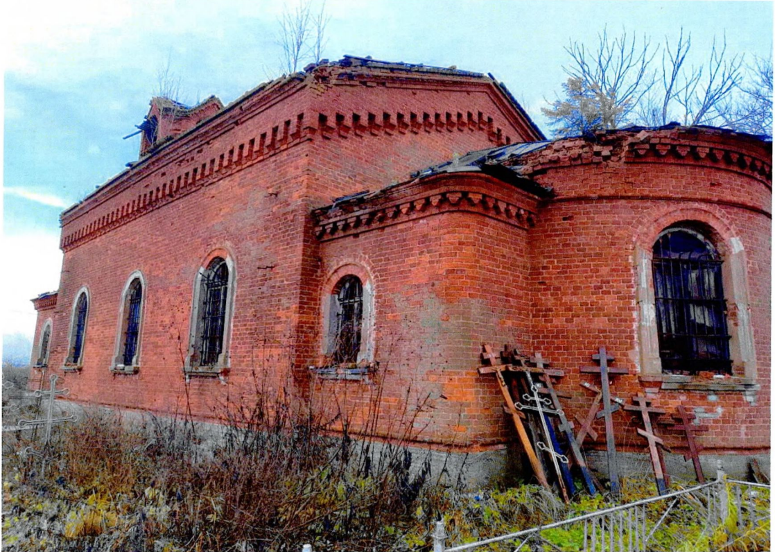
Фото 9. «Церковь Преображенья», юго-восточный фасад здания, металлическая кровля апсиды находится в неудовлетворительном состоянии.
