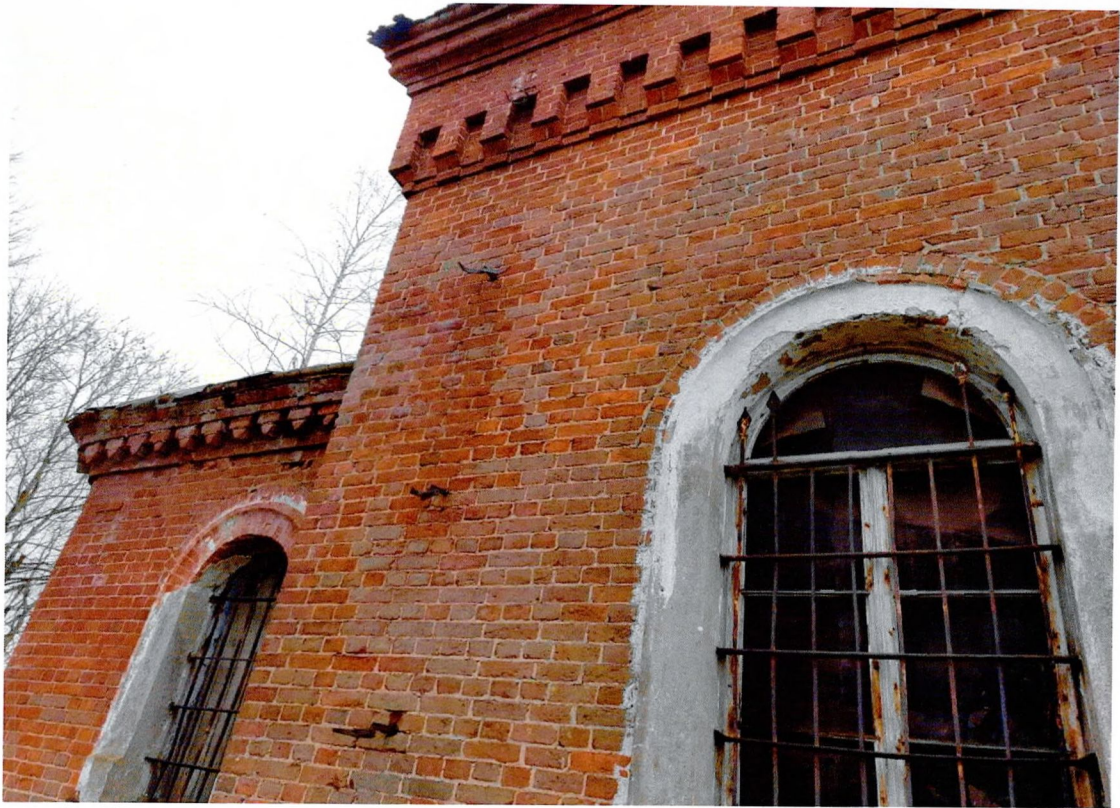
Фото 6. «Церковь Преображенья», утрачена водосточная система на фасадах здания.
