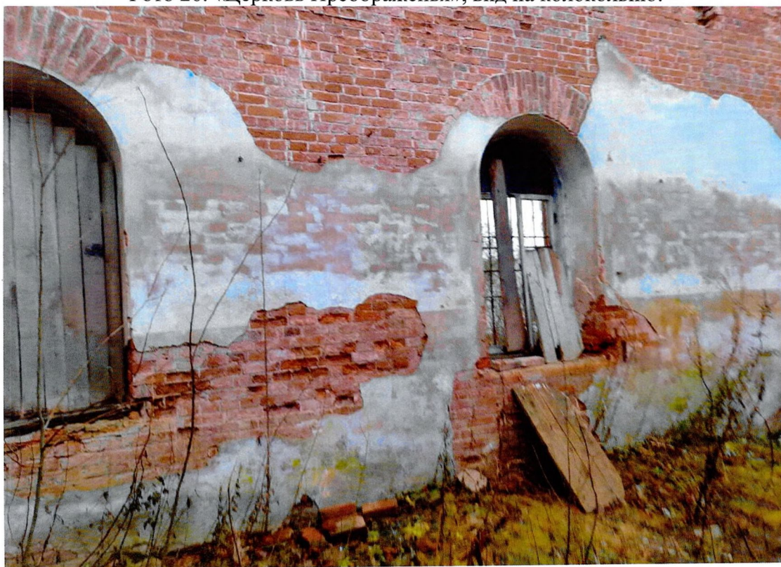
Фото 27. «Церковь Преображенья», деструкция кирпичной кладки стен.
