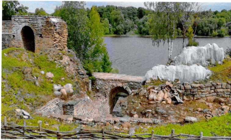
Фото 22. Вид с юго-запада. Аварийное состояние стен и лестницы Тайничный башни.
