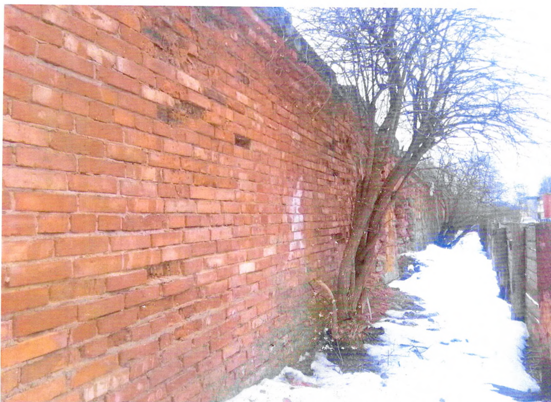
Фото 14. Фрагмент северного фасада. Прорастание деревьев в зоне примыкания к зданию.
