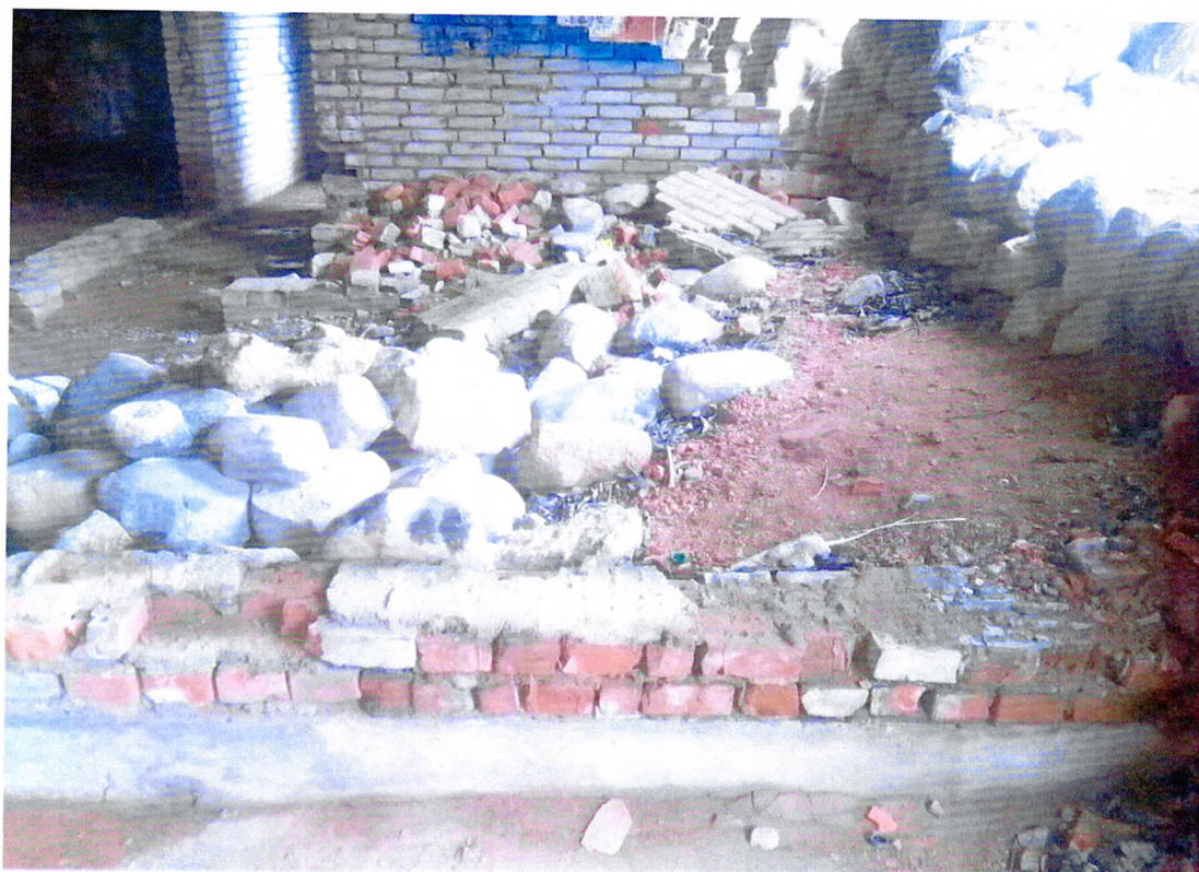
Фото 21. Внутреннее помещение. Полы завалены строительным мусором.
