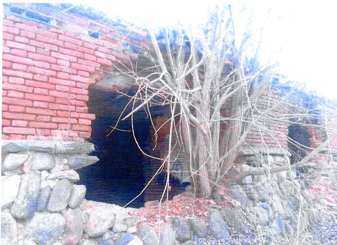
Фото 9. Фрагмент южного фасада. Прорастание деревьев в подоконной зоне оконных проемов.
