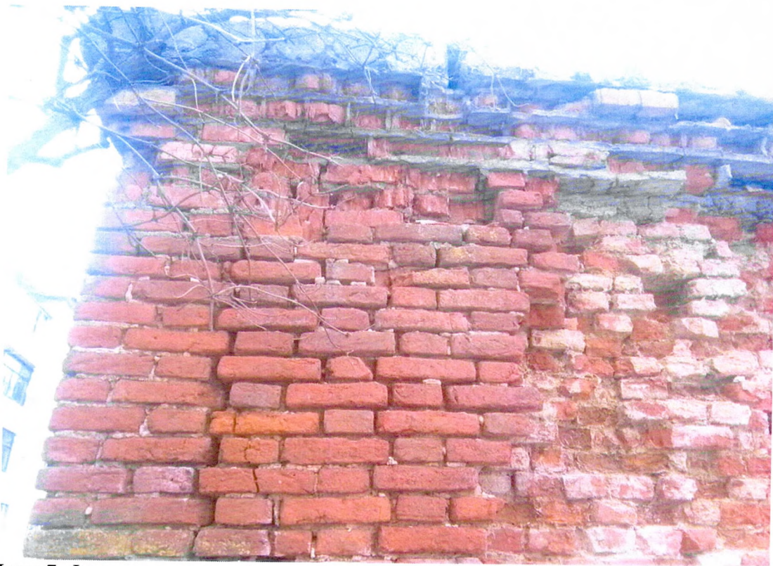
Фото 7. Фрагмент южного фасада. Разрушение наружной версты кирпичной кладки.
