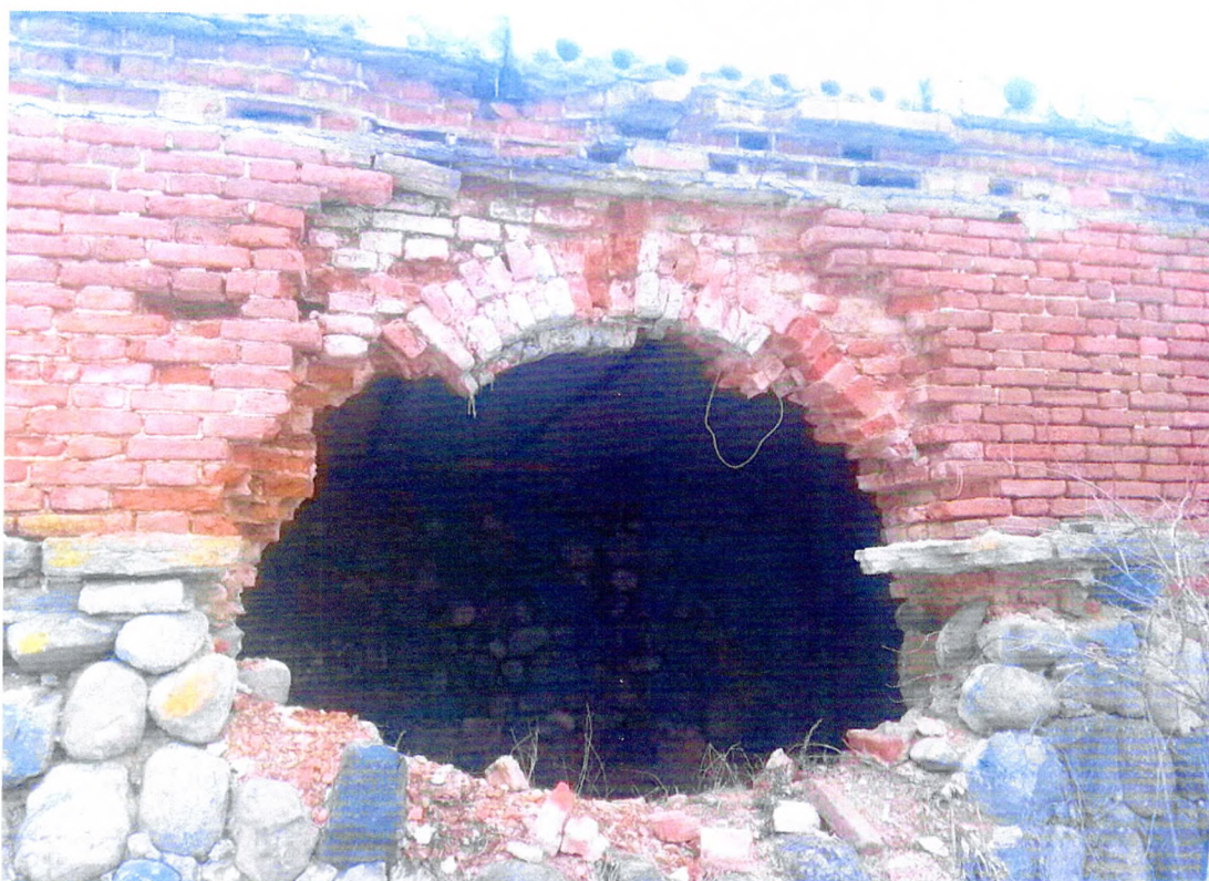
Фото 8. Фрагмент южного фасада. Разрушение кладки арочных перемычек оконных проемов.
