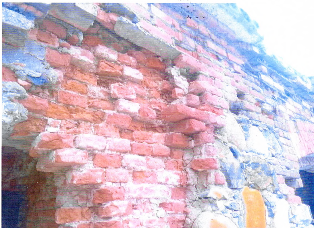
Фото 15. Фрагмент северного фасада. Разрушение наружной версты кирпичной кладки.
