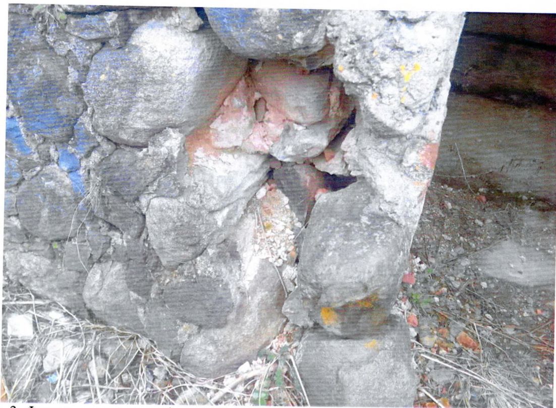
Фото 3. Фрагмент западного фасада. Разрушение валунной кладки откоса дверного проема.
