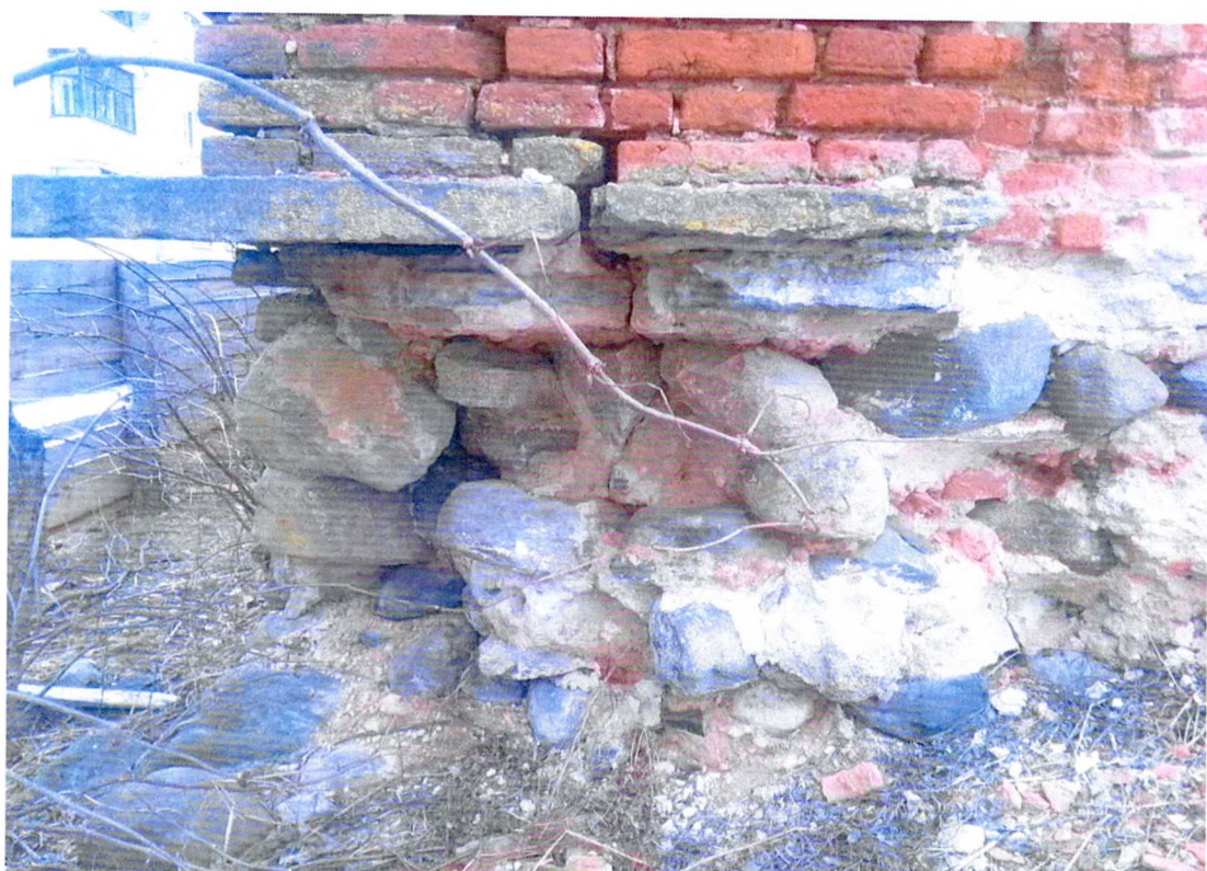
Фото 6. Фрагмент южного фасада. Разрушение валунной кладки угла здания.
