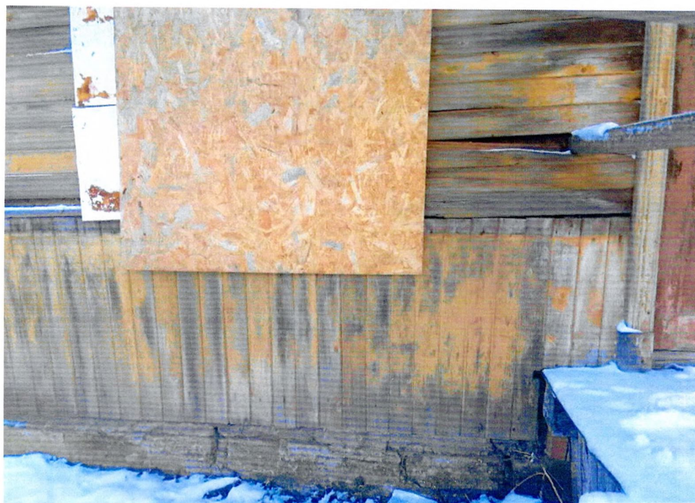
Фото 8. Фрагмент восточного фасада. Разрушения окрасочного слоя стен. Обшивка оконного проема дсп.
