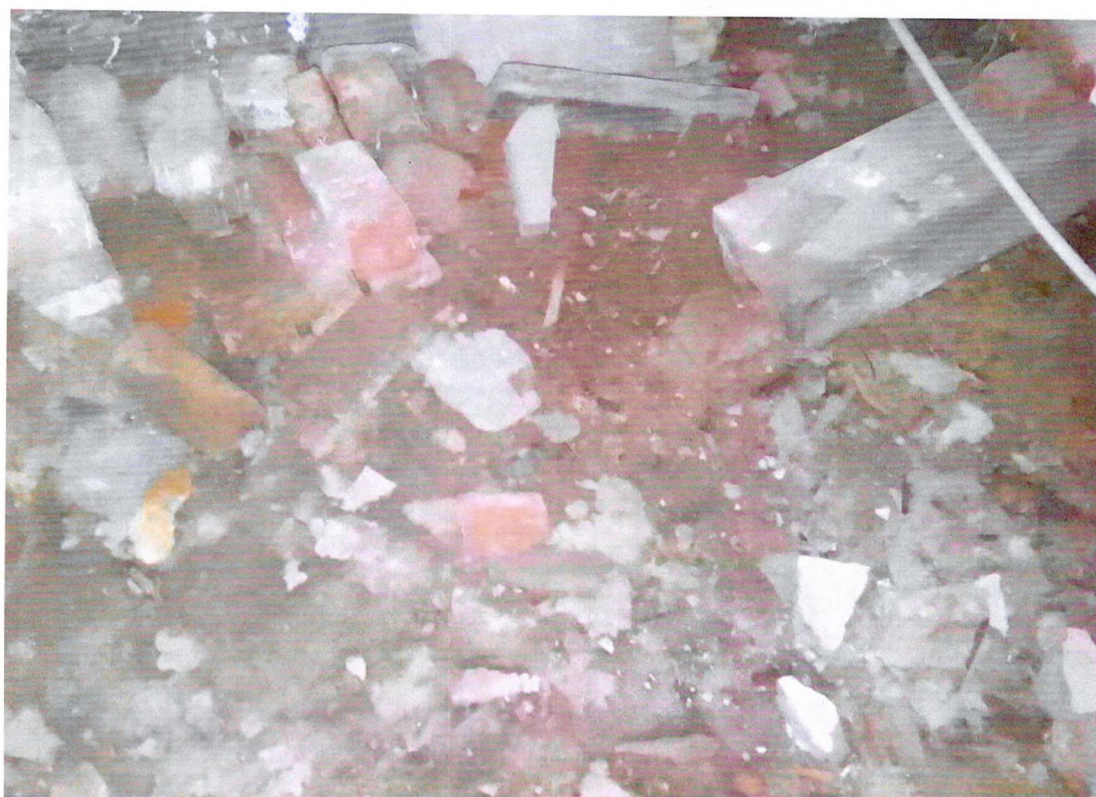
Фото 36. Внутреннее помещение. Полы первого этажа разрушены, основание полов завалено строительным мусором.
