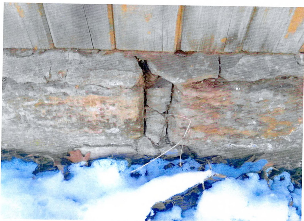
Фото 9. Фрагмент восточного фасада. Разрушение облицовки цоколя из блоков известняка, биоповреждения.
