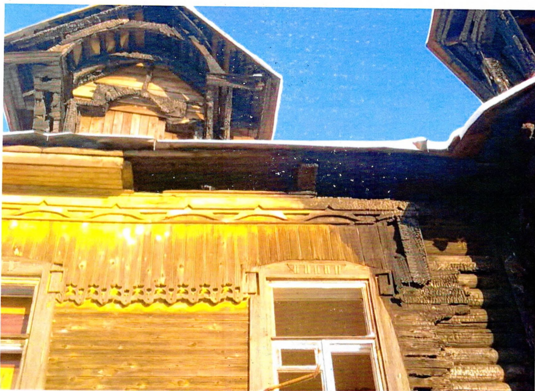
Фото 25. Фрагмент западного фасада. Следы пожара на стропильных конструкциях и конструкциях слухового окна. Утрата досок подшива карниза.
