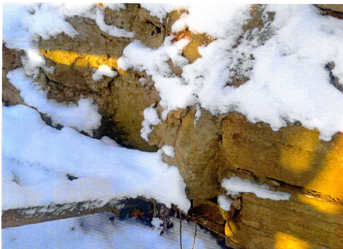
Фото 22. Фрагмент южного фасада. Вывалы облицовочного камня известняка.
