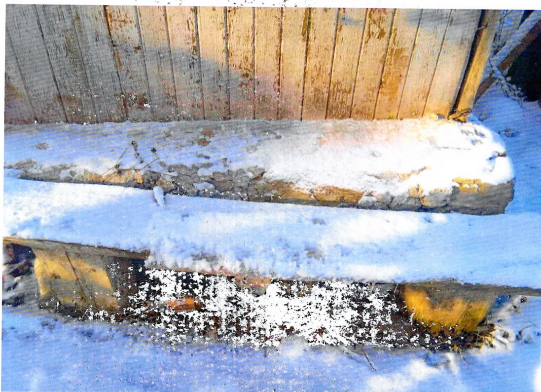
Фото 13. Фрагмент южного фасада. Искривление горизонтальной линии цоколя.
