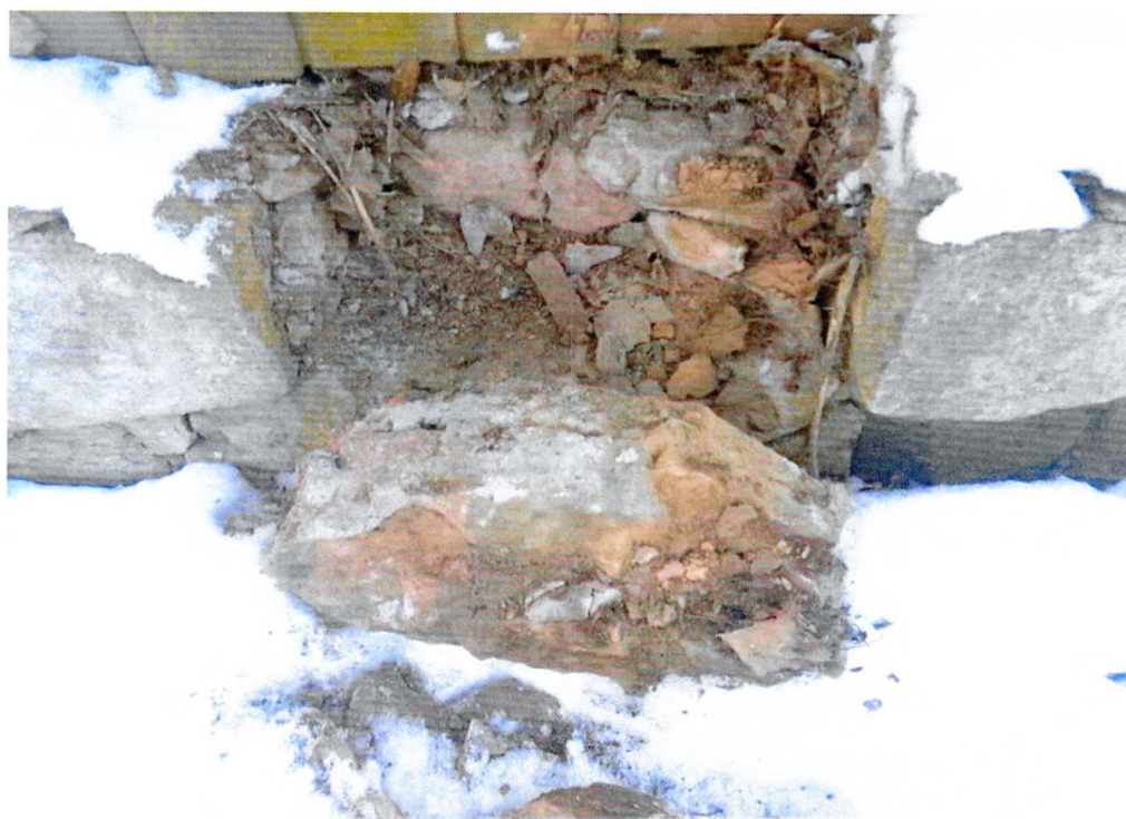
Фото 30. Фрагмент северного фасада. Разрушение облицовки цоколя из известняка. Разрушение кирпичной кладки цоколя.
