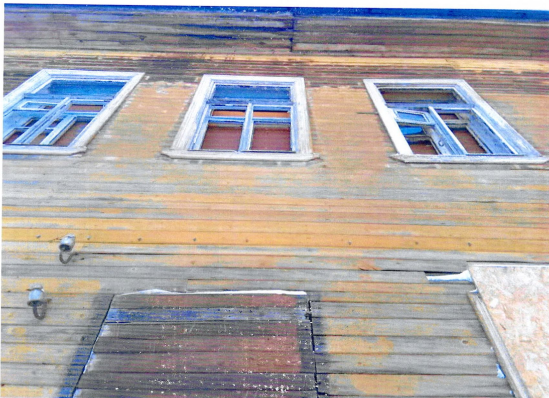
Фото 11. Фрагмент восточного фасада. Утраты остекления оконных проемов.
