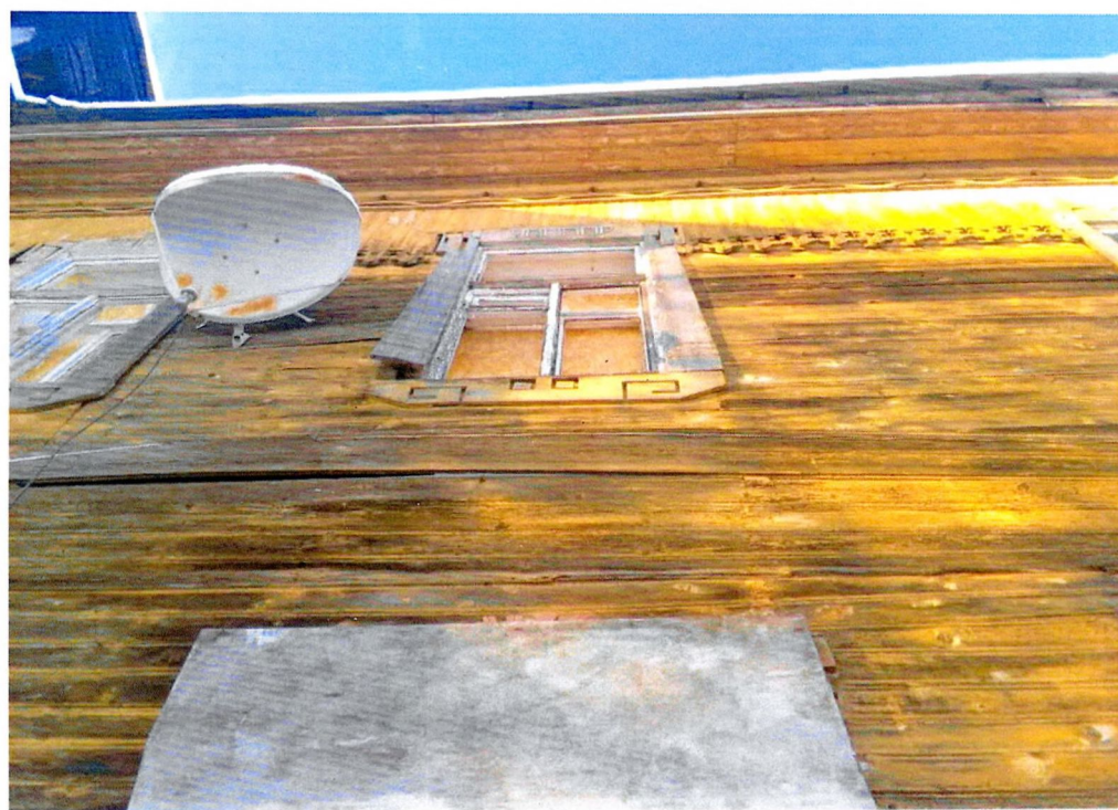
Фото 18. Фрагмент южного фасада. Выпучивание наружной стены. Разрушение крепления оконного наличника второго этажа.
