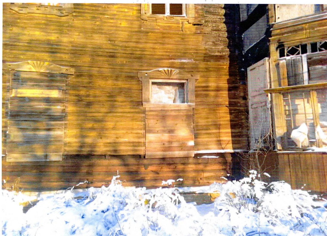
Фото 26. Фрагмент западного фасада. Утрата наружной обшивки нижней части стены, растрескивание, увлажнение древесины.
