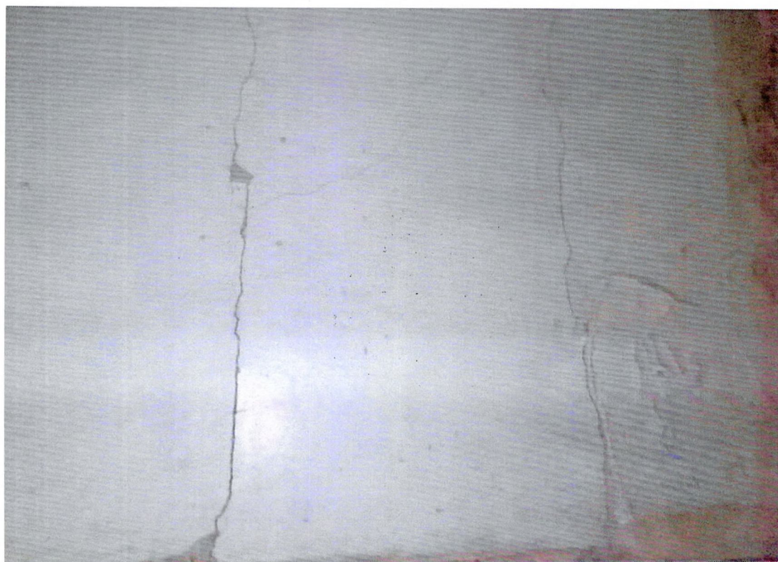
Фото 40. Внутреннее помещение. Трещины в отделке стен.
