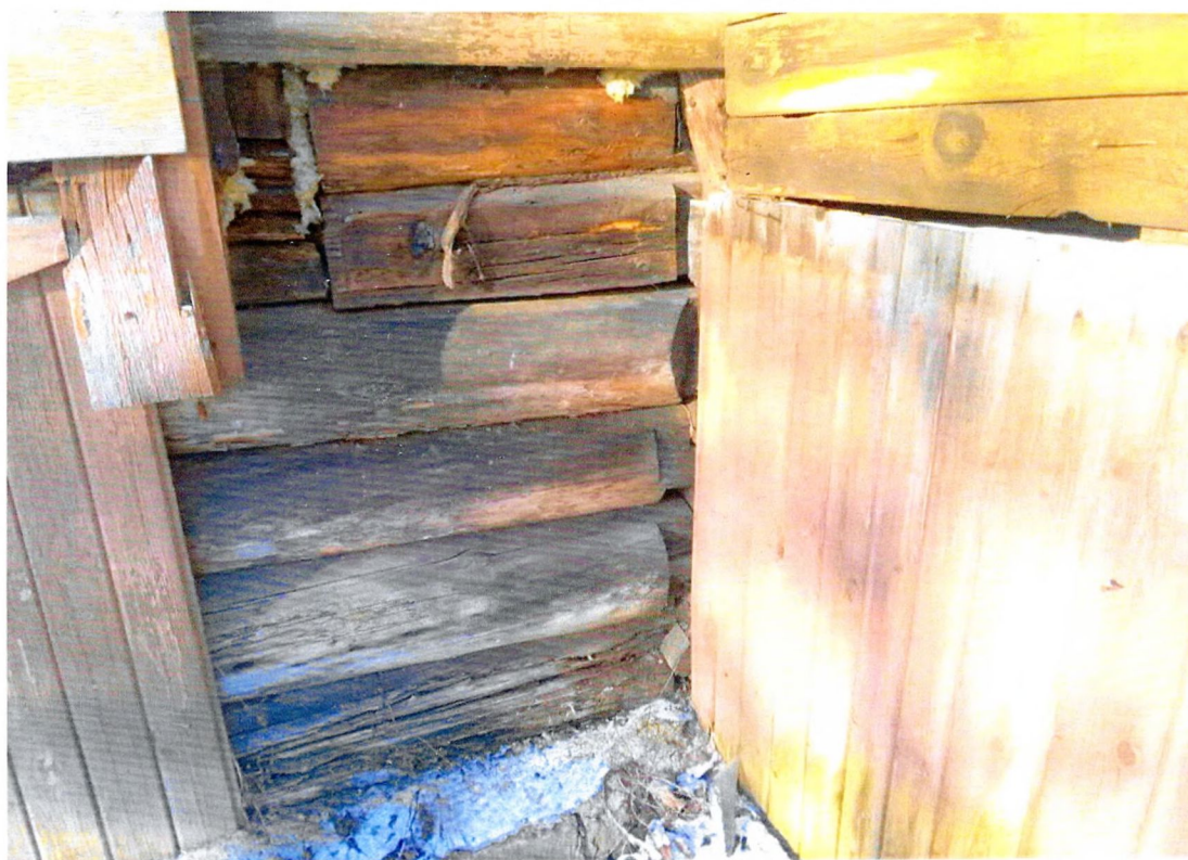
Фото 16. Фрагмент южного фасада. Утрата наружной деревянной обшивки. Гниль нижнего венца сруба.
