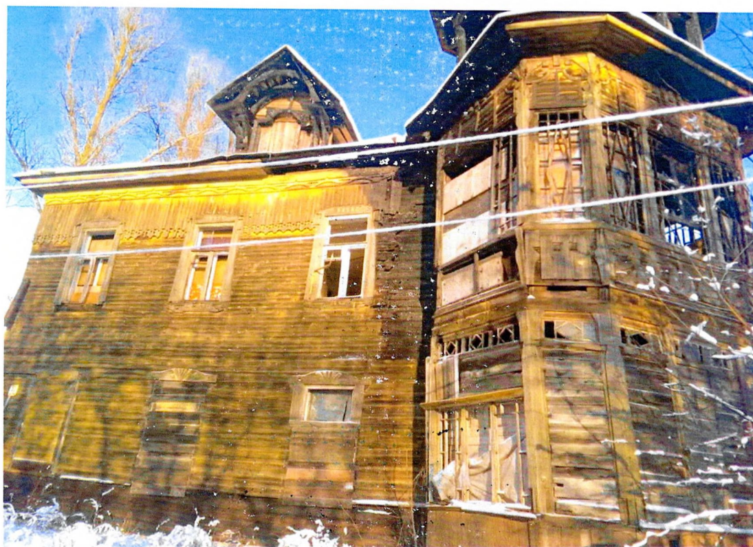
Фото 24. Фрагмент западного фасада. Отклонение конструкций башни от вертикали. Следы пожара на конструкциях башни, стене здания, слуховом окне.
