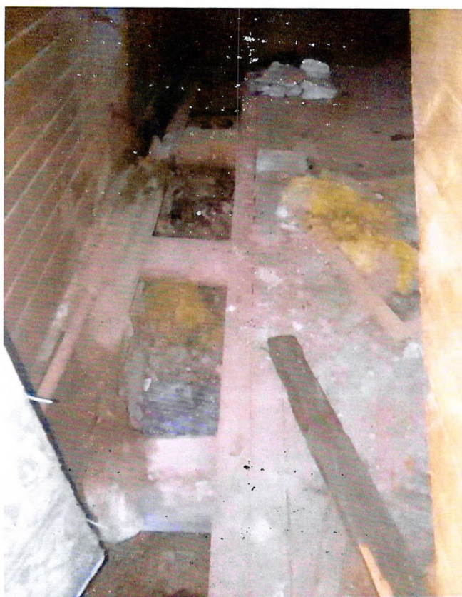
Фото 32. Внутреннее помещение. Разрушение деревянных полов, частичная утрата дощатого настила.
