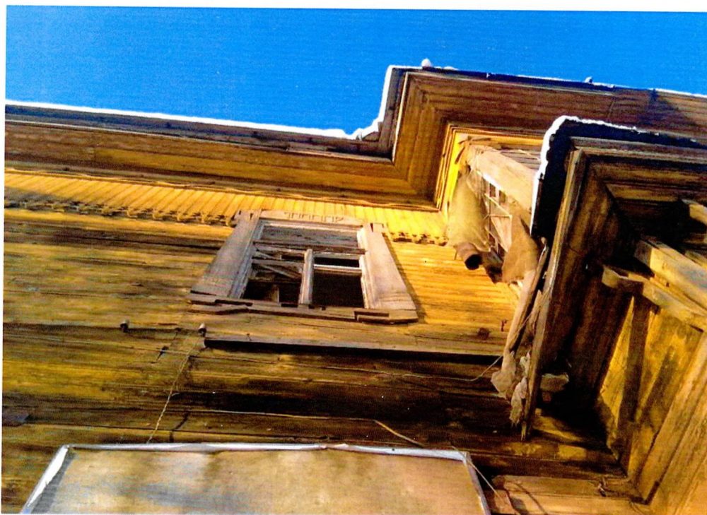
Фото 17. Фрагмент южного фасада. Обрушение досок подшива междуэтажного карниза. Разрушение водосточной трубы.
