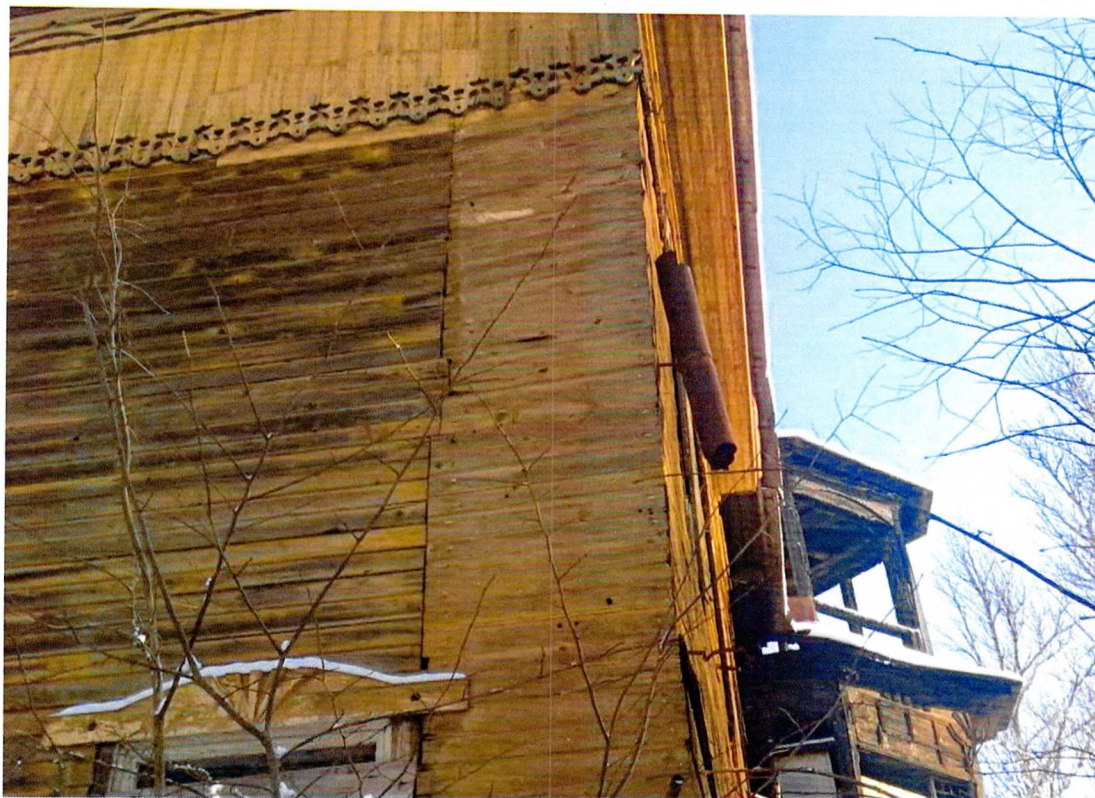
Фото 27. Фрагмент северного фасада. Разрушение водосточной трубы.
