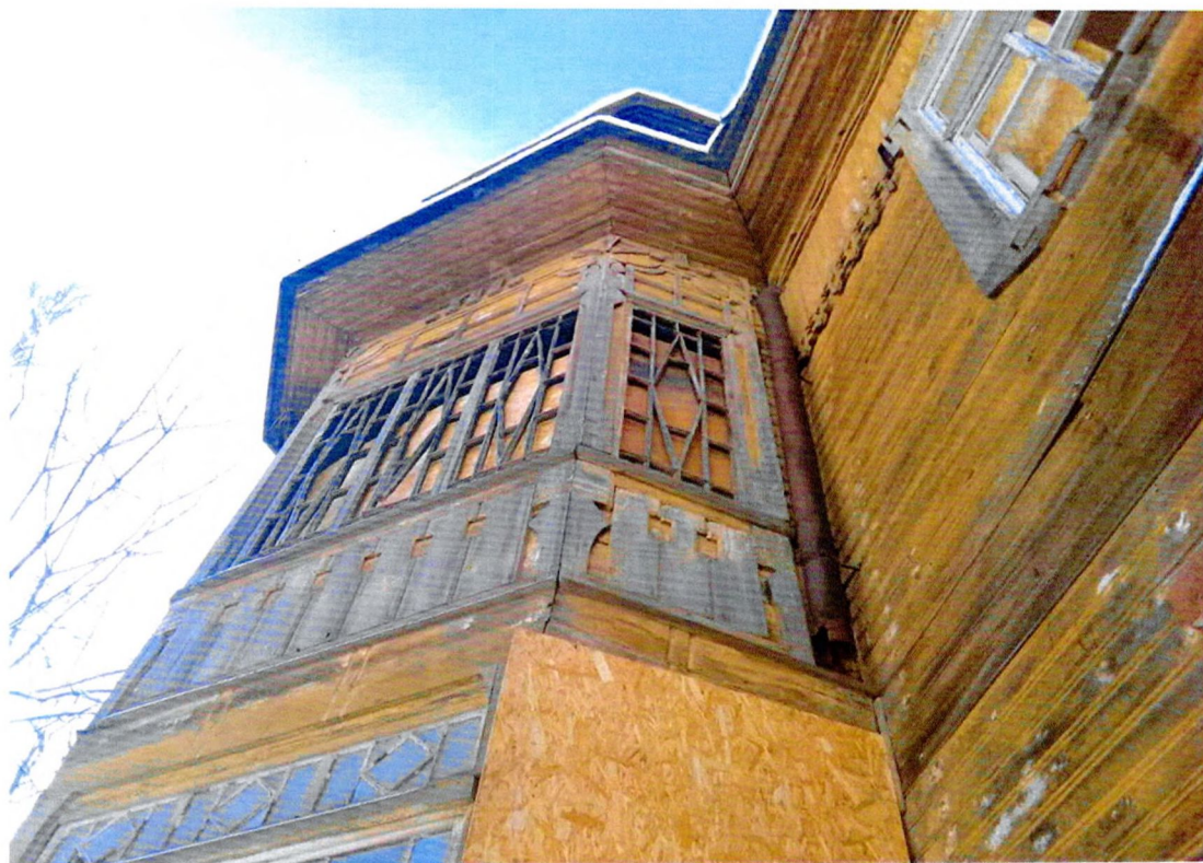
Фото 20. Фрагмент южного фасада. Стертость деревянных декоративных конструкций. Утрата остекления.
