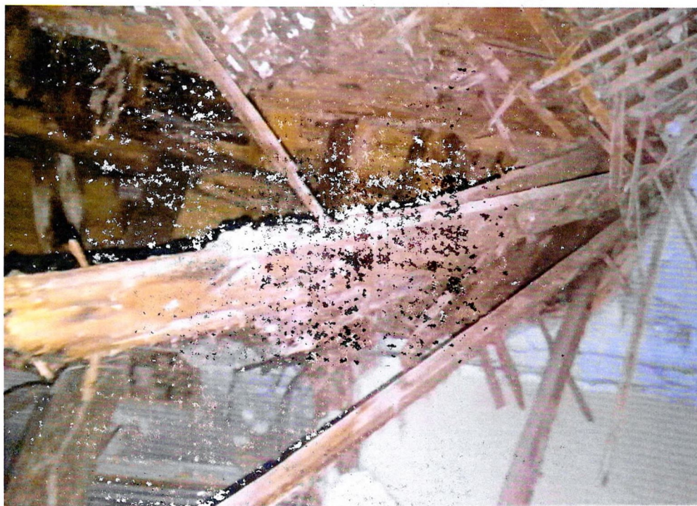
Фото 34. Внутреннее помещение. Обрушение участка перекрытия над первым этажом.
