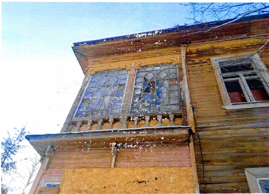
Фото 12. Фрагмент восточного фасада. Стертость деревянных декоративных конструкций балкона. Разрушение остекления.
