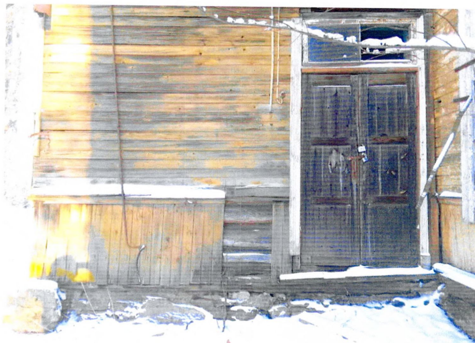
Фото 29. Фрагмент северного фасада. Перекос дверной коробки, утрата остекления фрамуги. Утрата части наружной обшивки. Разрушение облицовки цоколя из известняка.
