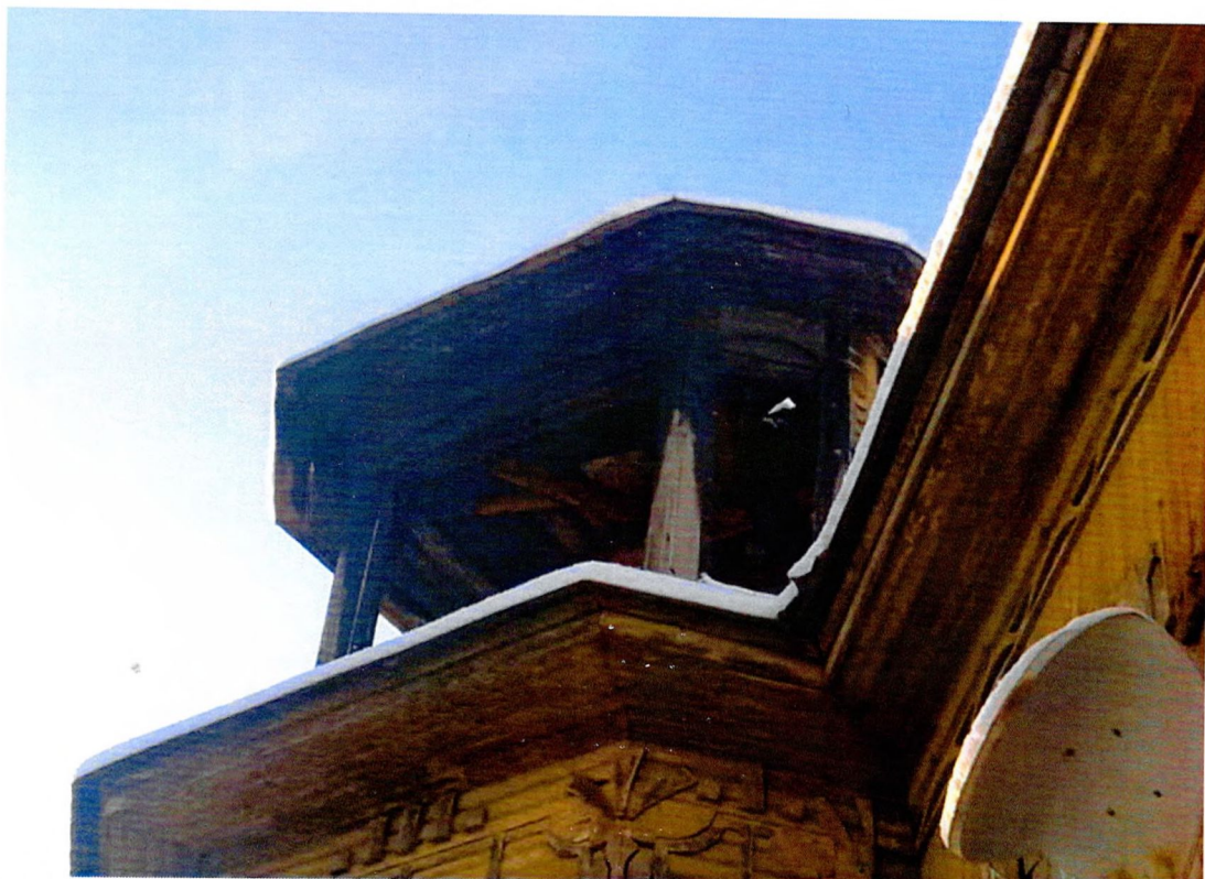
Фото 21. Фрагмент южного фасада. Следы пожара на деревянных конструкциях башни.
