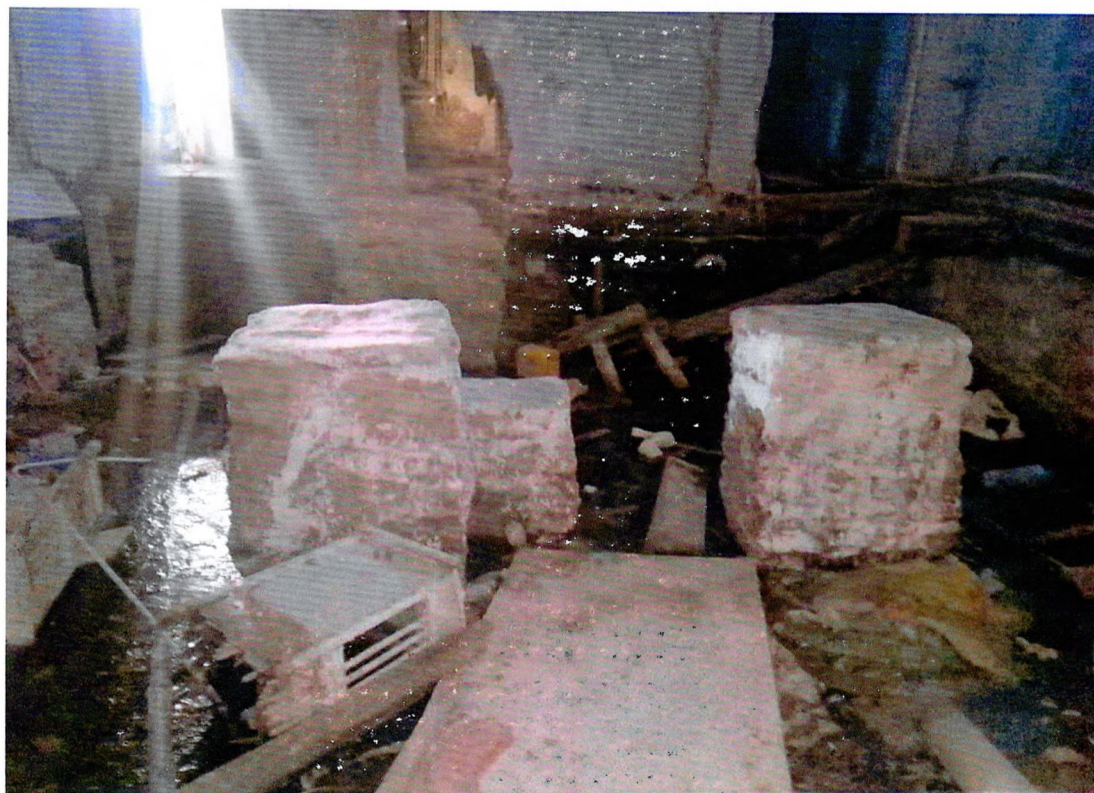
Фото 38. Внутреннее помещение. Вид на опорные кирпичные столбики, деревянные балки пола первого этажа утрачены.
