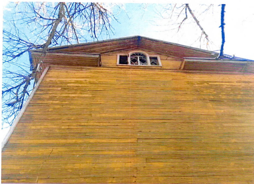
Фото 31. Фрагмент северного фасада. Разрушение остекления трехчастного чердачного оконного проема. Утрата окрасочного слоя наружной обшивки фасада.
