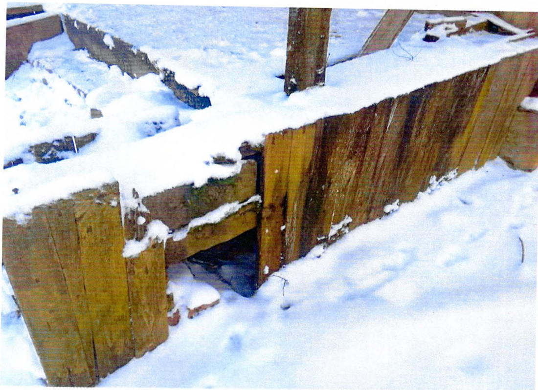
Фото 5. Фрагмент восточного фасада. Утрата деревянной обшивки ступеней крыльца.
