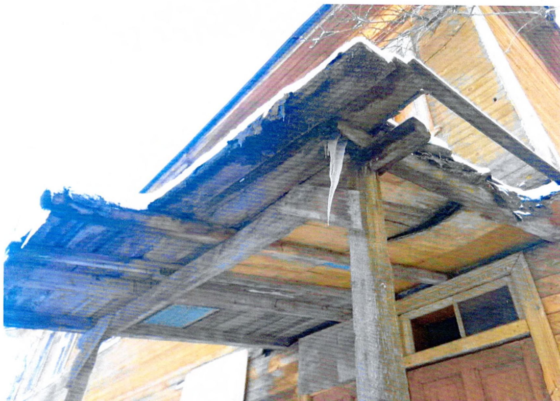
Фото 6. Фрагмент восточного фасада. Разрушение конструкций стропил и обрешетки козырька, прогиб настила.
