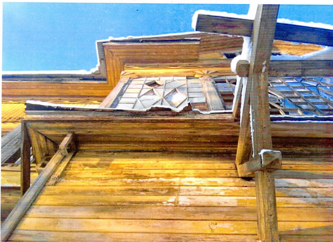
Фото 15. Фрагмент южного фасада. Утраты остекления балкона. Трещины на деревянных резных колоннах.
