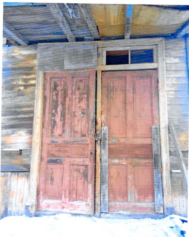
Фото 7. Фрагмент восточного фасада. Дверное полотно осело, дверные коробки перекошены, наличники повреждены.
