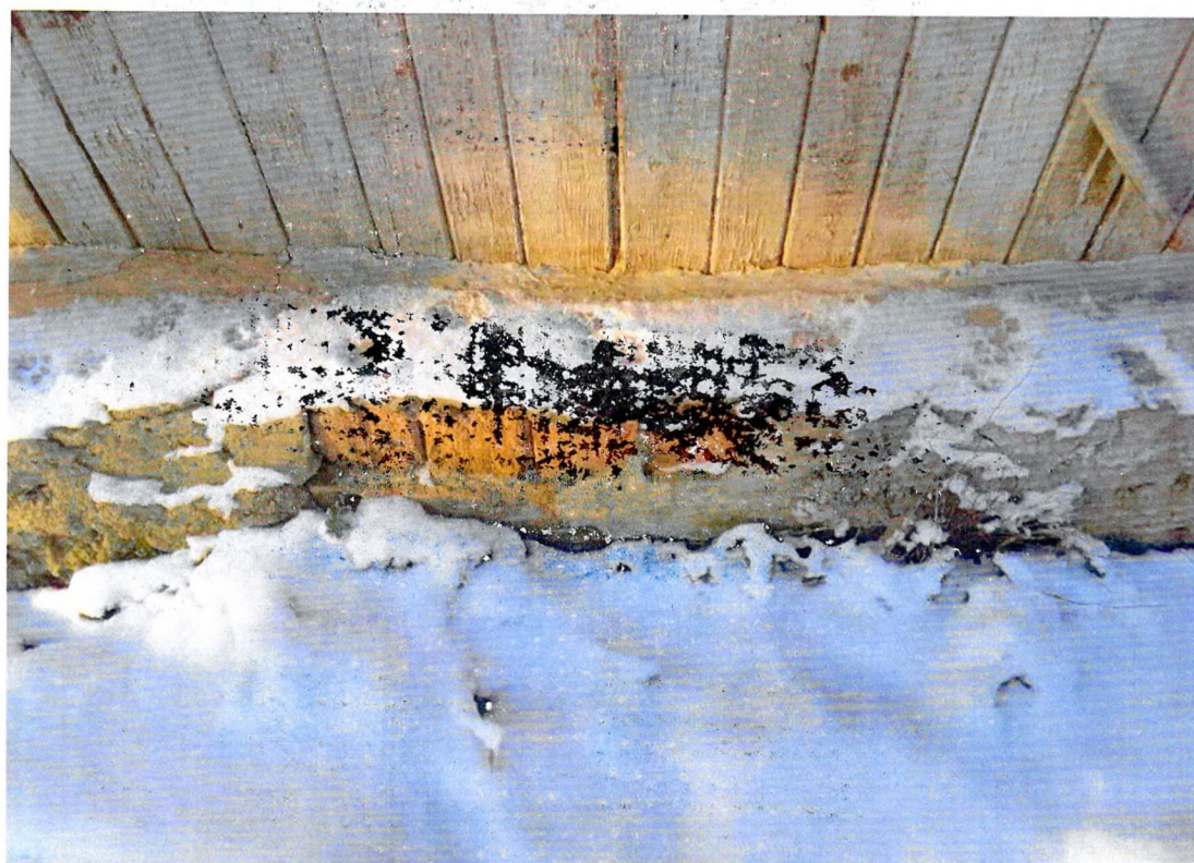
Фото 14. Фрагмент южного фасада. Разрушение облицовки цоколя из известняка.
