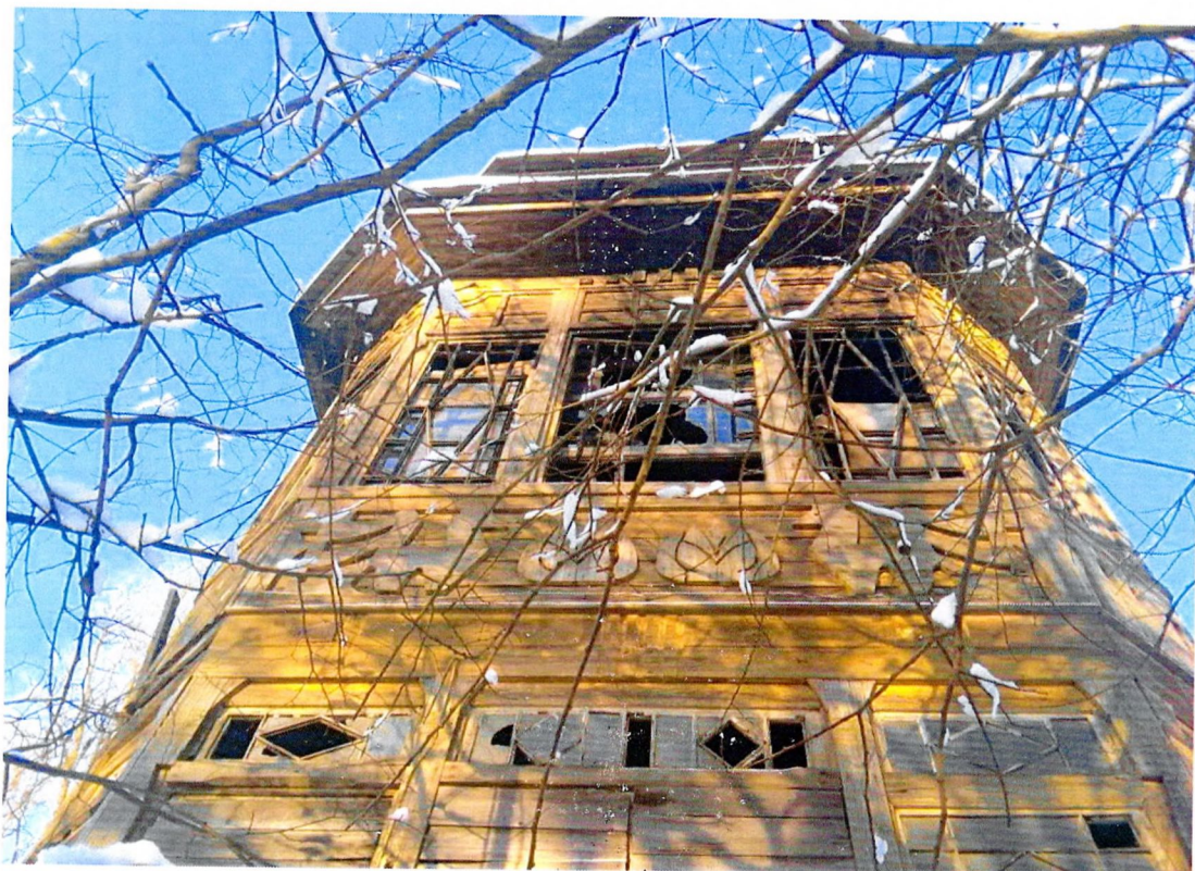
Фото 23. Фрагмент южного фасада. Утрата остекления башни.
