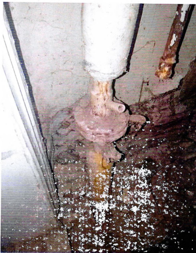
Фото 33. Внутреннее помещение. Недействующие инженерные коммуникации. Разрушение отделочного слоя стены, обнажение драйки.
