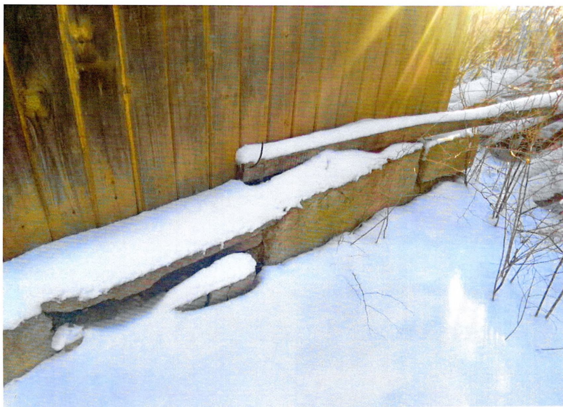
Фото 28. Фрагмент северного фасада. Вывалы облицовки цоколя из известняка.
