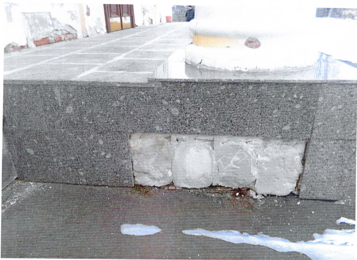
Фото 13. Фрагмент южного фасада. Утраты облицовки цоколя портика. Разрушение штукатурного слоя базы колонны, обнажение кирпичной кладки.
