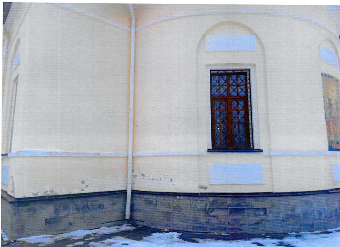
Фото 16. Фрагмент восточного фасада. Апсида. Отслоение окрасочного слоя стен.
