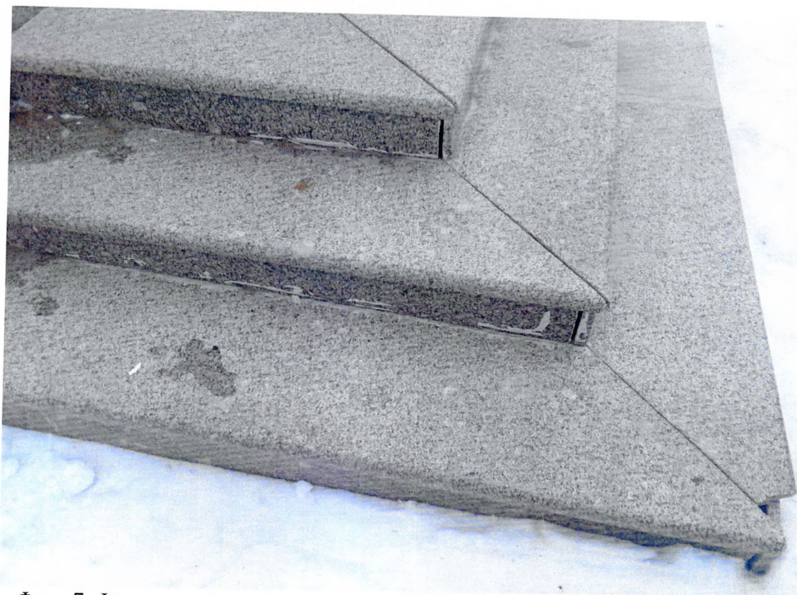
Фото 7. Фрагмент западного фасада. Сколы ступеней, нарушение стыков плит.
