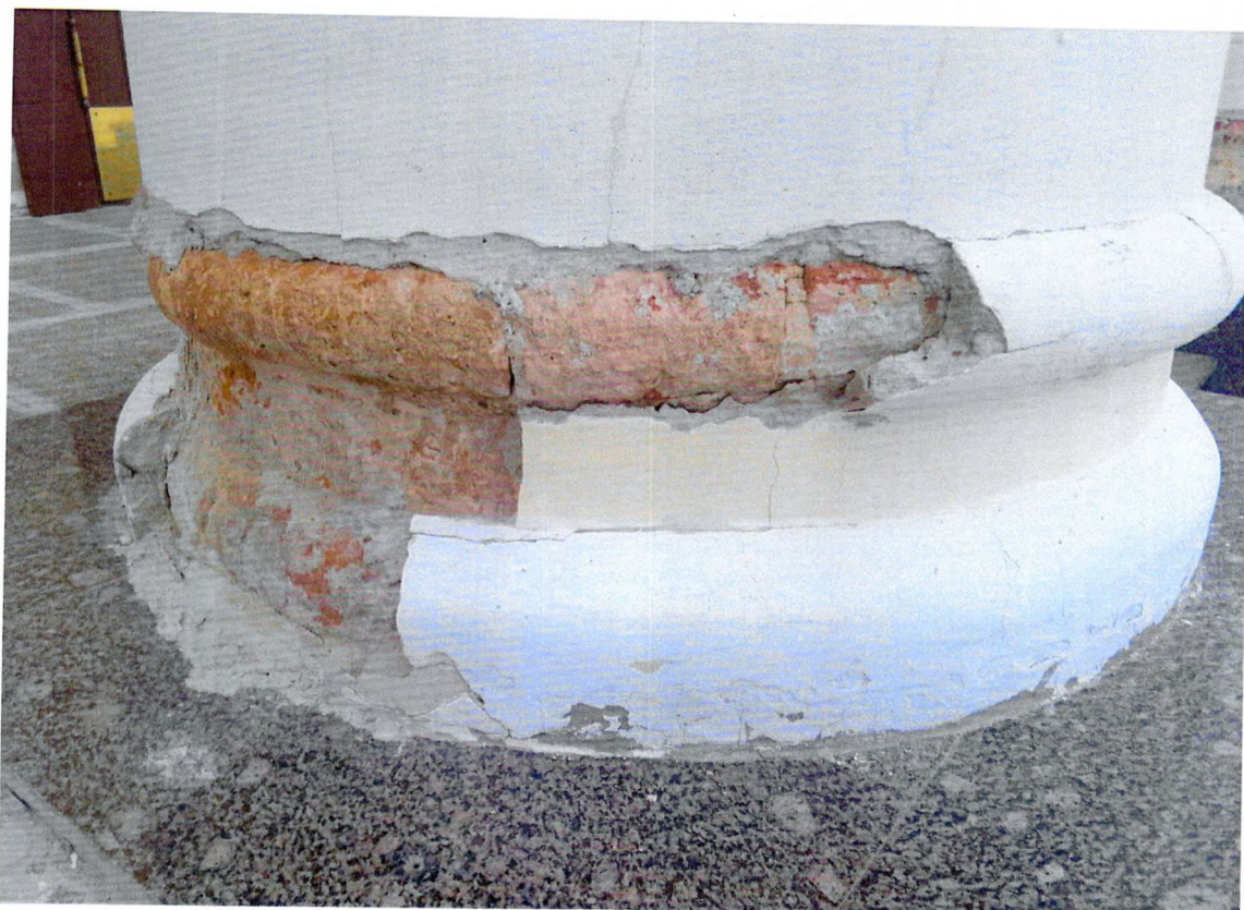
Фото 15. Фрагмент южного фасада. Разрушение штукатурного слоя баз колонн портика, обнажение кирпичной кладки.
