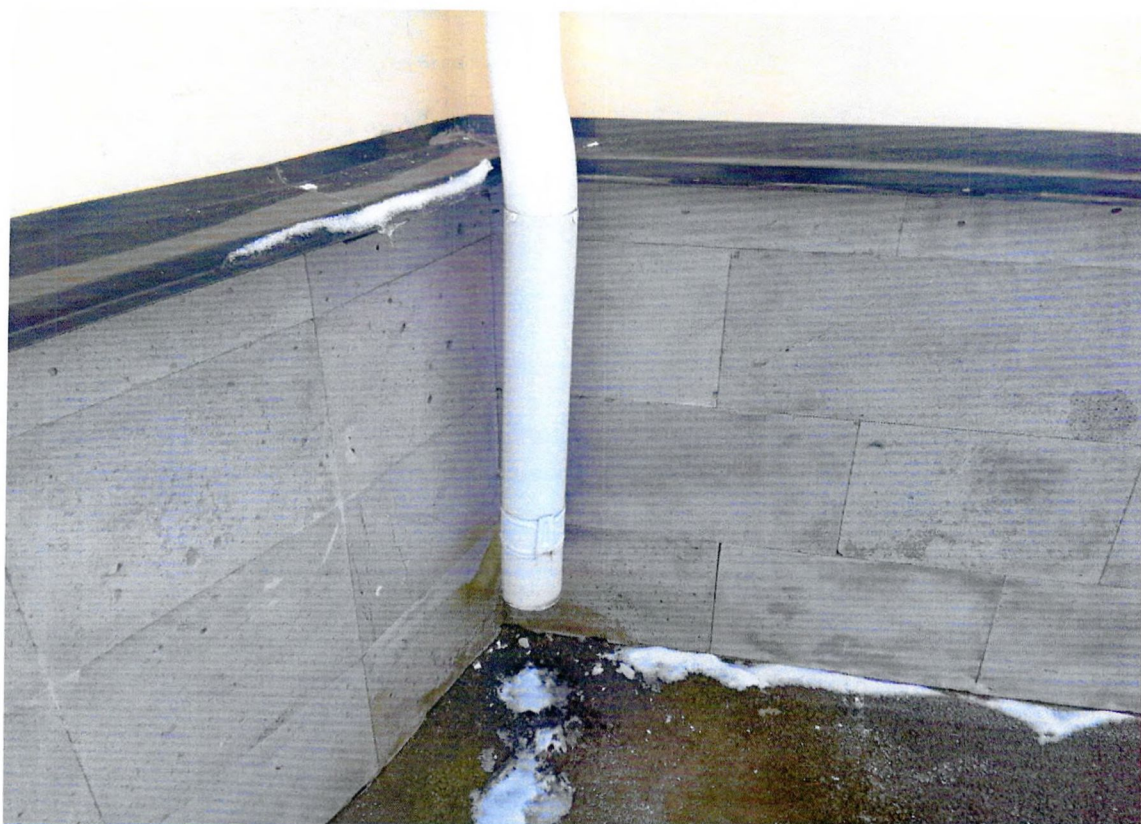
Фото 18. Фрагмент восточного фасада. Биоповреждение цоколя. Отсутствие колена водосточной трубы.
