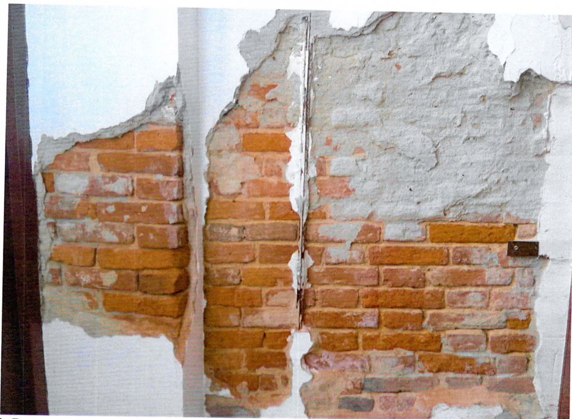
Фото 23. Разрушение штукатурного слоя стен паперти, обнажение кирпичной кладки, насыщение кирпичной кладки влагой.
