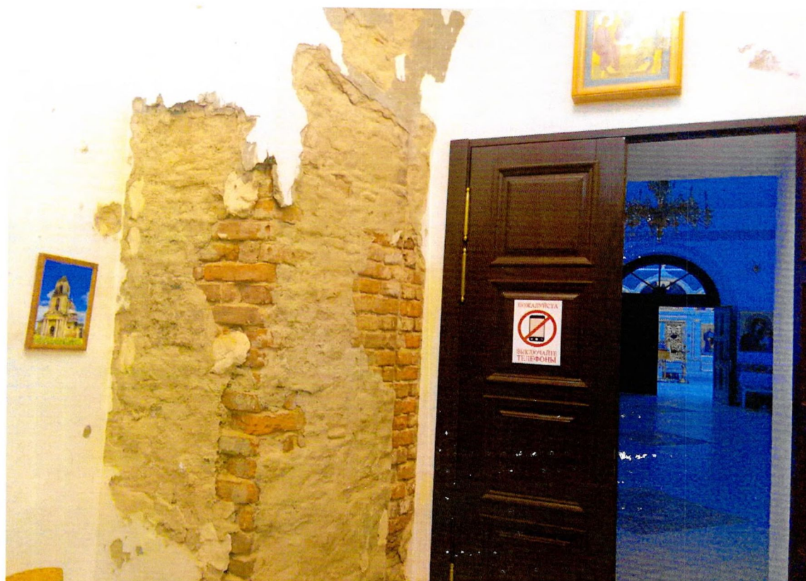
Фото 24. Разрушение штукатурного слоя стен притвора, обнажение кирпичной кладки, насыщение кирпичной кладки влагой.
