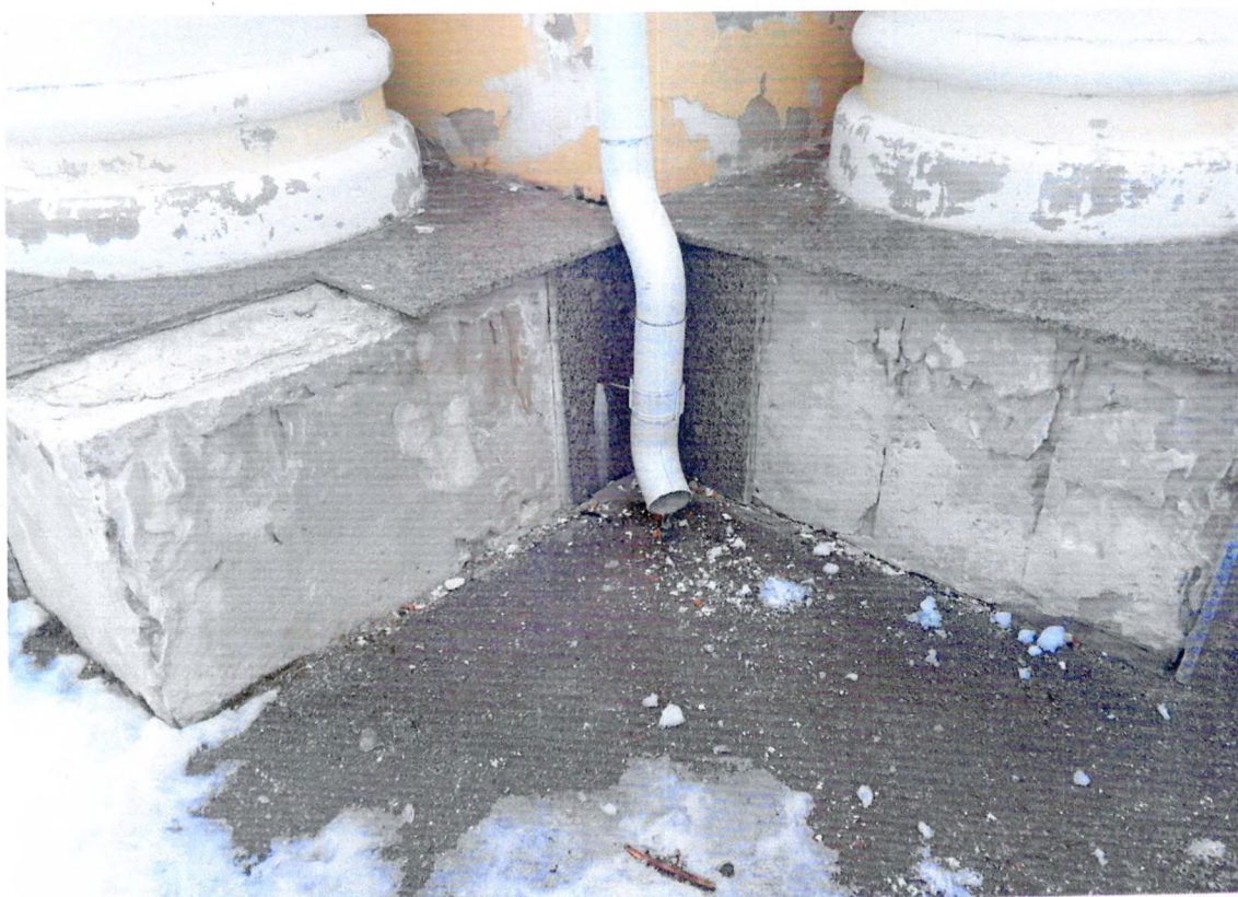
Фото 6. Фрагмент западного фасада. Утраты облицовки цоколя портика.
