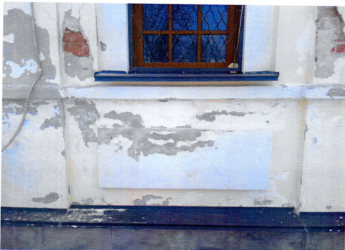
Фото 11. Фрагмент южного фасада. Разрушение штукатурного слоя, обнажение кирпичной кладки стены.
