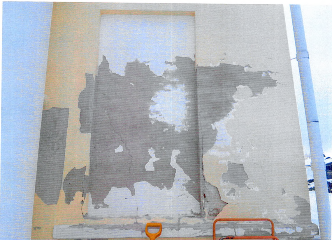
Фото 9. Фрагмент западного фасада. Утраты окрасочного слоя, трещины в штукатурном слое.
