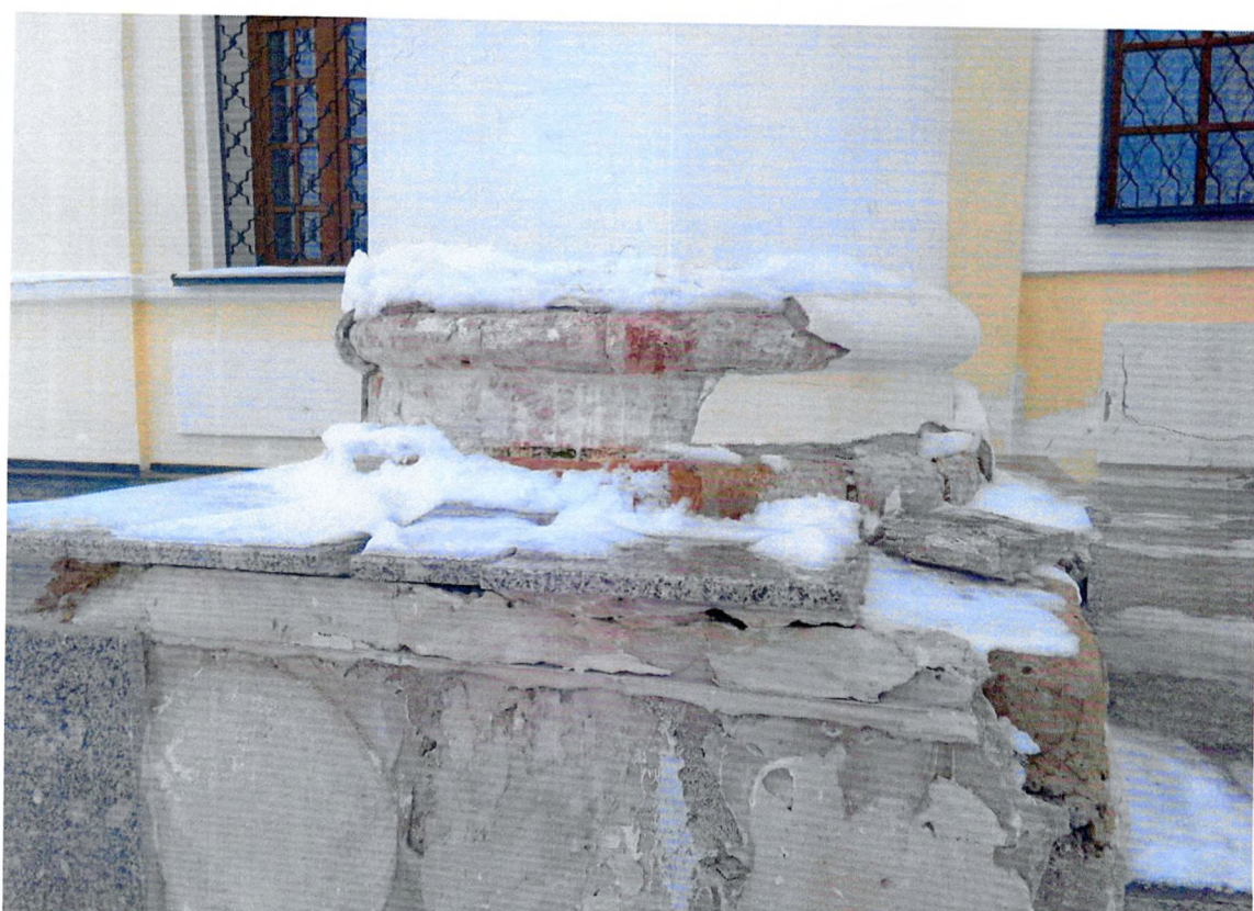
Фото 20. Фрагмент северного фасада. Утраты облицовки цоколя портика. Разрушение штукатурного слоя базы колонн, обнажение кирпичной кладки.
