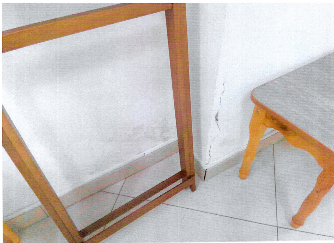
Фото 29. Трещина в штукатурном слое, отслоение окрасочного слоя в нижней части стены.
