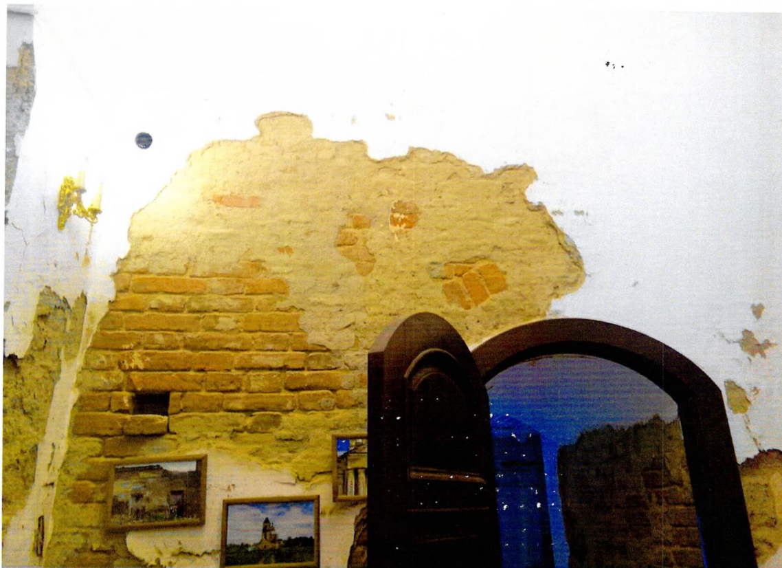
Фото 25. Разрушение штукатурного слоя стен притвора, обнажение кирпичной кладки, насыщение кирпичной кладки влагой.
