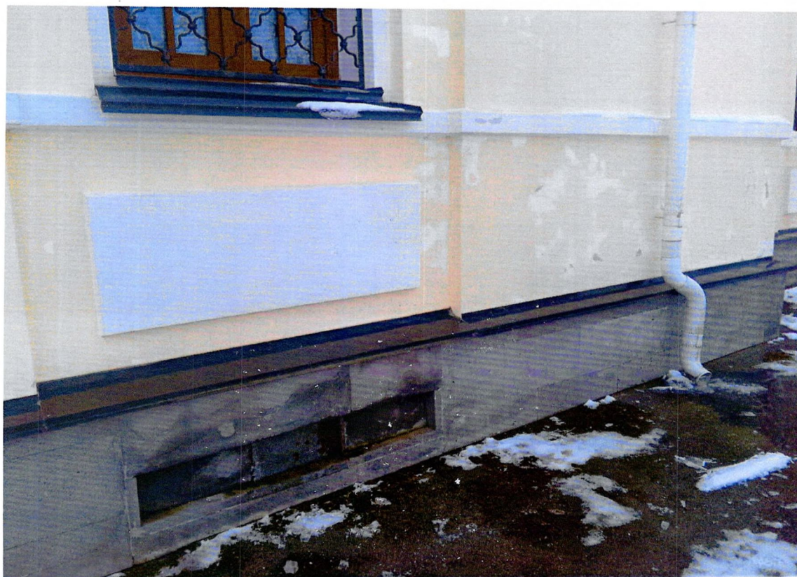
Фото 22. Фрагмент северного фасада. Биоповреждения цоколя и отмостки.
