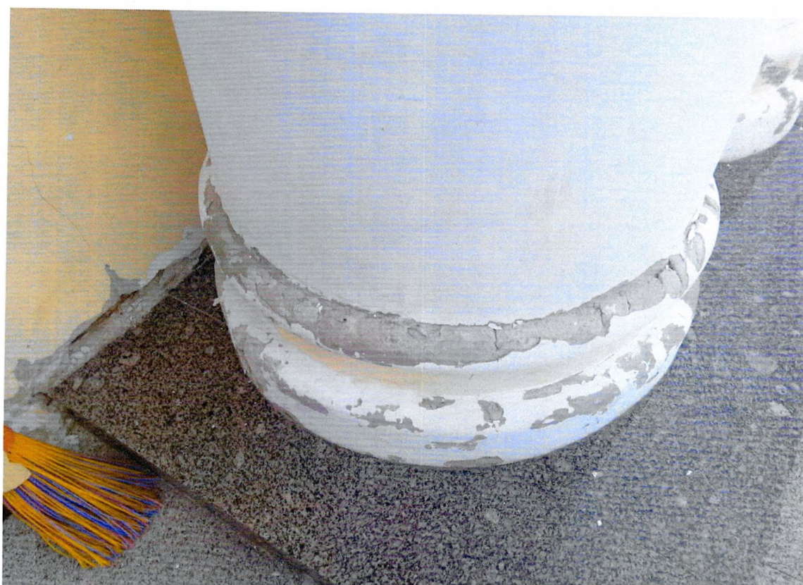
Фото 8. Фрагмент западного фасада. Отслоение окрасочного слоя, трещины в штукатурном слое базы колонн.
