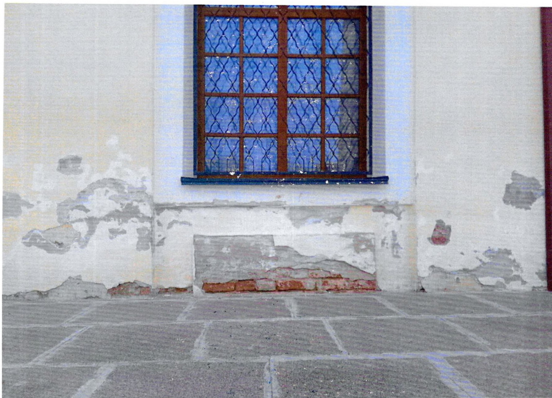
Фото 14. Фрагмент южного фасада. Разрушение штукатурного слоя стен, обнажение кирпичной кладки.
