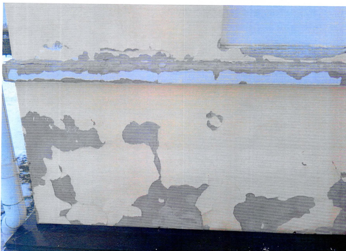
Фото 4. Фрагмент западного фасада. Отслоение окрасочного слоя стен и карниза.
