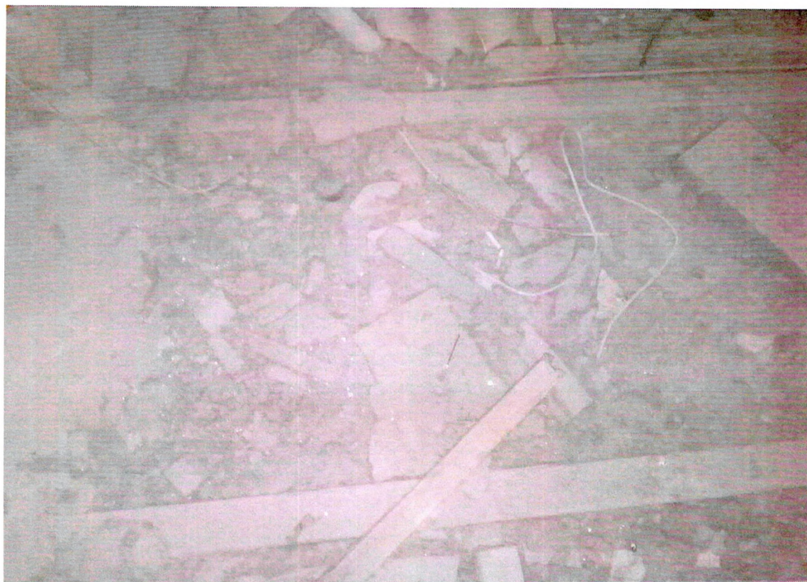
Фото 28. Скопление строительного мусора на чердачном перекрытии.
