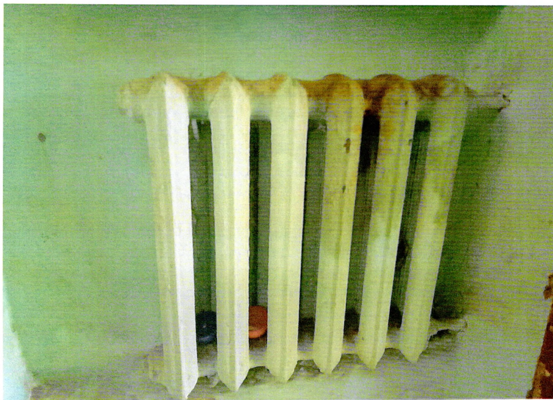
Фото 26. Коррозия чугунного радиатора отопления.
