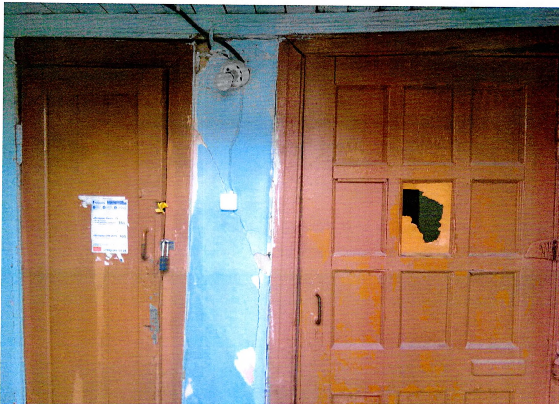
Фото 23. Дверные полотна осели, имеют неплотный притвор по периметру коробки, наличники повреждены. Разрушение материала дверного полотна. Трещины в перегородке.
