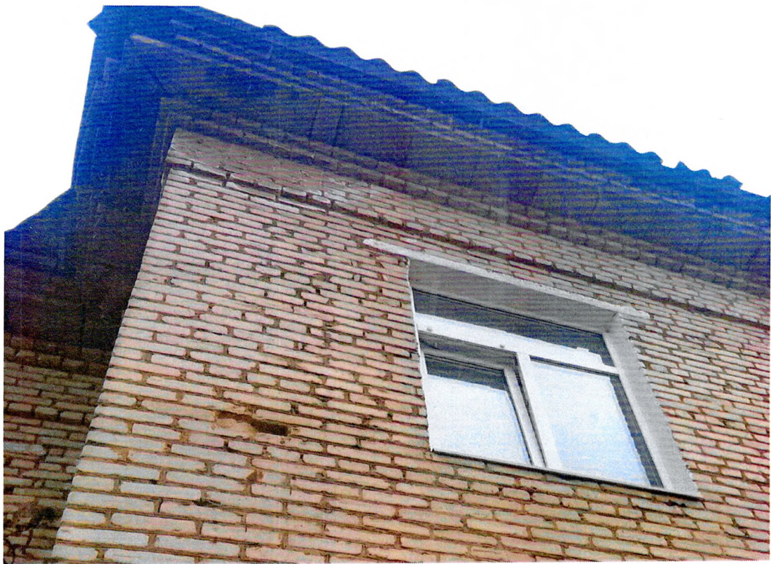
Фото 10. Фрагмент северного фасада. Выпадение отдельных кирпичей из карниза.
