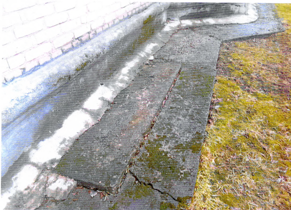
Фото 15. Фрагмент южного фасада. Биоповреждение, трещины в отмостке.
