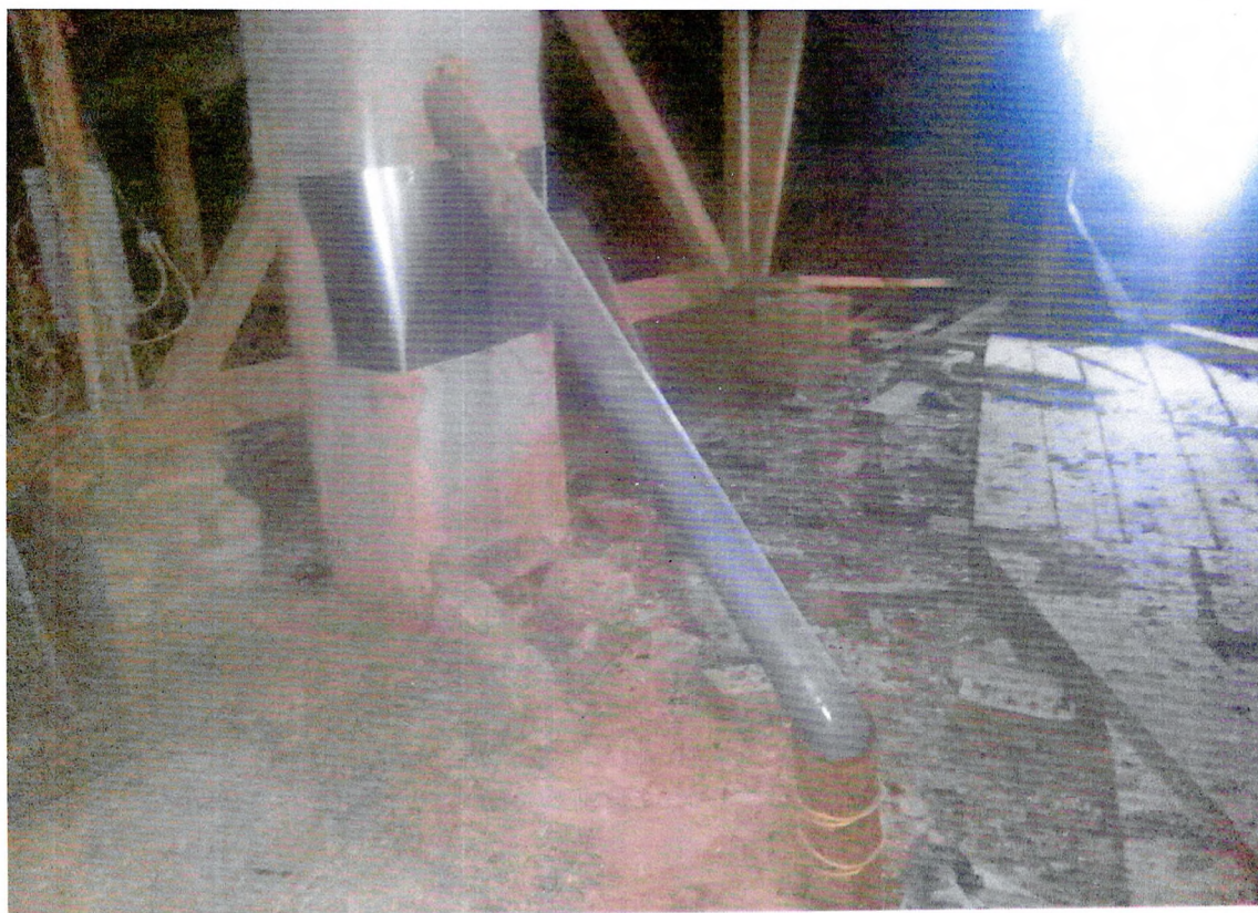
Фото 30. Вытяжной стояк канализации на чердаке выведен в короб вентиляции.
