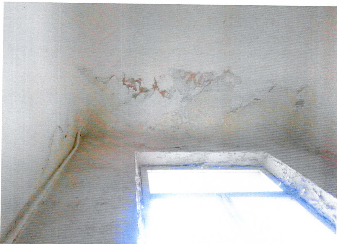
Фото 27. Следы протечек кровли на чердачном перекрытии, стенах второго этажа и откосах оконного проема.
