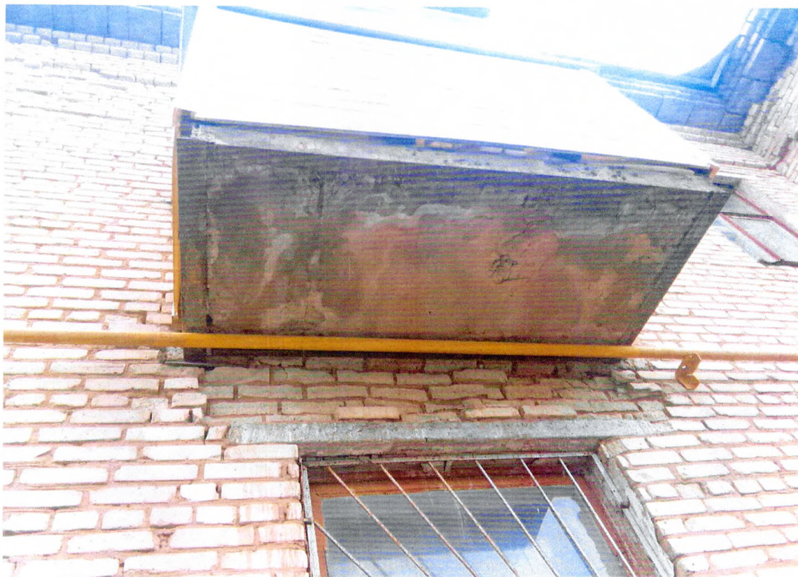
Фото 7. Фрагмент северного фасада. Разрушение защитного слоя бетона, оголение и коррозия арматуры балконной плиты. Деструкция кирпичной кладки под плитой.
