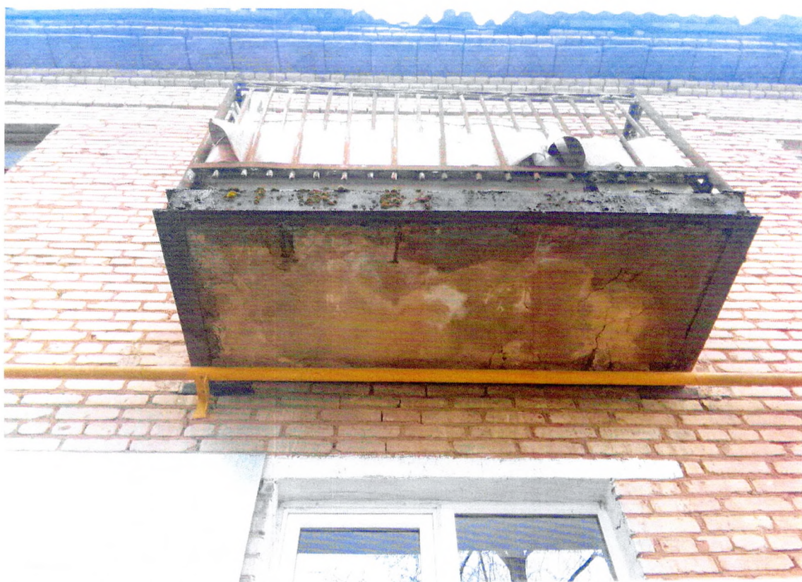
Фото 6. Фрагмент северного фасада. Разрушение защитного слоя бетона, оголение и коррозия арматуры балконной плиты.
