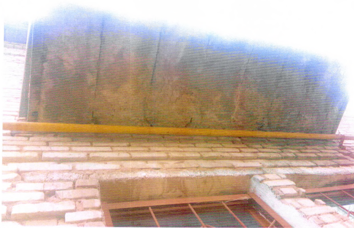
Фото 21. Фрагмент восточного фасада. Разрушение защитного слоя бетона, оголение и коррозия арматуры балконной плиты.
