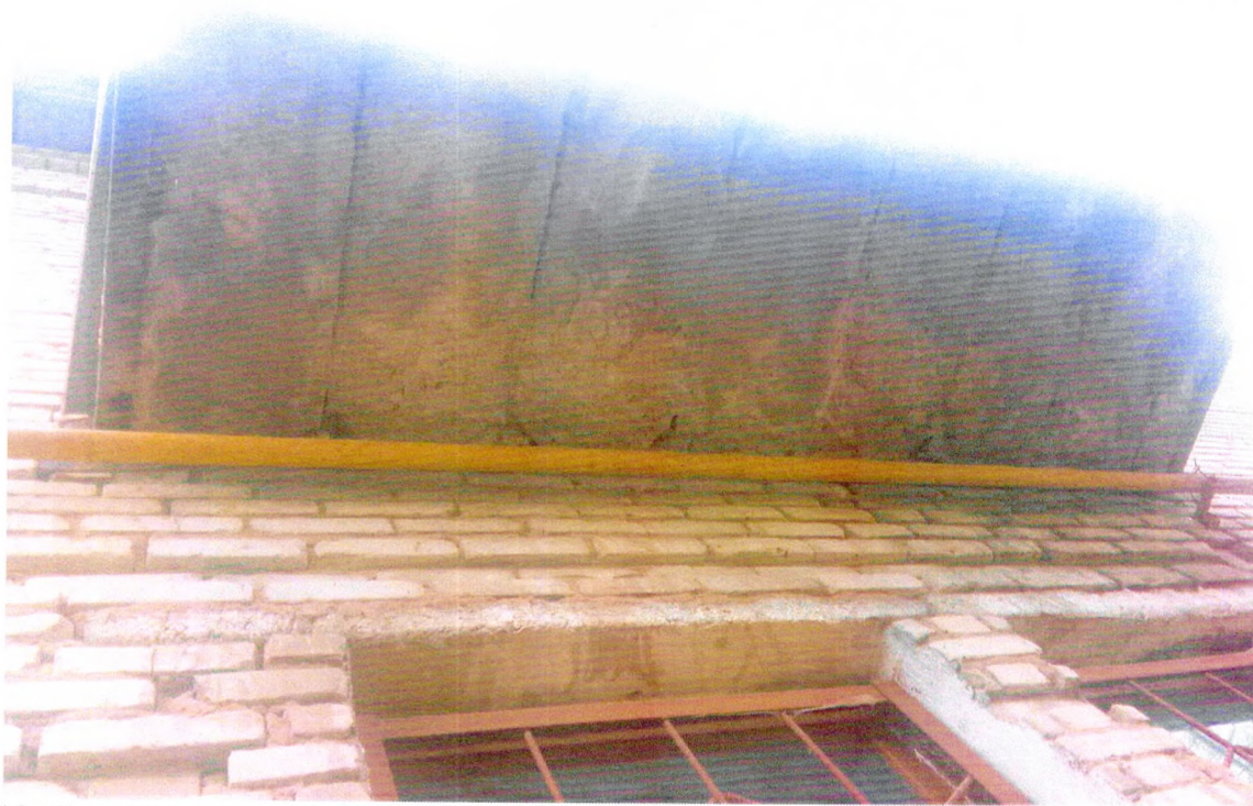
Фото 13. Фрагмент западного фасада. Разрушение защитного слоя бетона, оголение и коррозия арматуры балконной плиты.
