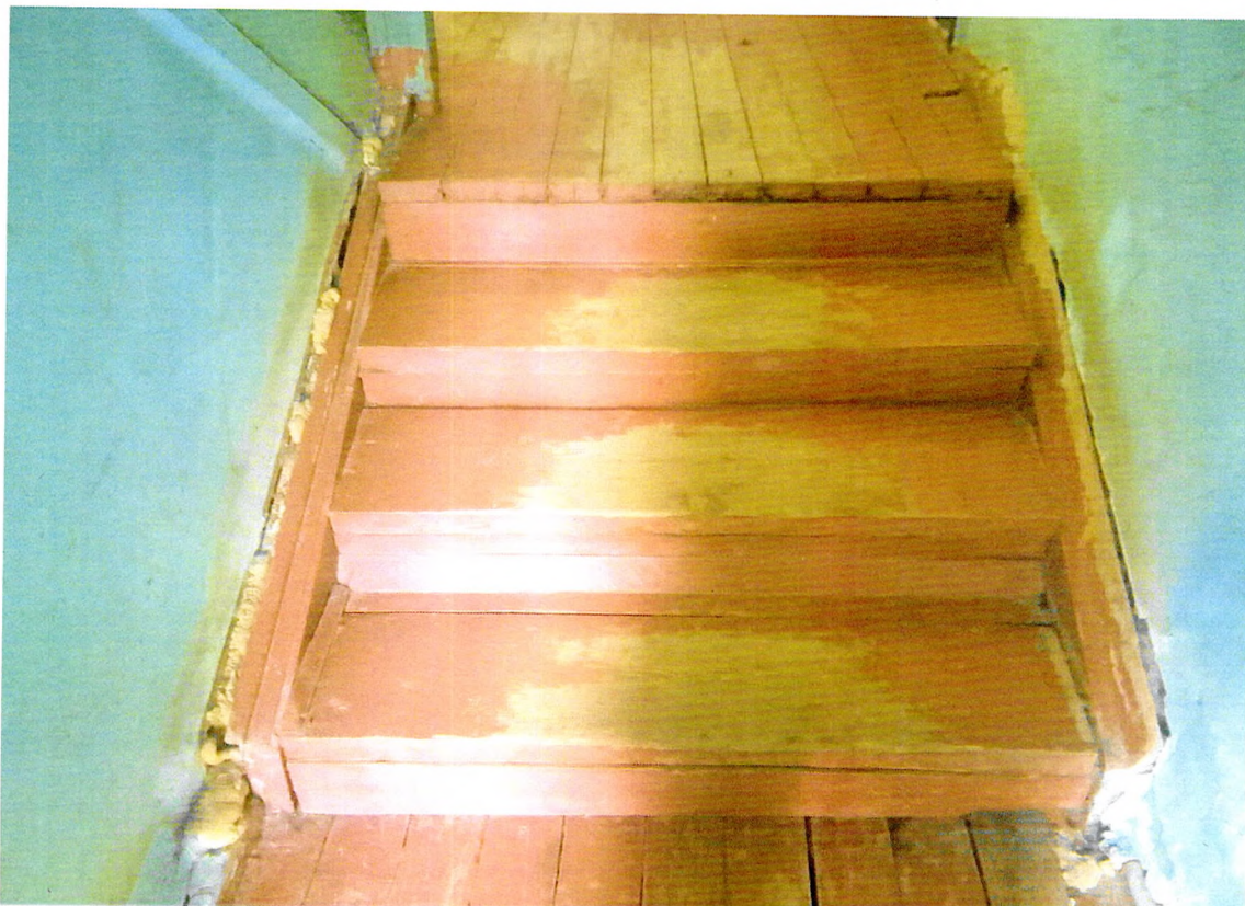
Фото 25. Ступени стерты, трещины вдоль волокон в досках на лестничной площадке и в ступенях.
