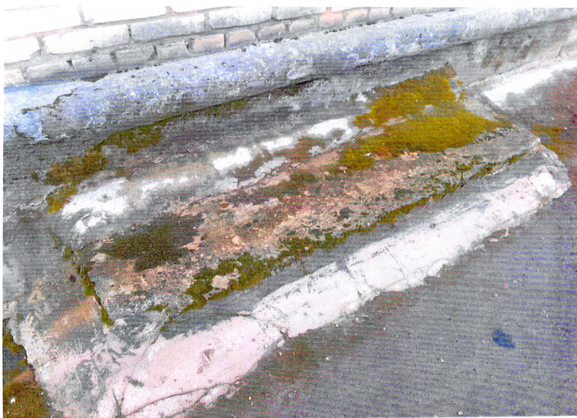
Фото 4. Фрагмент северного фасада. Биоповреждение цоколя и прямка.
