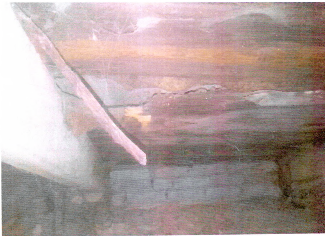
Фото 32. Гниль, разрушение обрешетки.
