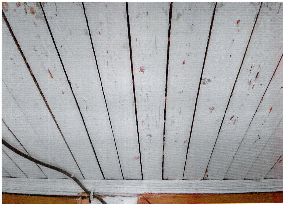
Фото 24. Отслоение окрасочного слоя наката перекрытия над тамбуром.
