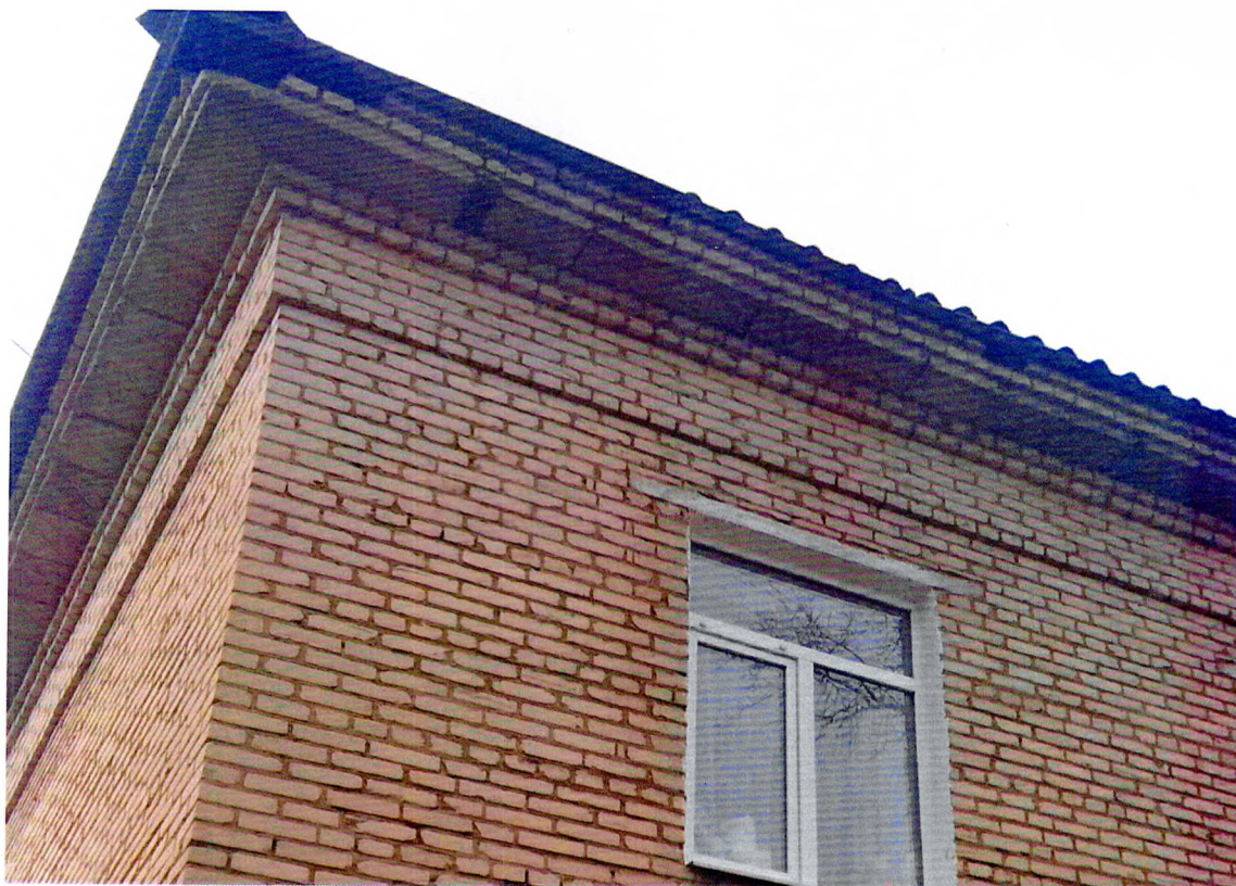
Фото 3. Фрагмент северного фасада. Выпадение отдельных кирпичей из карниза.
