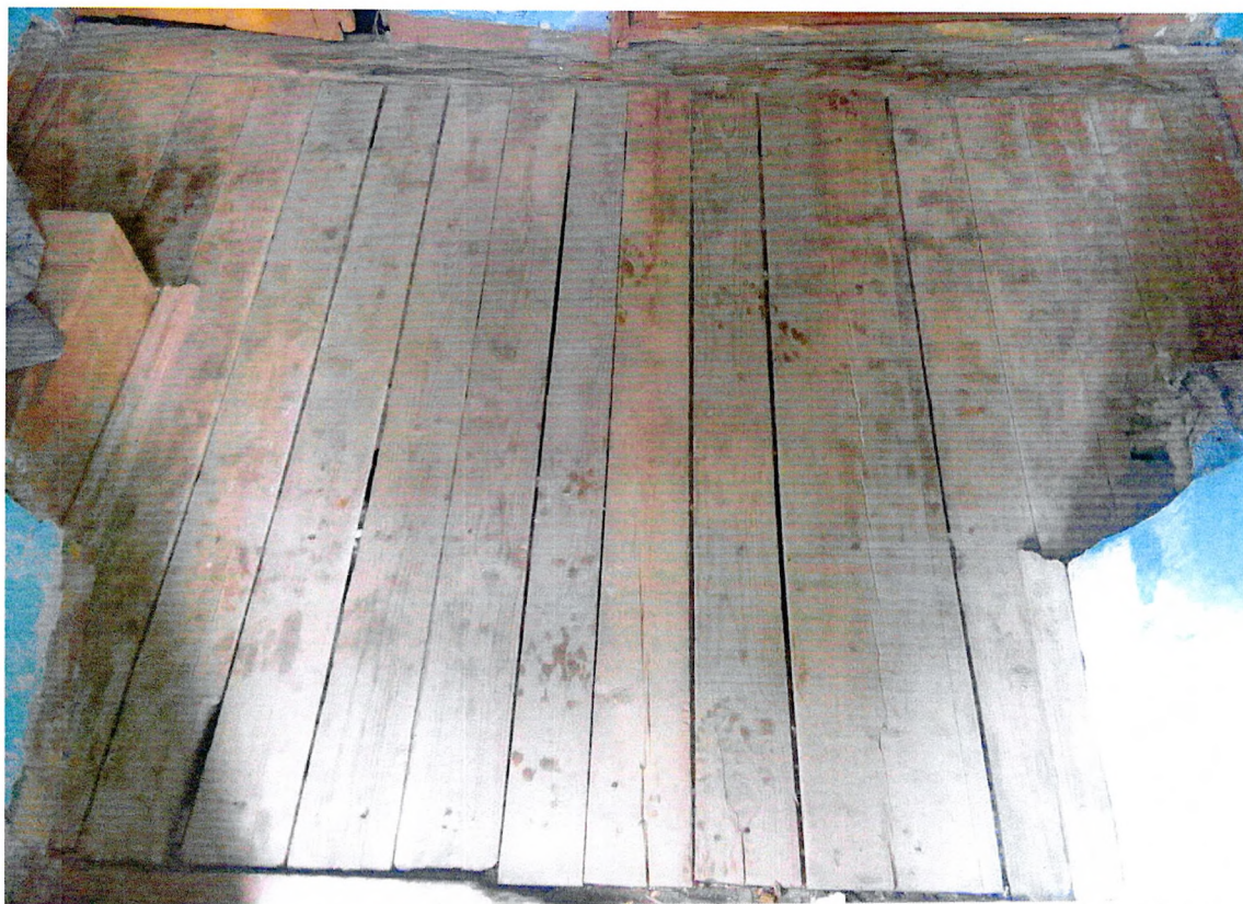
Фото 22. Сколы, щели между досками, утрата окрасочного слоя пола тамбура.
