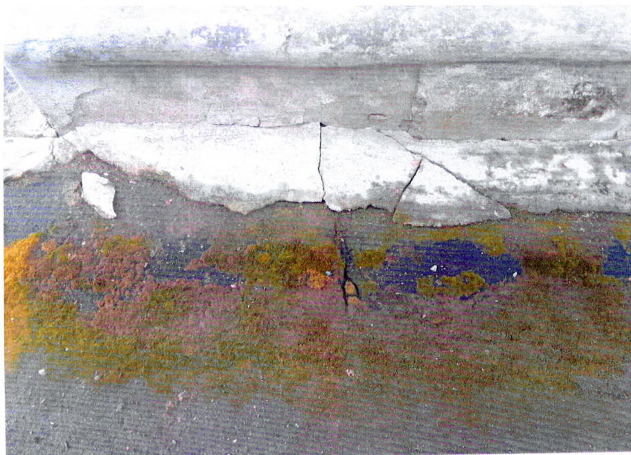
Фото 2. Фрагмент северного фасада. Биоповреждения, трещины в отмостке.
