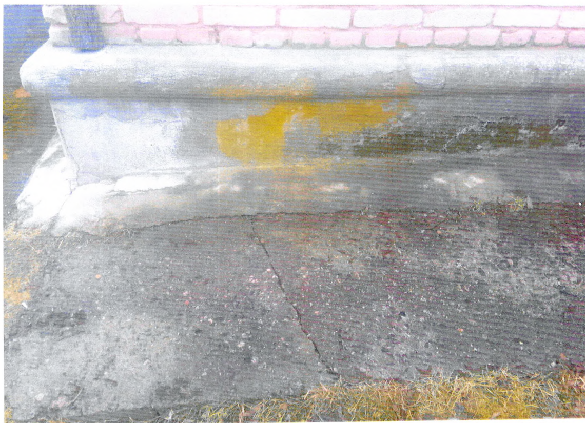
Фото 20. Фрагмент восточного фасада. Биоповреждение, трещины в отмостке.
