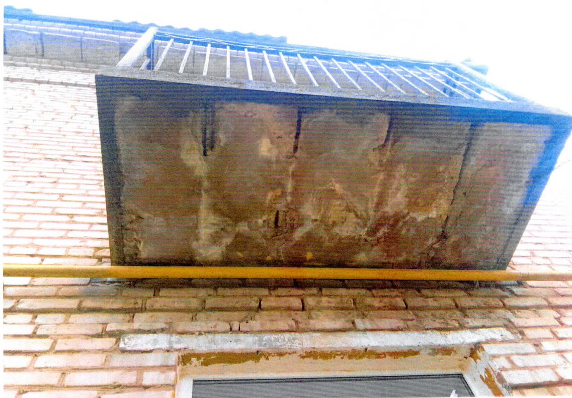
Фото 16. Фрагмент южного фасада. Разрушение защитного слоя бетона, оголение и коррозия арматуры балконной плиты.
