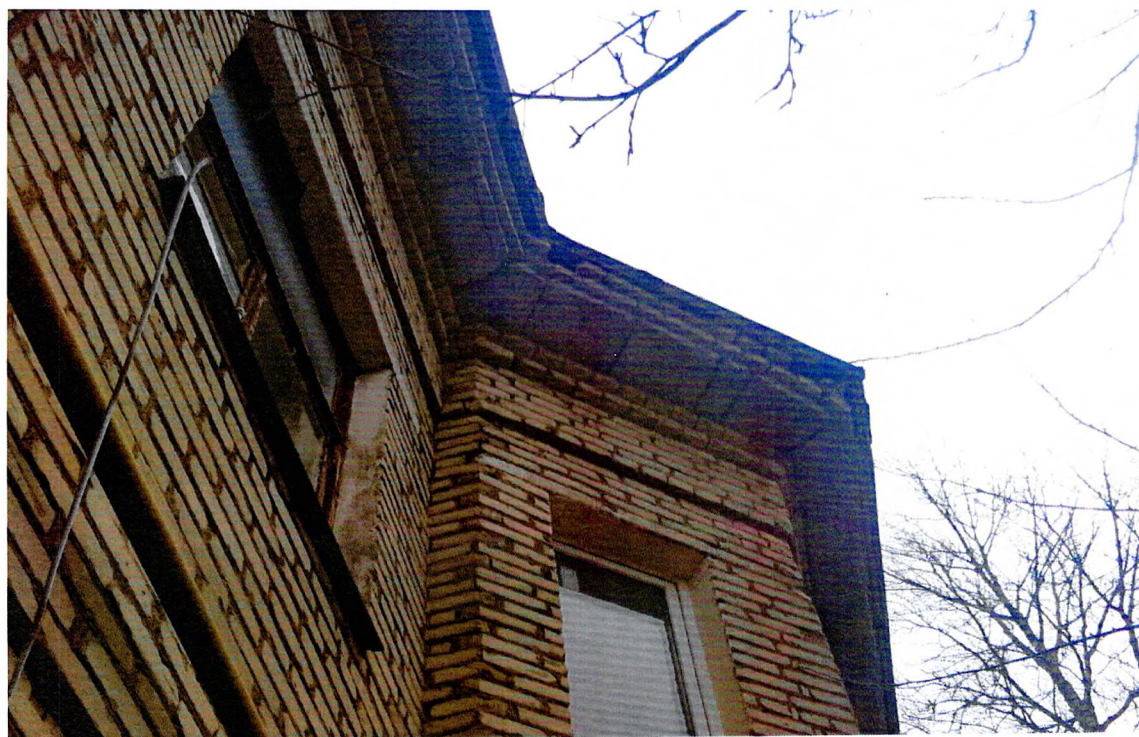
Фото 18. Фрагмент южного фасада. Выпадение отдельных кирпичей из карниза.
