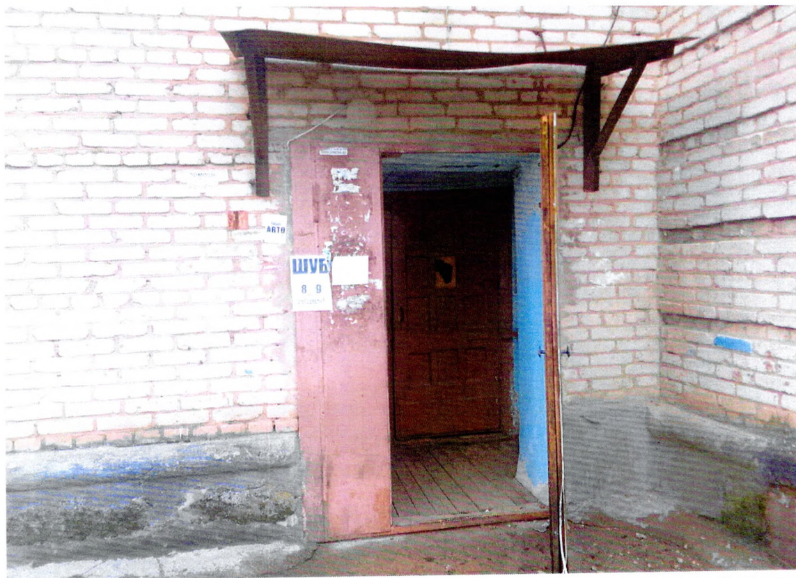
Фото 8. Фрагмент северного фасада. Снятие металлического козырька над входом в здание. Наблюдается коррозия металлического дверного заполнения.
