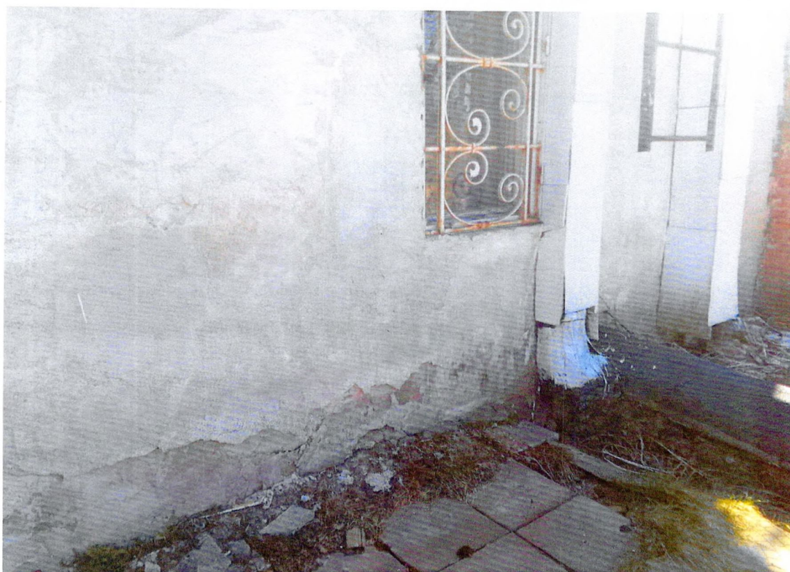
Фото 10. Фрагмент западного фасада. Отпадение штукатурного слоя в цокольной части стены. Коррозия металлических решеток на окнах. Прорастание растений в зоне отмостки.
