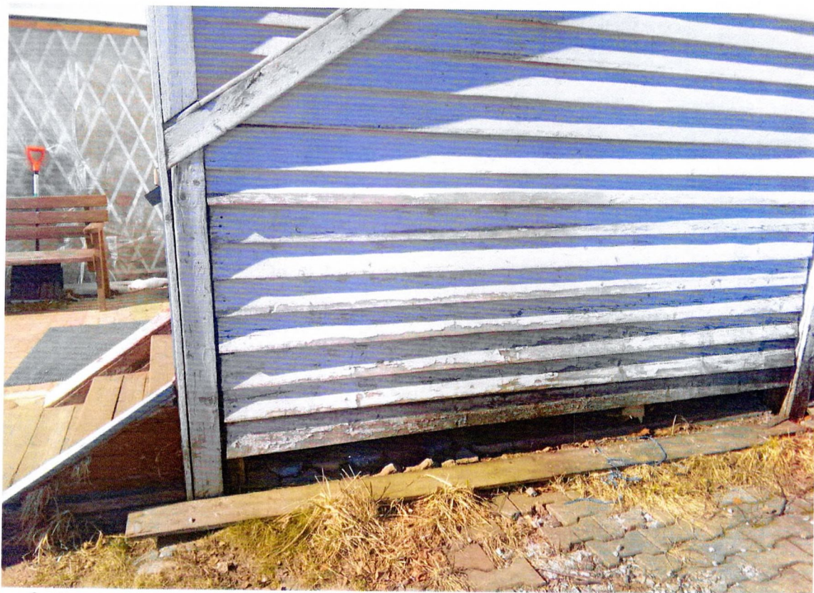
Фото 3. Фрагмент восточного фасада. Отслоение окрасочного слоя деревянных панелей, биоповреждение нижней панели. Прорастание растений в зоне отмоски.
