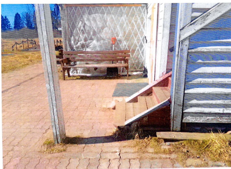
Фото 2. Фрагмент восточного фасада. Прорастание растений в зоне отмостки.
