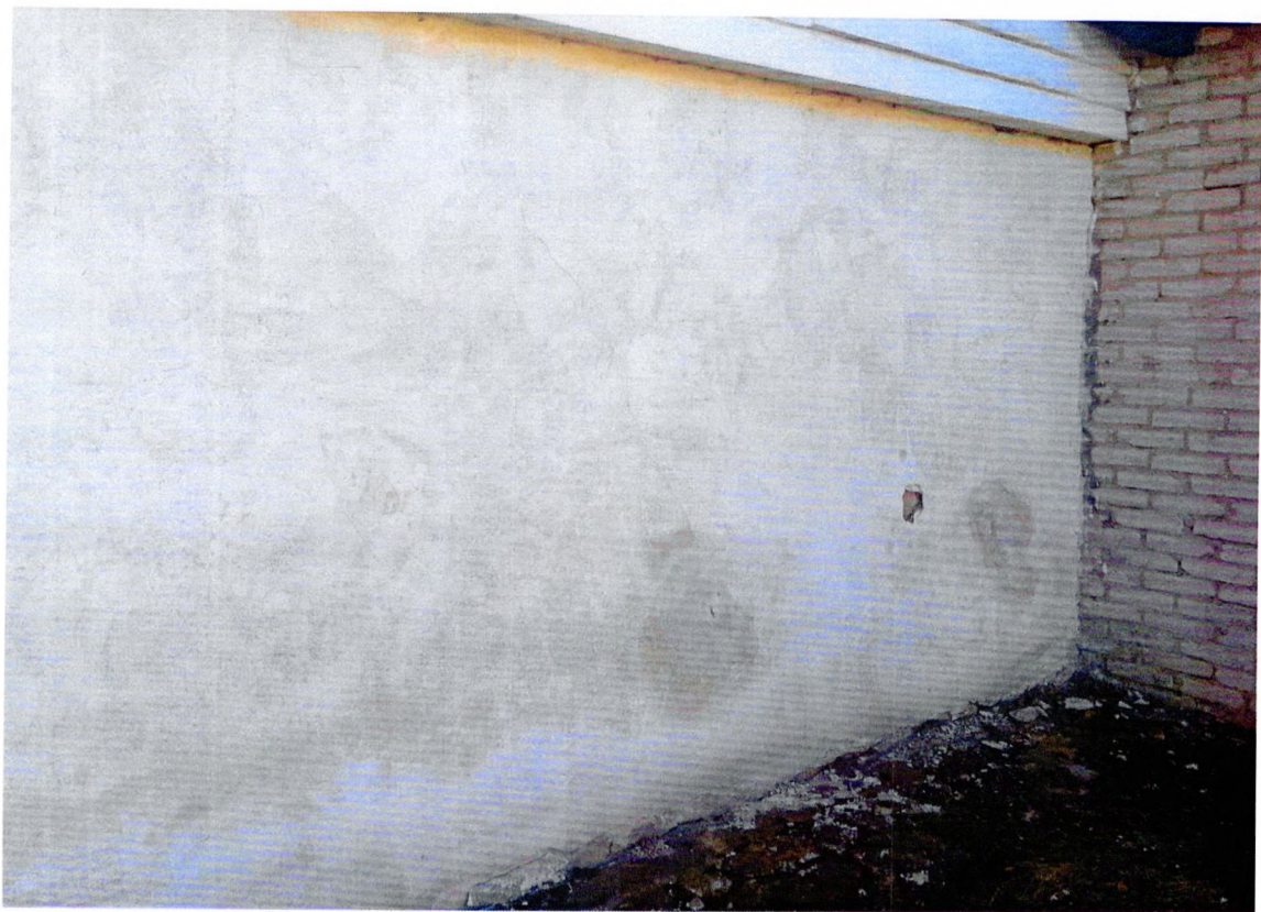
Фото 7. Фрагмент северного фасада. Загрязнение штукатурного слоя стены первого этажа, сколы штукатурного слоя. Биоповреждения отмостки.
