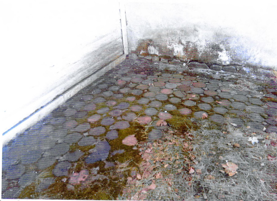
Фото 5. Фрагмент восточного фасада. Следы замкания цокольной части и отмостки, биоповреждения.
