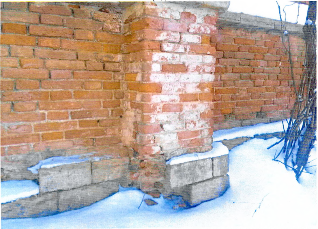
Фото 24. Фрагмент северного фасада. Разрушение цоколя из известняковых плит.
