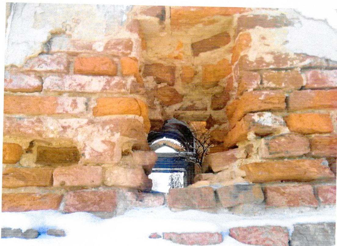
Фото 19. Фрагмент восточного фасада. Сквозное отверстие в кладке.
