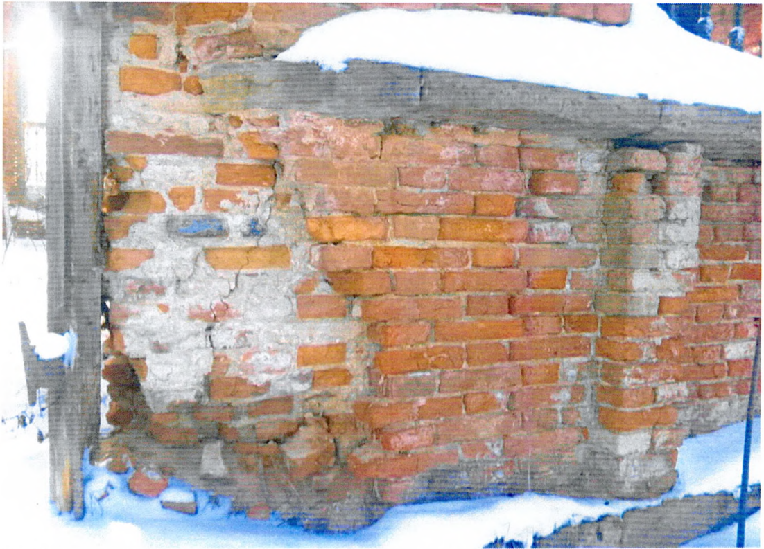
Фото 23. Фрагмент северного фасада. Наклонная трещина раскрытием до 10 мм, пересекающая несколько рядов кладки.
