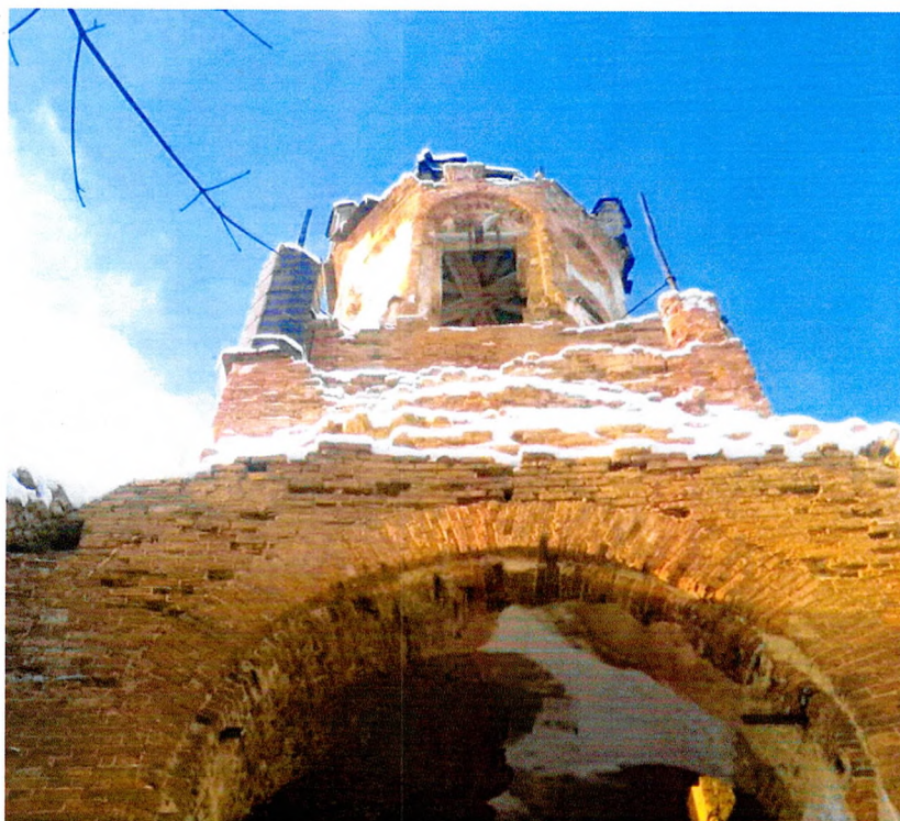
Фото 31. Разрушение каменной кладки четверика, утрата пинакля.
