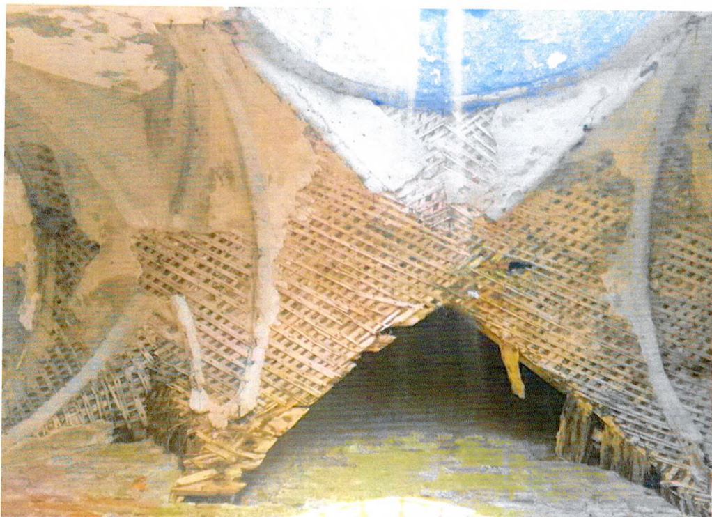
Фото 35. Разрушение конструкций деревянного свода над приделом южной части здания.
