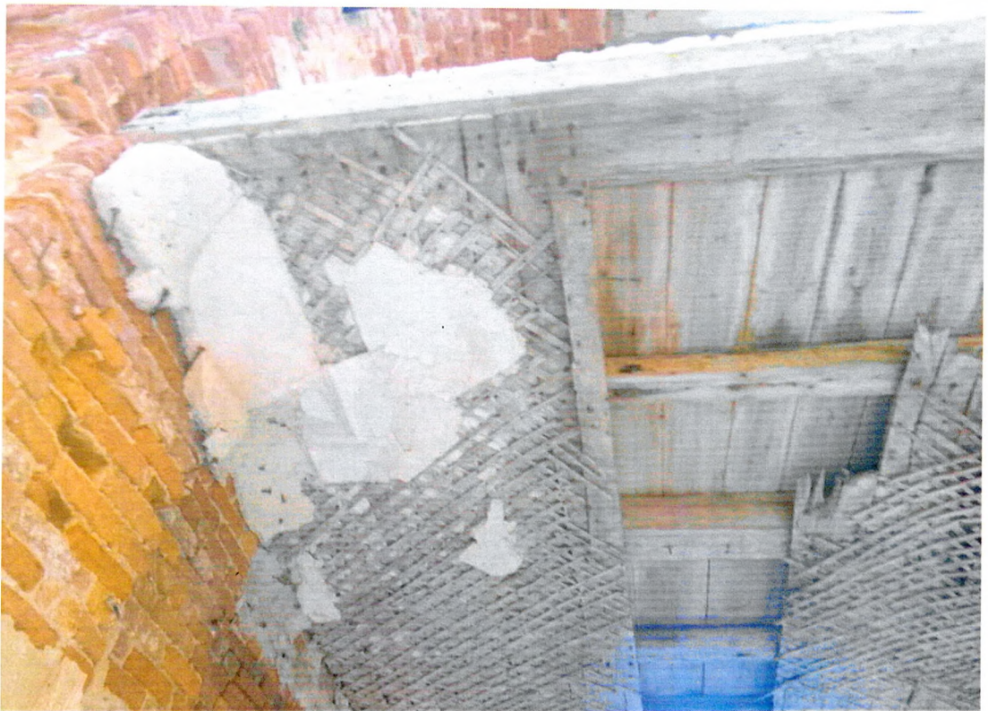
Фото 33. Следы намокания на накате. Обрушение облицовки перекрытия.
