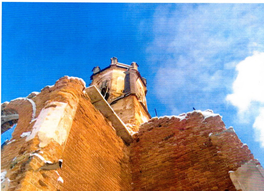
Фото 8. Фрагмент юго-западного фасада. Разрушение кирпичной кладки в верхней части здания, выпадение кирпичей. Сохранившиеся карнизные плиты.
