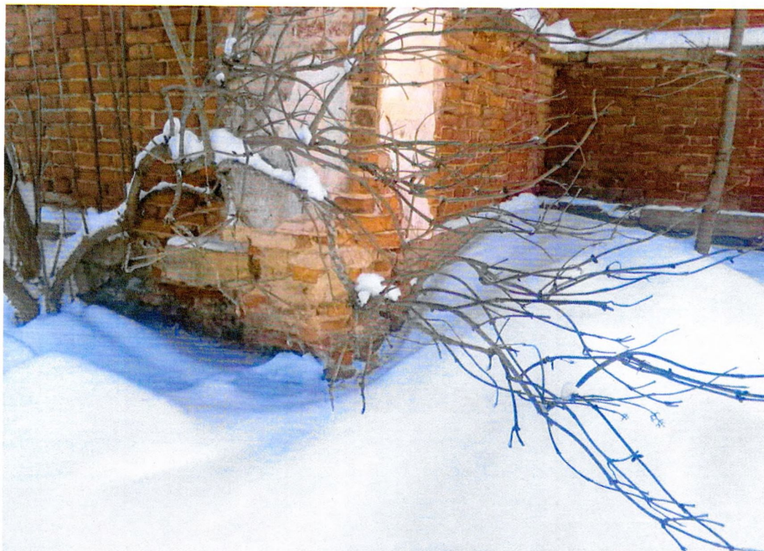
Фото 26. Фрагмент северного фасада. Прорастание кустарников в зоне примыкания к фундаменту здания.
