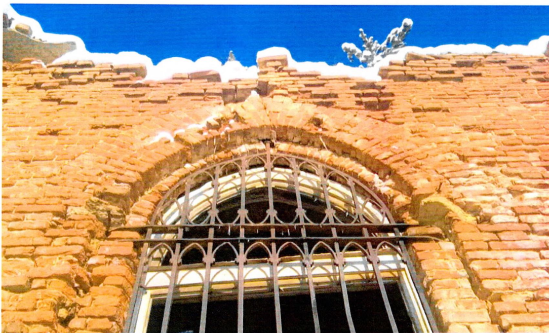
Фото 18. Фрагмент юго-восточного фасада. Разрушение кирпичной кладки стрельчатой перемычки.
