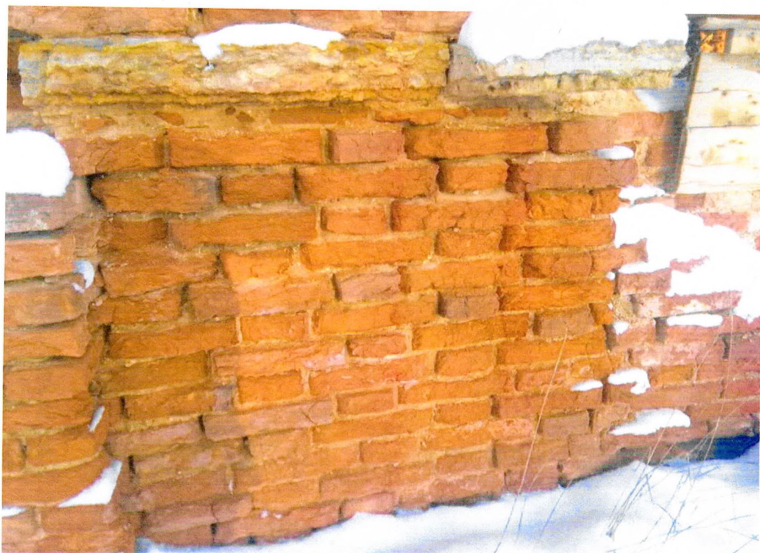
Фото 14. Фрагмент южного фасада. Морозная деструкция кладки. Разрушение карниза из известняковых плит.
