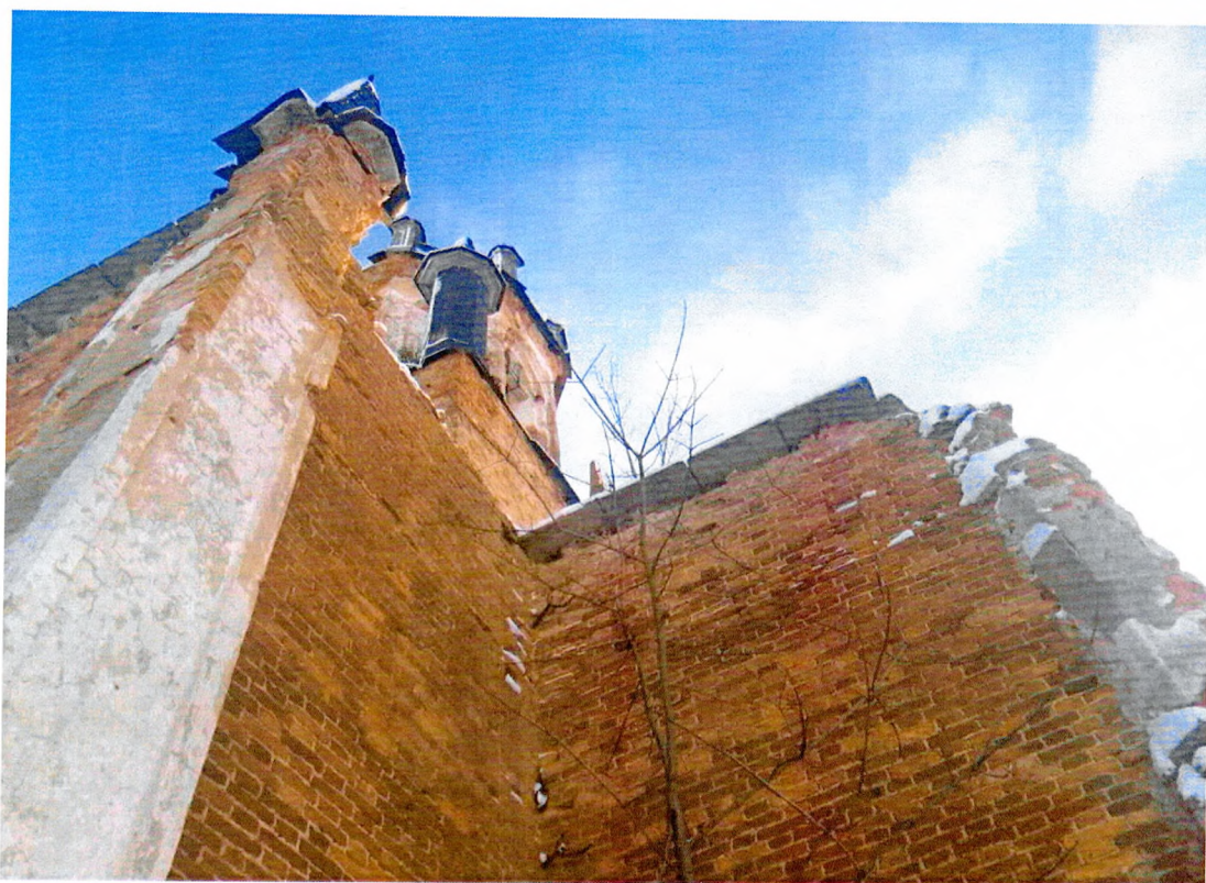
Фото 27. Фрагмент северо-западного фасада. Разрушение кирпичной кладки в верхней части здания, выпадение кирпичей. Сохранившиеся карнизные плиты.
