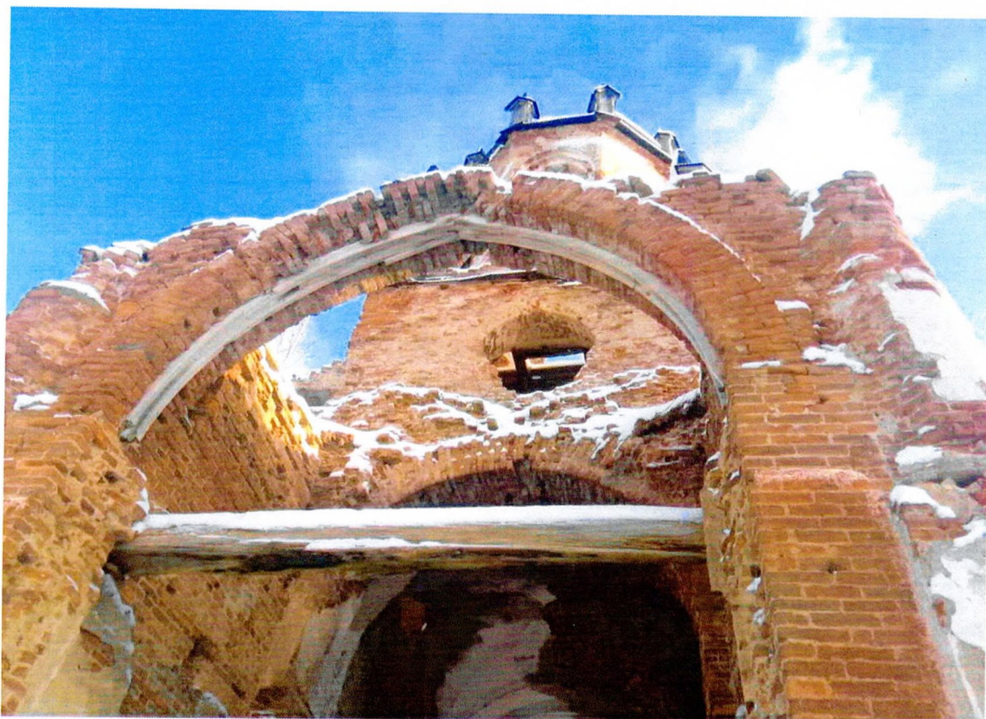
Фото 7. Фрагмент западного фасада. Разрушение кладки стрельчатого проема над входом в здание, утрата перекрытия и крыши.
