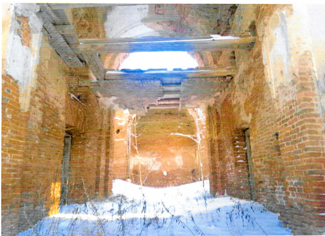
Фото 28. Общий вид внутренних помещений. Прорастание деревьев и кустарников.
