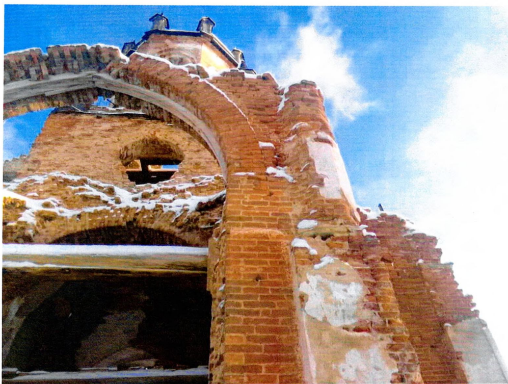
Фото 6. Фрагмент западного фасада. Утрата пинаклей над контрфорсами. Разрушение штукатурки и кладки контрфорсов.
