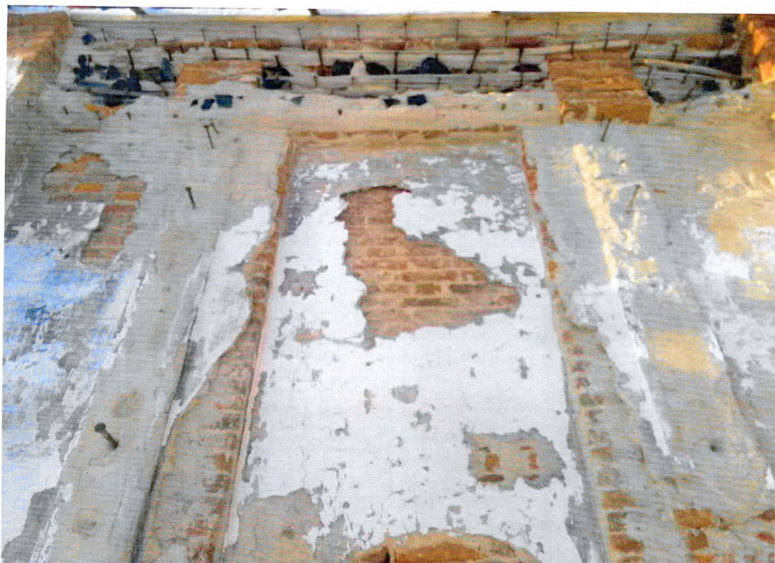
Фото 20. Фрагмент восточного фасада. Разрушение штукатурного слоя.
