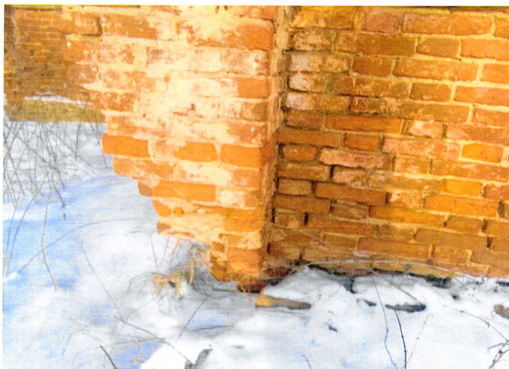
Фото 10. Фрагмент южного фасада. Утрата облицовки из известняковых плит.
