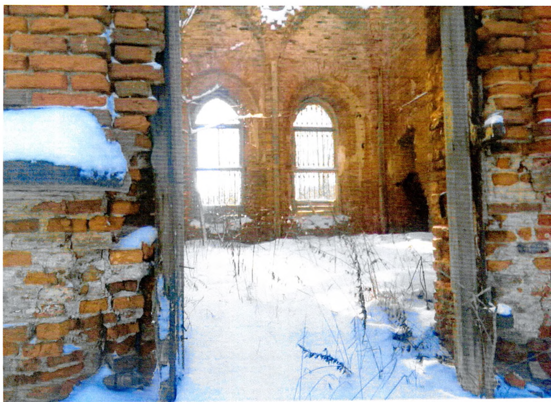
Фото 22. Фрагмент северного фасада. Утраченное дверное заполнение. Гниль древесины дверной коробки.
