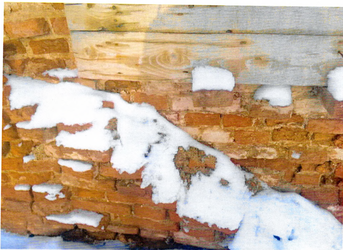
Фото 15. Фрагмент южного фасада. Разрушение наружной версты кладки в подоконной зоне.
