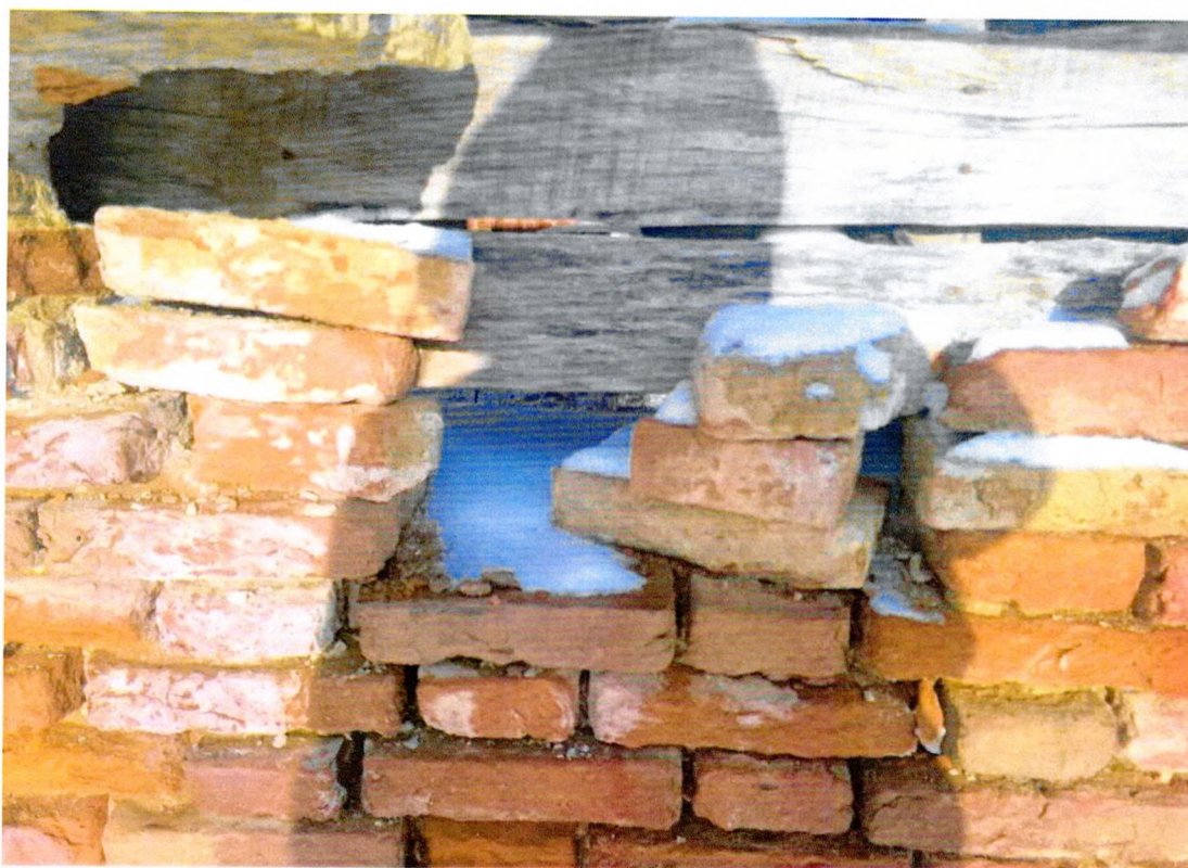
Фото 17. Фрагмент юго-восточного фасада. Кладка подоконной зоны легко разбирается руками.
