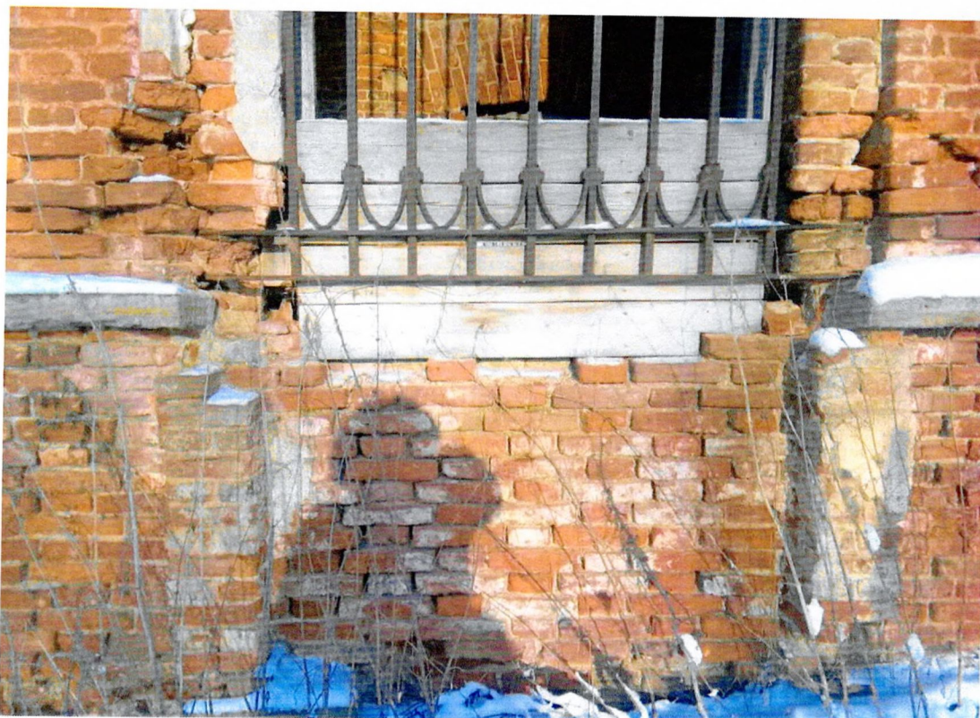
Фото 11. Фрагмент южного фасада. Утрата штукатурки на подоконных нишах.
