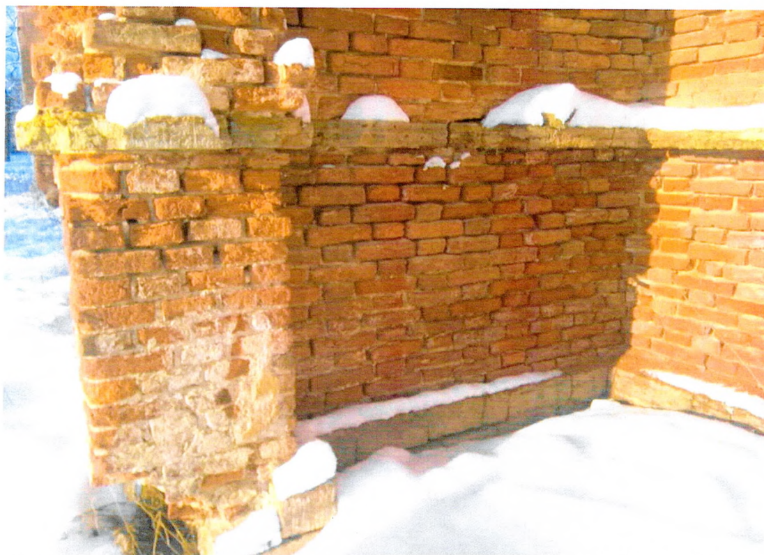
Фото 16. Фрагмент юго-восточного фасада. Разрушение угла здания. Биоповреждения, разрушение карниза из известняковых плит.
