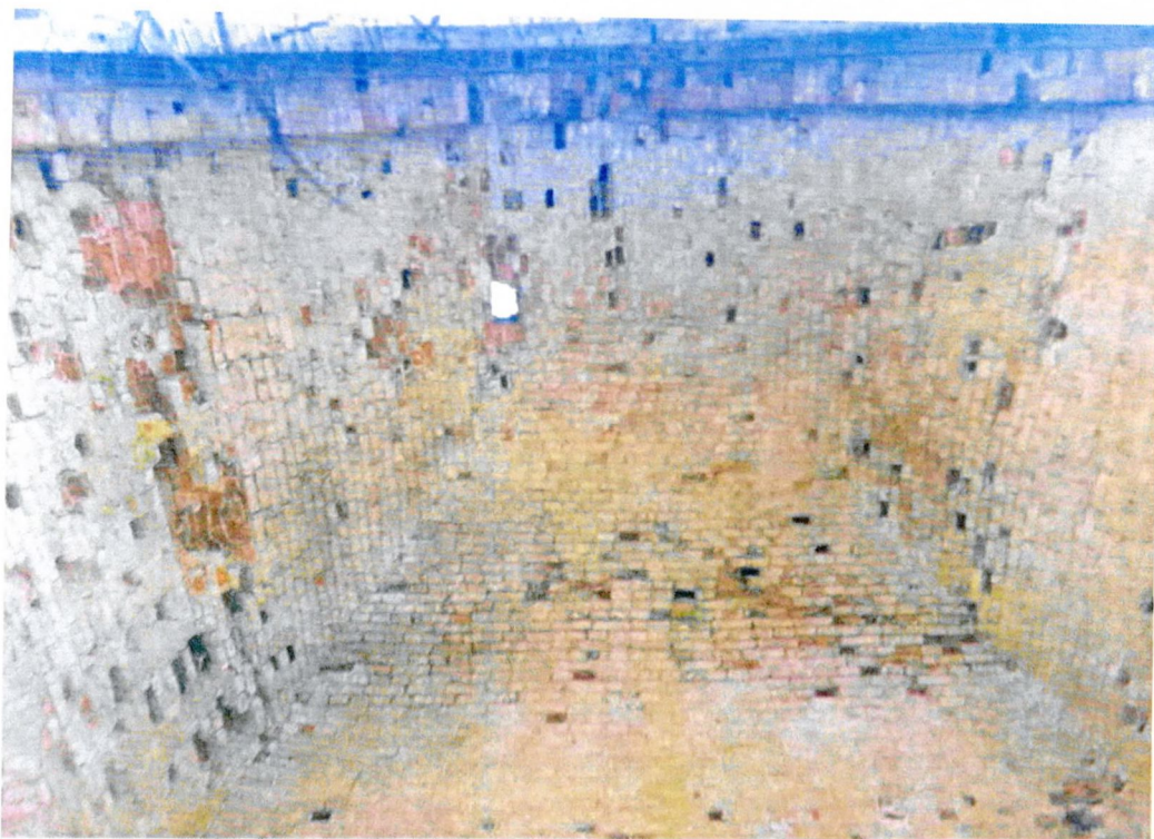
Фото 30. Свод на алтарной зоной. Биоповреждение кладки, выпадение отдельных кирпичей.
