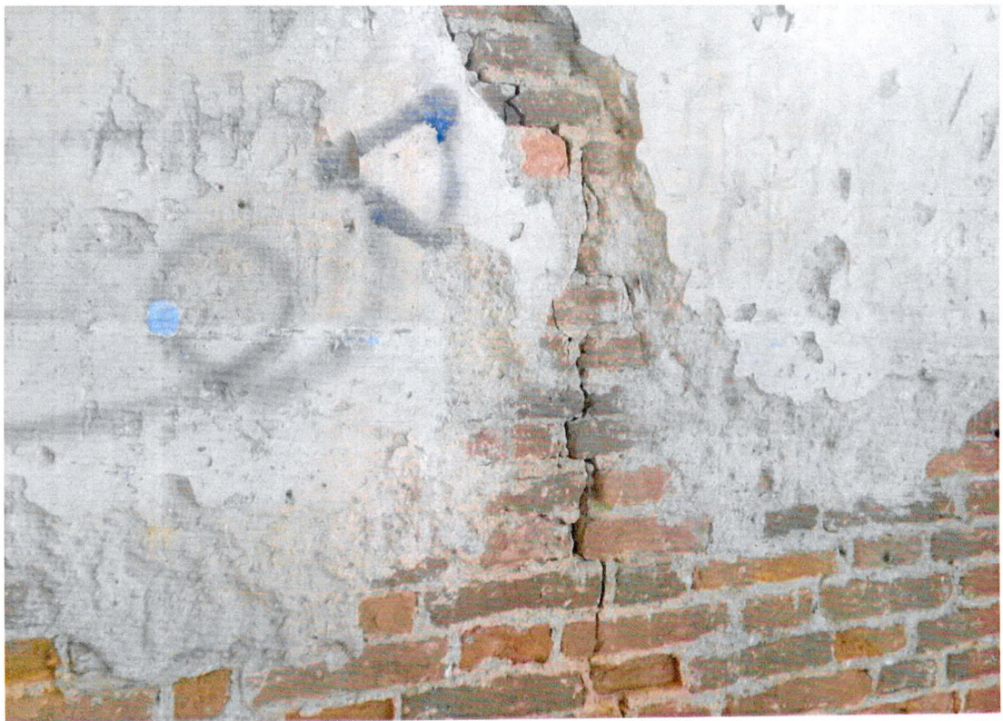
Фото 34. Наклонная трещина раскрытием до 20 мм в кирпичной кладке стены притвора.
