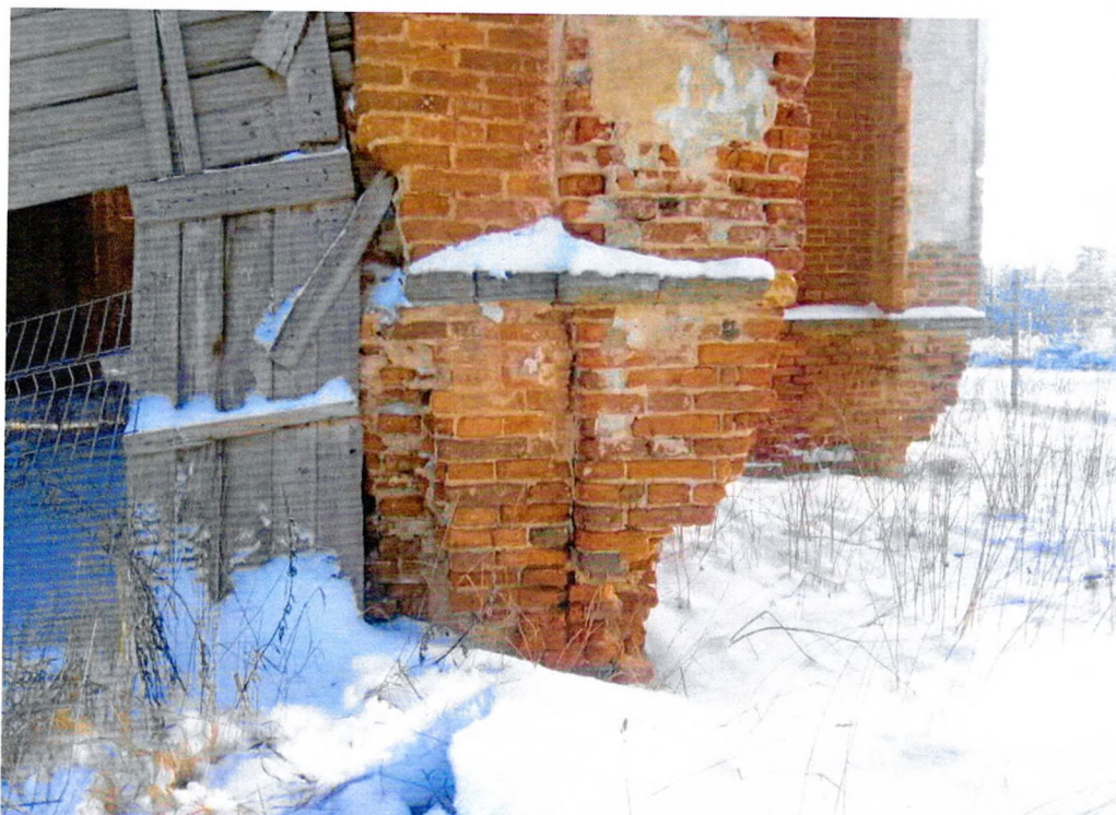
Фото 5. Фрагмент западного фасада. Разрушение кирпичной кладки углов здания.
