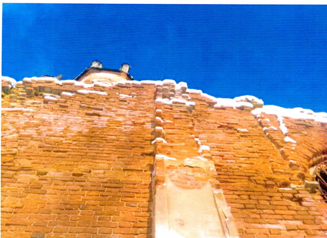
Фото 12. Фрагмент южного фасада. Разрушение каменной кладки в верхней части стены и на контрфорсах.
