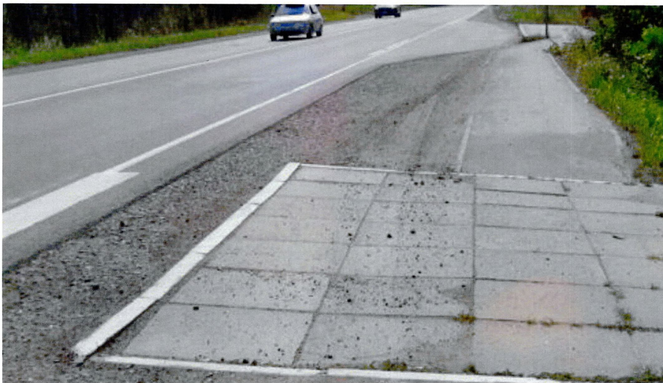
Фото 10. Сопряжение вымостки территории памятника с тротуаром, обочиной и автодорогой.
