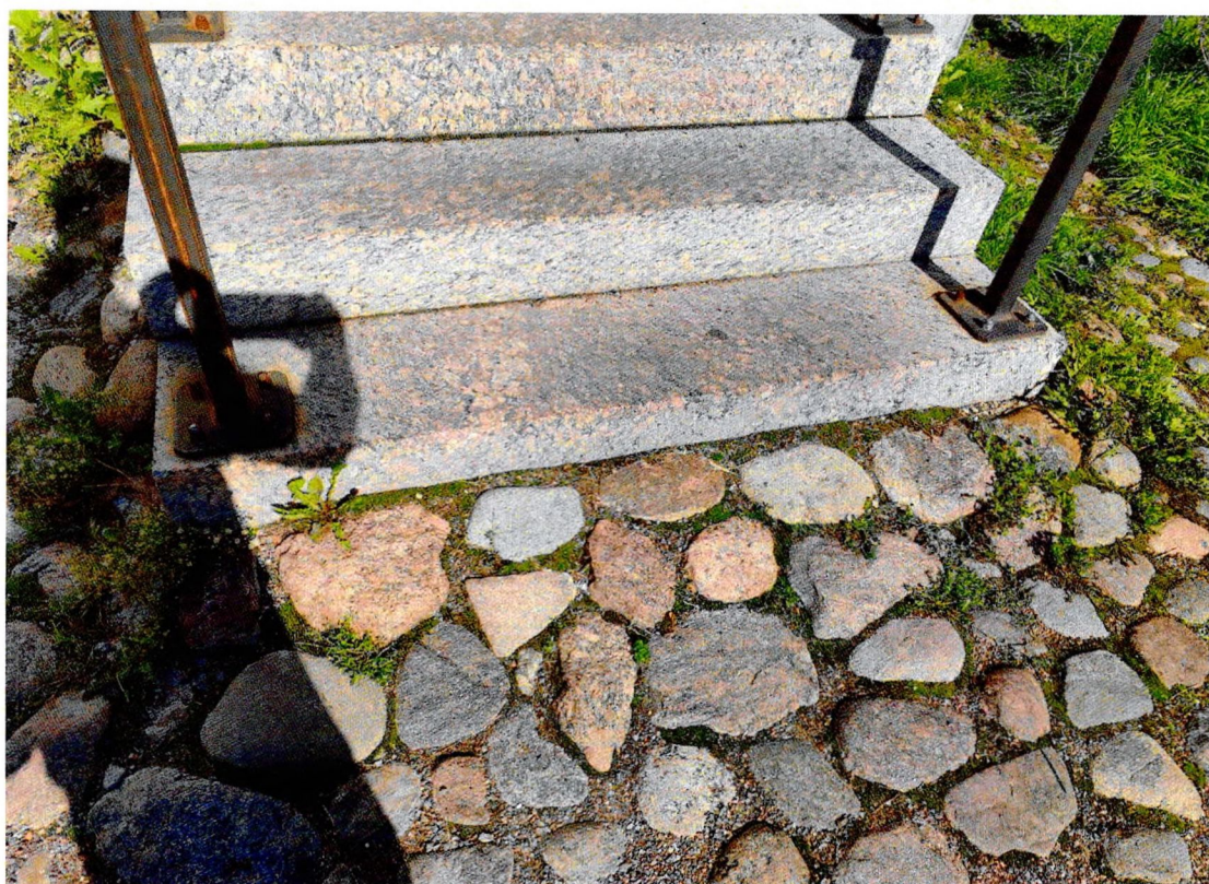
Фото 12. «Дом купеческой гильдии», зафиксирована коррозия на перильном ограждении входной лестницы.
