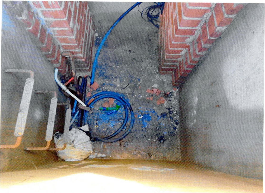
Фото 13. «Дом купеческой гильдии», зафиксированы следы иловых отложений на полу в подвале, наблюдаются увлажненные бетонные и каменные стены подвала.
