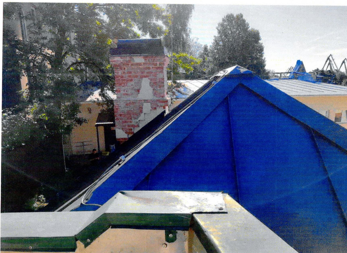
Фото 5. «Дом жилой», отслоение штукатурного слоя от дымовой трубы.
