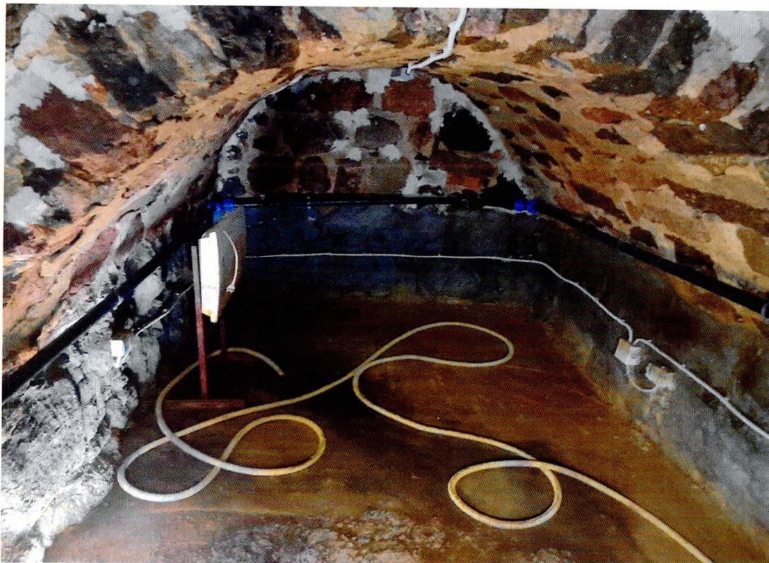
Фото 15. «Дом купеческой гильдии», поврежденная система электрификации в подвальном помещении здания, отсутствует вентиляция в помещении подвала.
