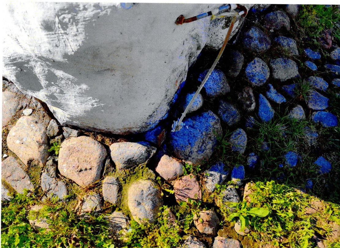
Фото 5. «Дом купеческой гильдии», отмостка заросла сорной растительностью, повреждение молниезащиты в районе цоколя, на северном фасаде.
