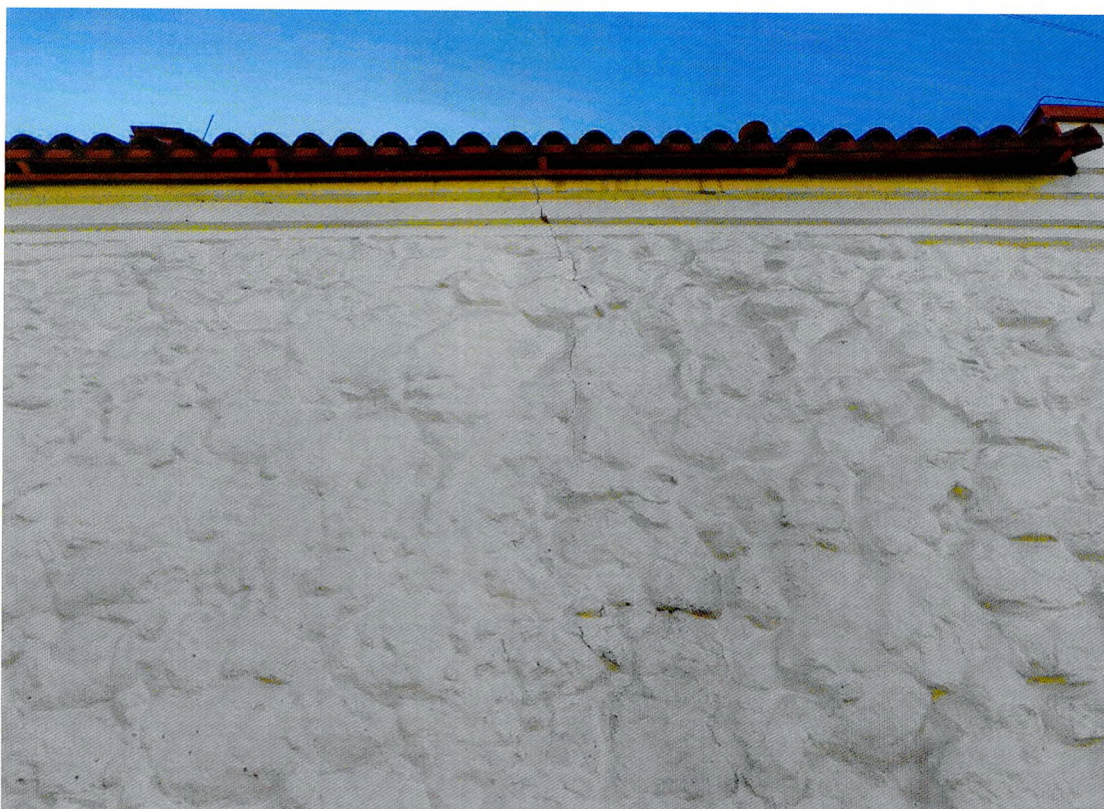
Фото 7. «Дом купеческой гильдии», трещины в штукатурном слое на северном фасаде здания.
