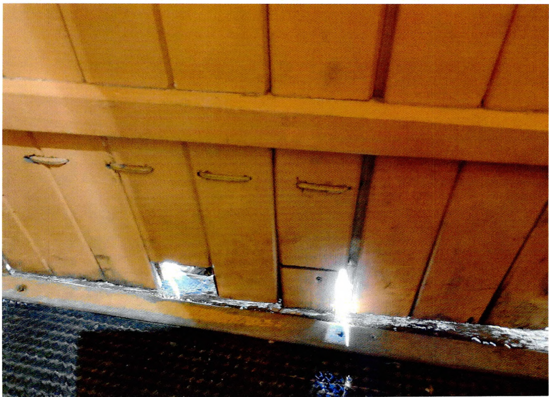
Фото 10. «Дом купеческой гильдии», зафиксированы следы гниения деревянного полотна уличной двери.
