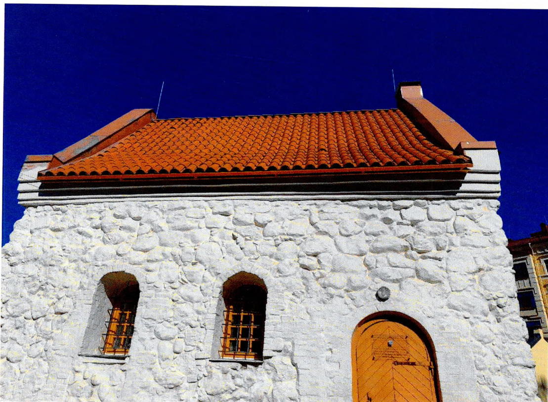
Фото 3. «Дом купеческой гильдии», общий вид южного фасада здания, утрата двух кровельных керамических черепичных плиток на крыше.
