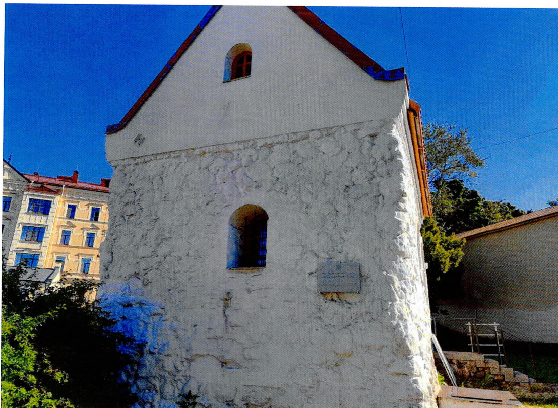
Фото 1. «Дом купеческой гильдии», общий вид западного фасада здания, слабочитаемые надписи на памятной доске, отслоение лакокрасочных материалов с металлических элементов кровли.
