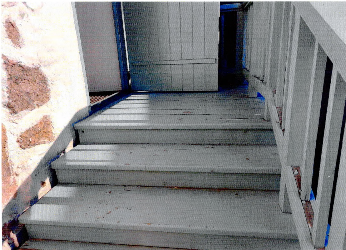
Фото 9. «Дом жилой», отслоение лакокрасочного покрытия от крыльца с восточного восточный фасада здания.
