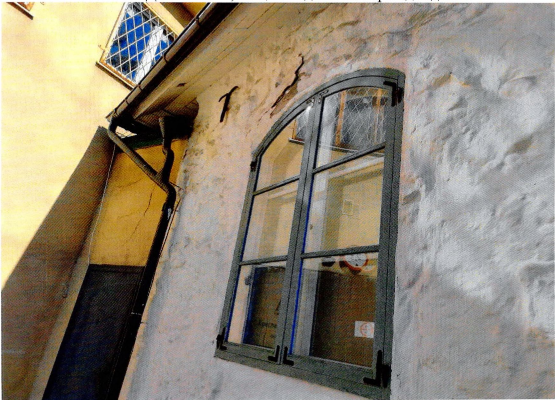
Фото 2. «Дом жилой», отслоение лакокрасочного покрытия с фасада здания.
