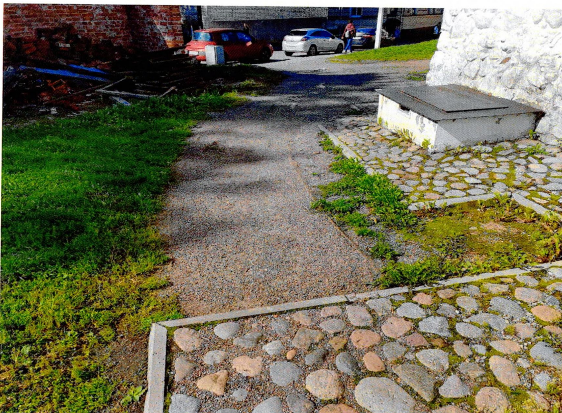
Фото 11. «Дом купеческой гильдии», зафиксированы следы просадка набивного покрытия дорожки.
