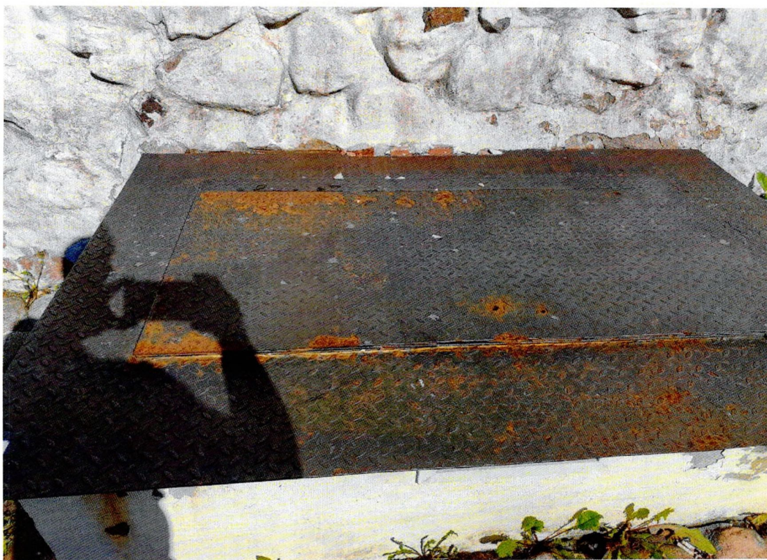
Фото 16. «Дом купеческой гильдии», зафиксированы следы коррозии на металлической двери подвала, отслоение лакокрасочного покрытия от стены здания.
