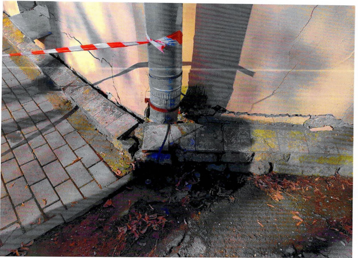
Фото 13. Фрагмент северо-восточного фасада: разрушение цоколя
