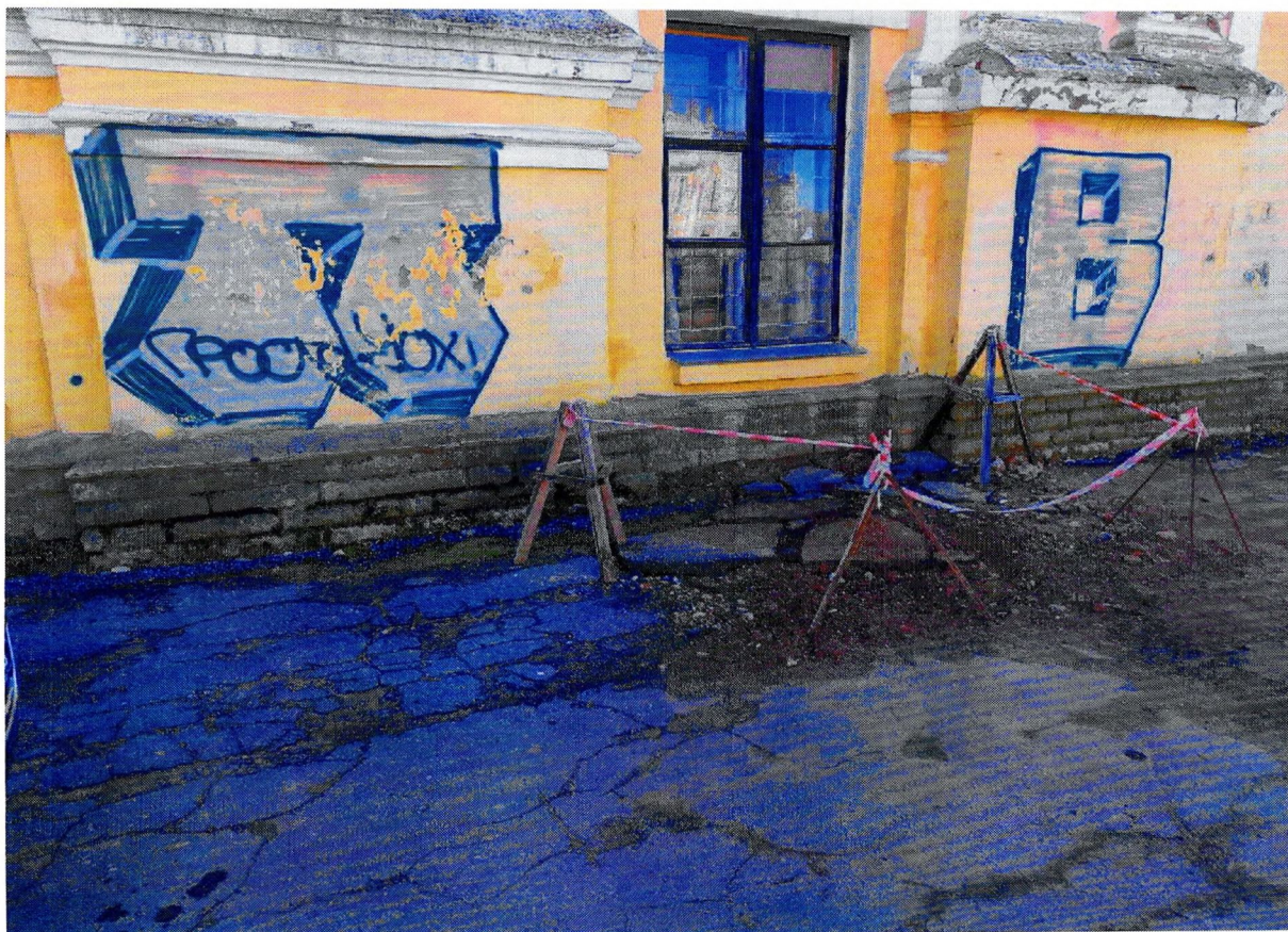
Фото 18. Граффити на северо-западном фасаде, разрушение штукатурного слоя, биопоражения цоколя
