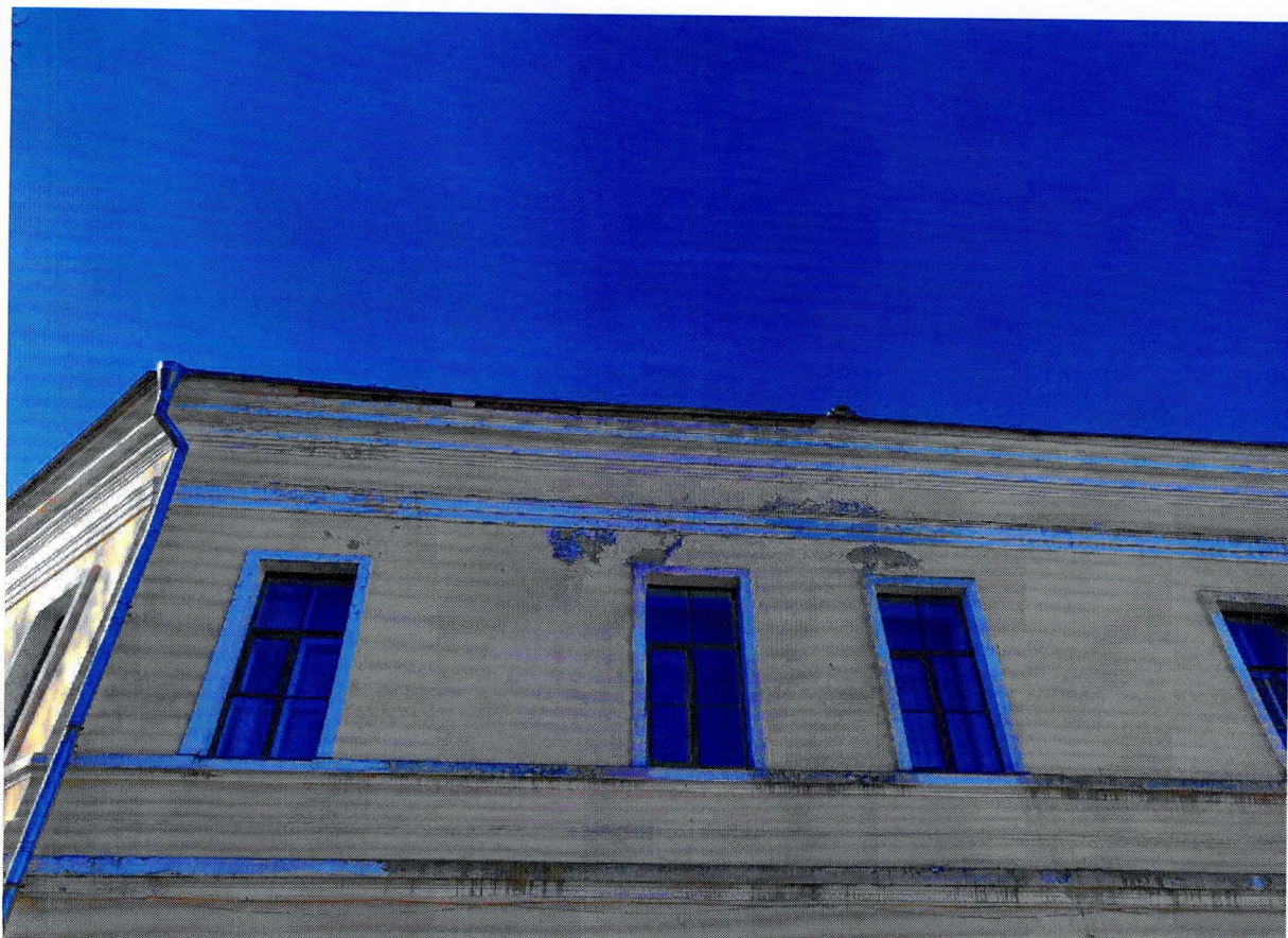
Фото 17. Фрагмент северо-восточного фасада: разрушения отделочных слоев и части декоративных элементов
