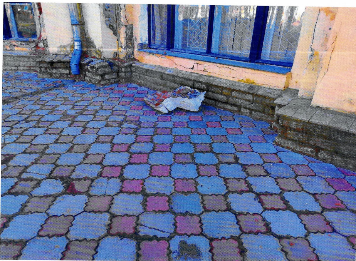
Фото 7. Фрагмент юго-западного фасада: обрушившаяся часть архитектурного декора
