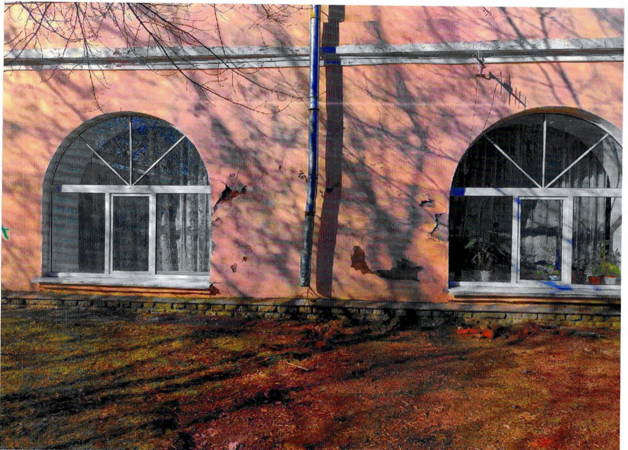
Фото 15. Фрагмент северо-восточного фасада: фрагментарное разрушение отделочных слоев
