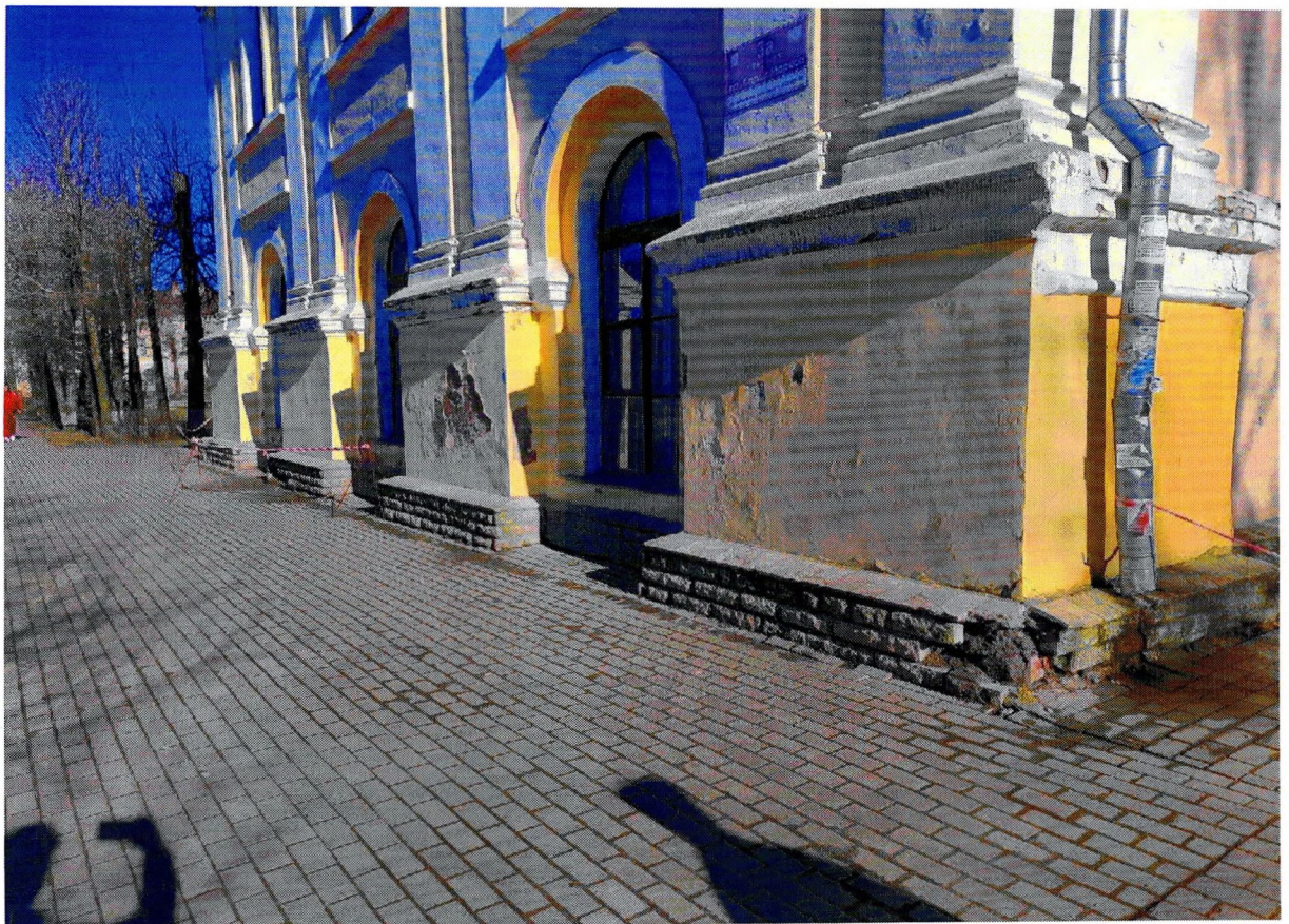
Фото 4. Фрагмент южного фасада: разрушение цоколя, отслоение штукатурного слоя
