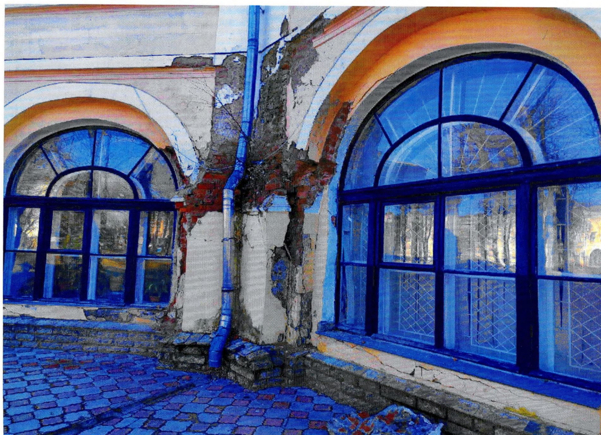
Фото 6. Фрагмент юго-западного фасада: разрушения штукатурки и части декоративных элементов
