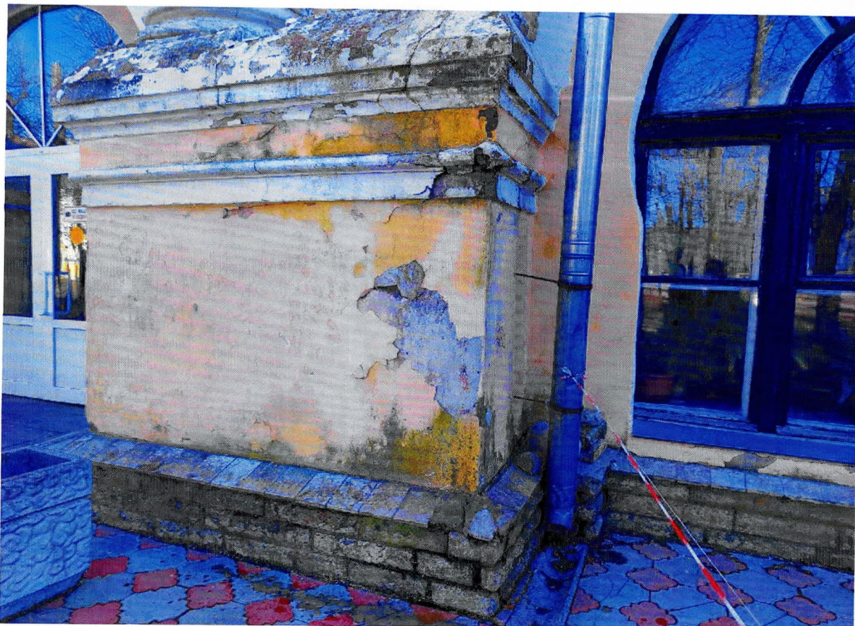
Фото 9. Фрагмент юго-западного фасада: разрушения штукатурки и части декоративных элементов, биопоражения
