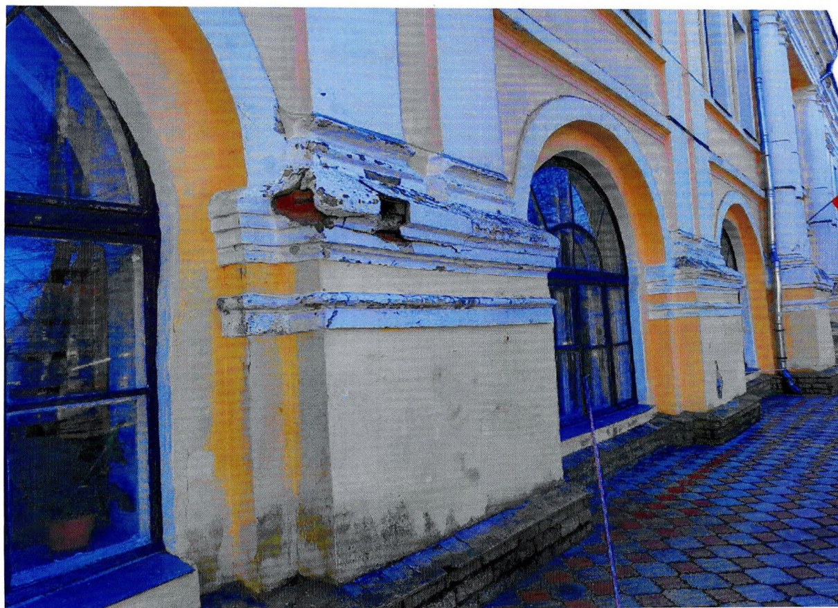
Фото 12. Фрагмент юго-западного фасада: разрушения штукатурки и части декоративных элементов
