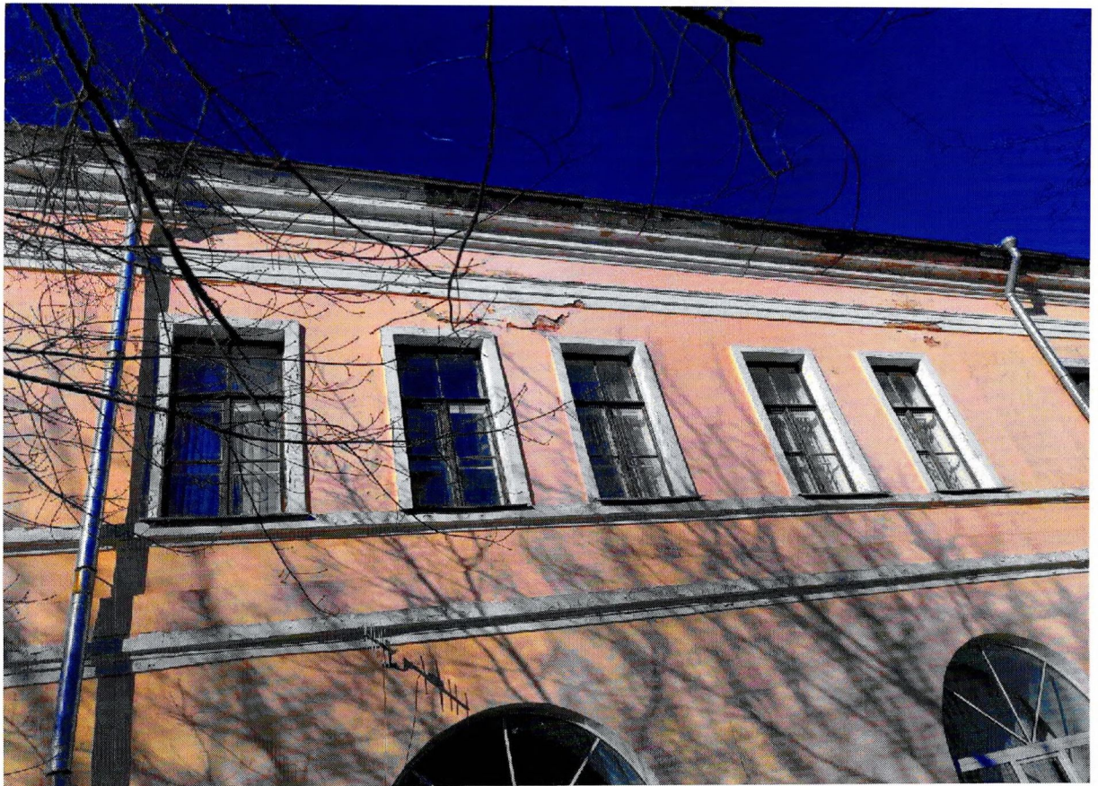
Фото 14. Фрагмент северо-восточного фасада: фрагментарное разрушение отделочных слоев и части декоративных элементов
