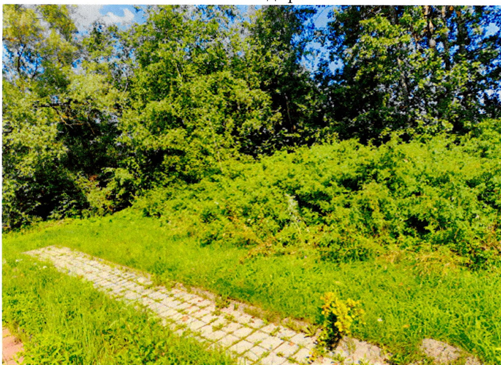
Фото 14. Фрагмент дорожки из бетонной плитки вокруг памятника с восточной стороны. Повсеместное порастание самосевными растениями, неровность поверхности, мелкие сколы и трещины в плитке.
