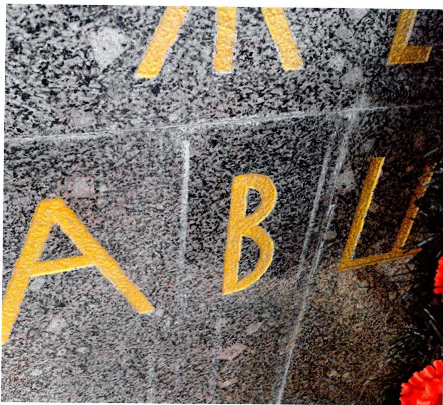
Фото 9. Фрагмент лицевой стороны мемориальной плиты. Заметны подтеки, антропогенные загрязнения нарушения герметичности швов; шелушение красочного слоя букв.
