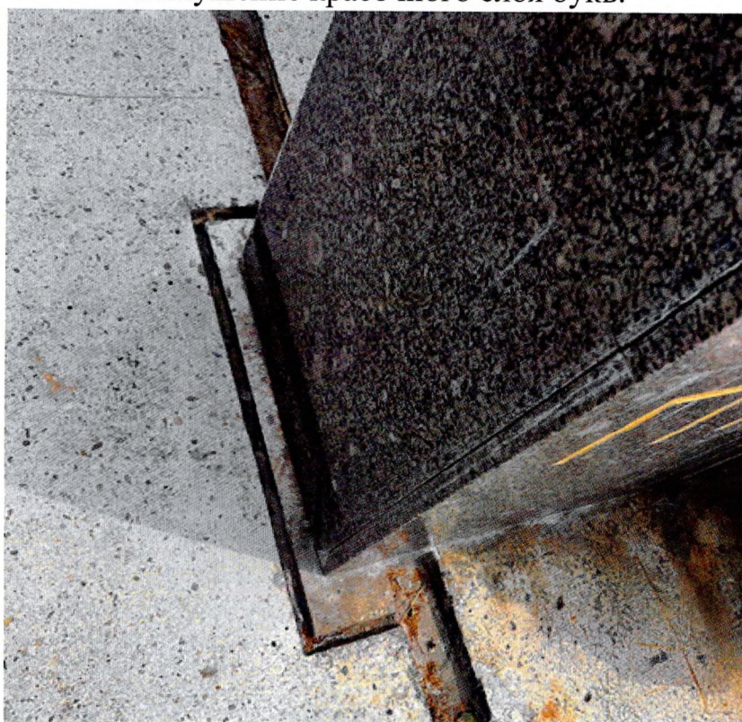
Фото 10. Фрагмент северного торца мемориальной плиты. Присутствуют пустоты в стыках гранитных плит и в местах примыкания гранитных плит к бетонному покрытию стилобата, подтеки и антропогенные загрязнения на граните.
