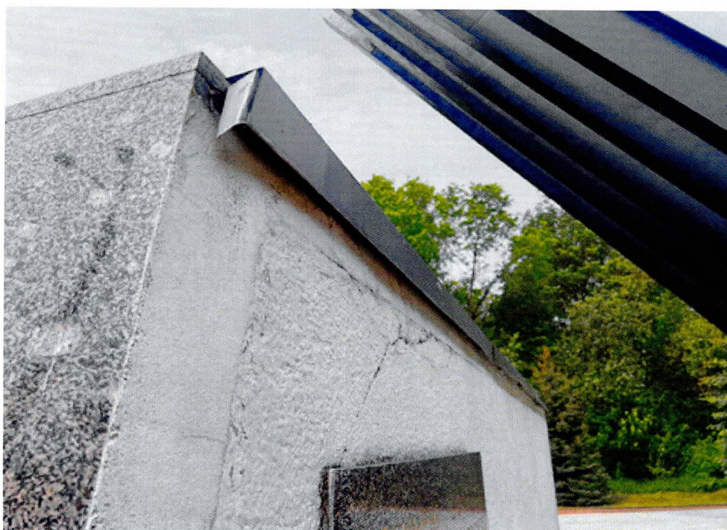
Фото 8. Фрагмент обратной стороны мемориальной плиты (с юга). Заметны сколы по ребру плиты, трещины в штукатурном слое, истирание и шелушение красочного слоя.
