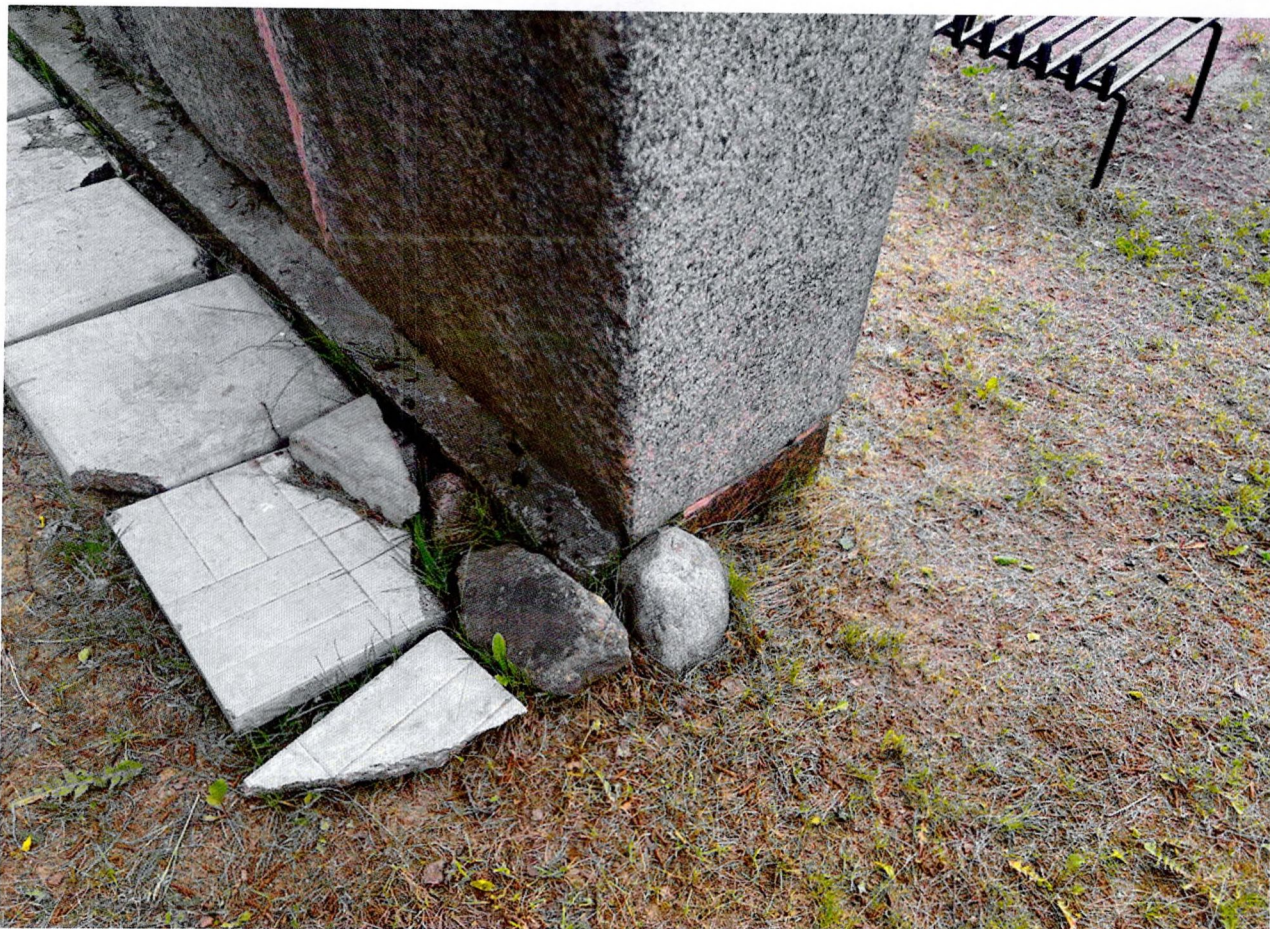
Фото 25. Вид на мемориальную плиту. Многочисленные сколы тротуарной плитки отмостки.
