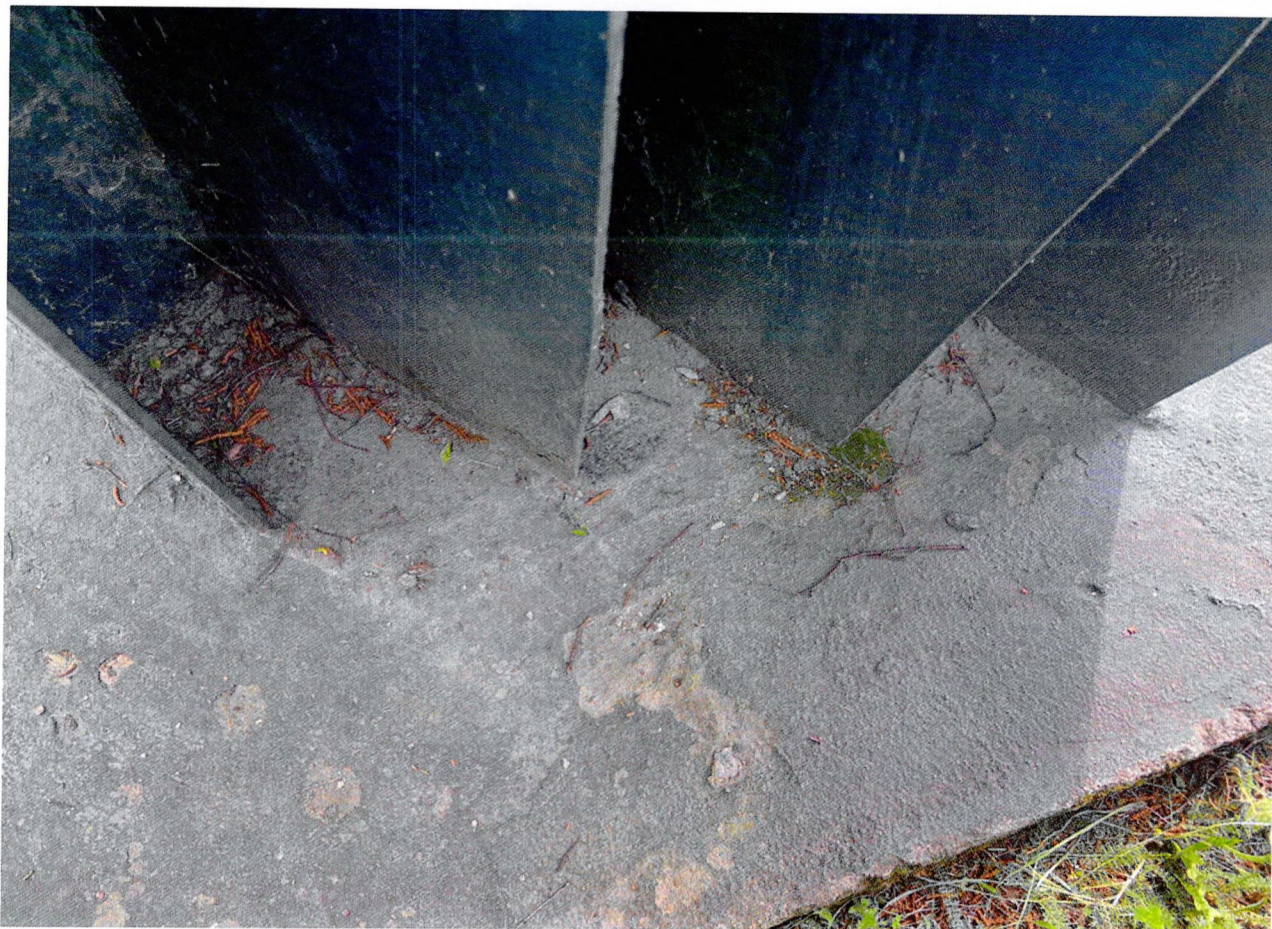
Фото 15. Вид на лавровый лист. Следы биопоражений на железобетонном основании.
