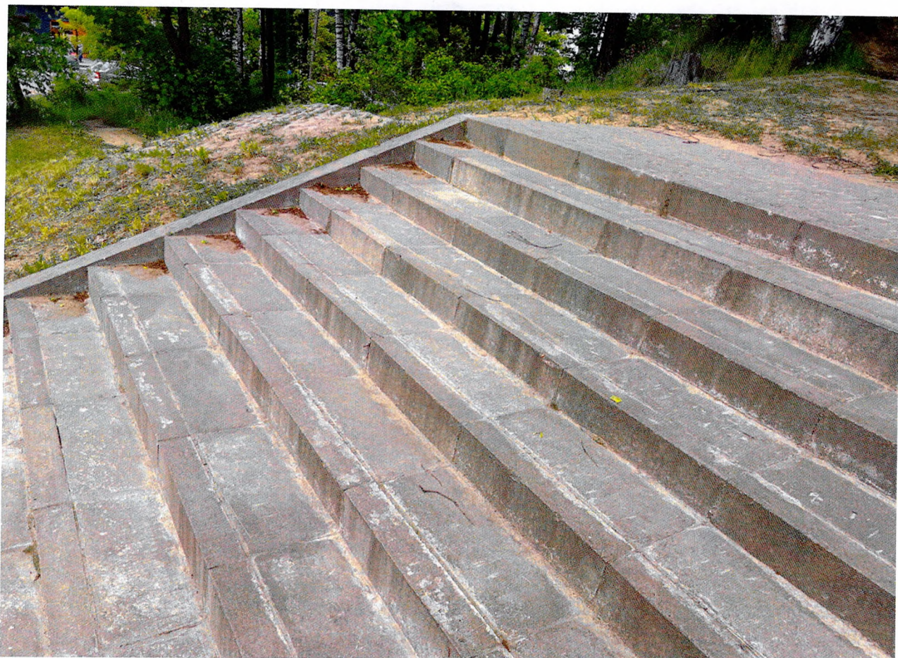
Фото 27. Вид на западную лестницу. Следы антропогенных загрязнений, выветривание шовного раствора, высолы.
