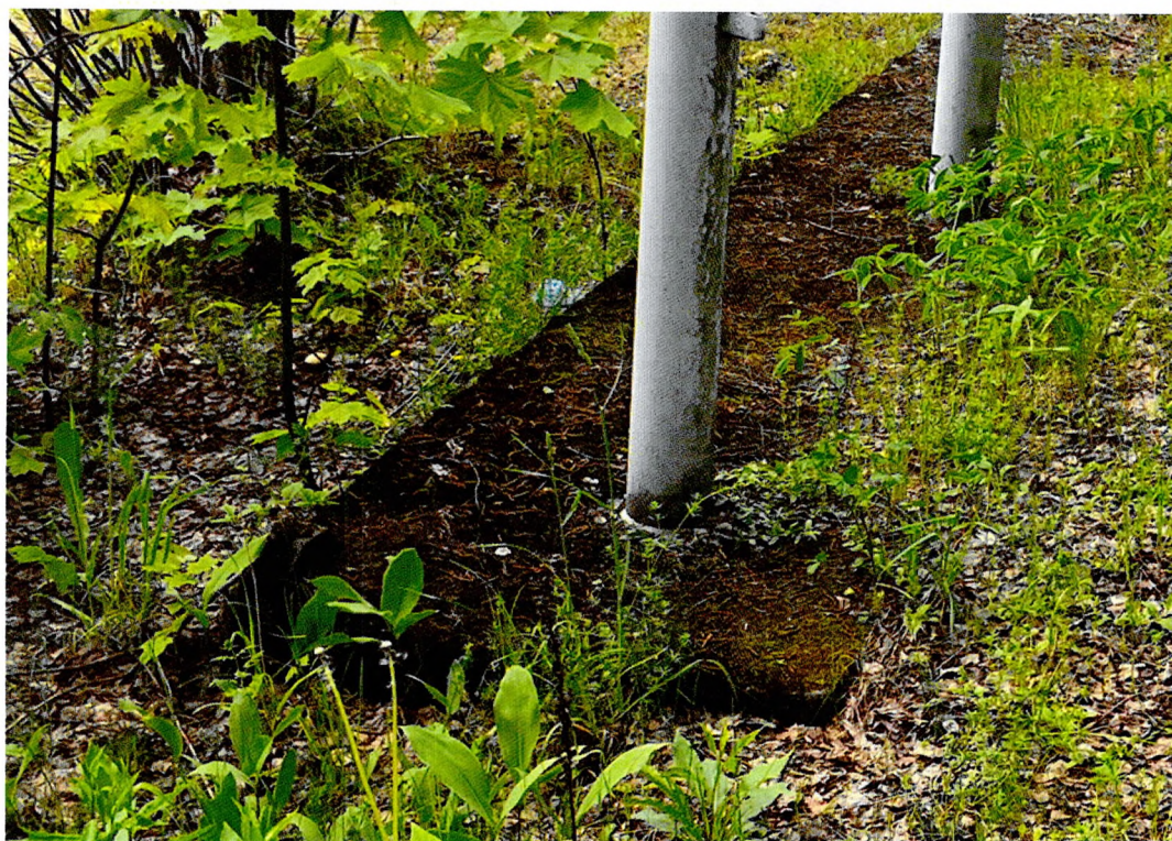
Фото 28. Вид на флагштоки. Следы биопоражений, сколы железобетонного основания, следы коррозии металла трубы флагштока.
