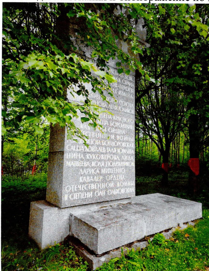
Фото 35. Памятная стела 3. Ремонтные поновления цементными растворами. Поверхностные пылеватые(сажистые) загрязнения. Сколы и трещины гранитных блоков. Образование трещин и зазоров по швам между отдельными блоками постаментов. Следы намокания и биопоражение по монументу.
