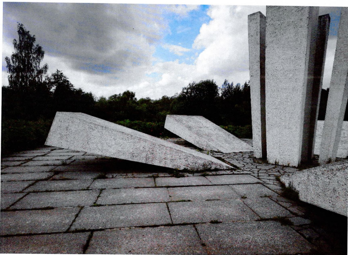
Фото 26. Площадка доминанты «Каменный цветок». Произрастание растительности в швах плит. Биопоражения элементов монумента. Общее загрязнение поверхности камня.
