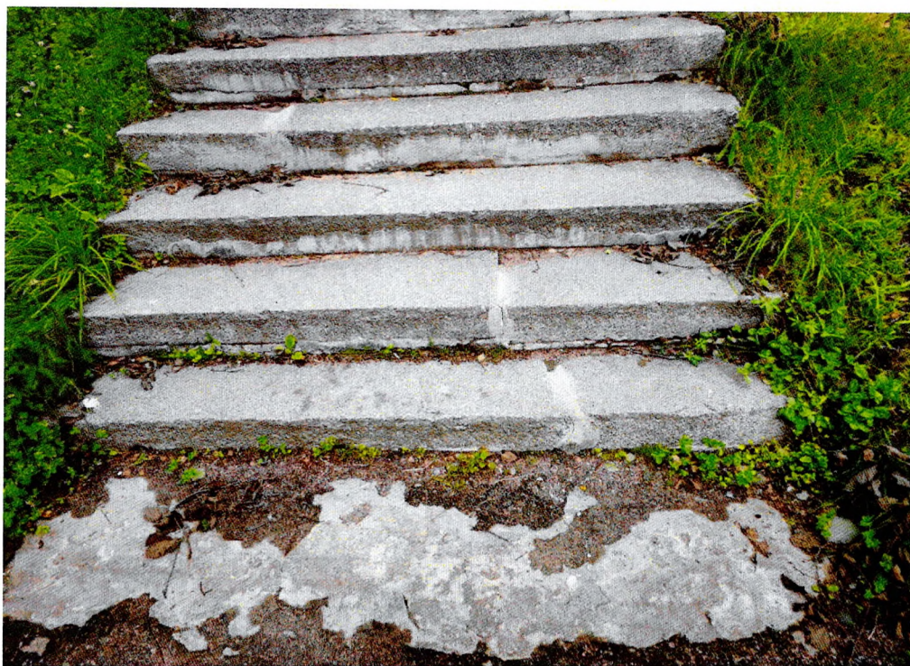
Фото 41. Лестница к мемориалу «Траурный курган». Некачественные ремонтные поновления растворных швов ступеней лестниц. Выкрашивание раствора из швов между блоками ступеней. Отдельные трещины по ступеням. Проседания и перекосы ступеней лестниц. Общее загрязнение поверхности камня. Произрастание растительности в швах между ступенями.
