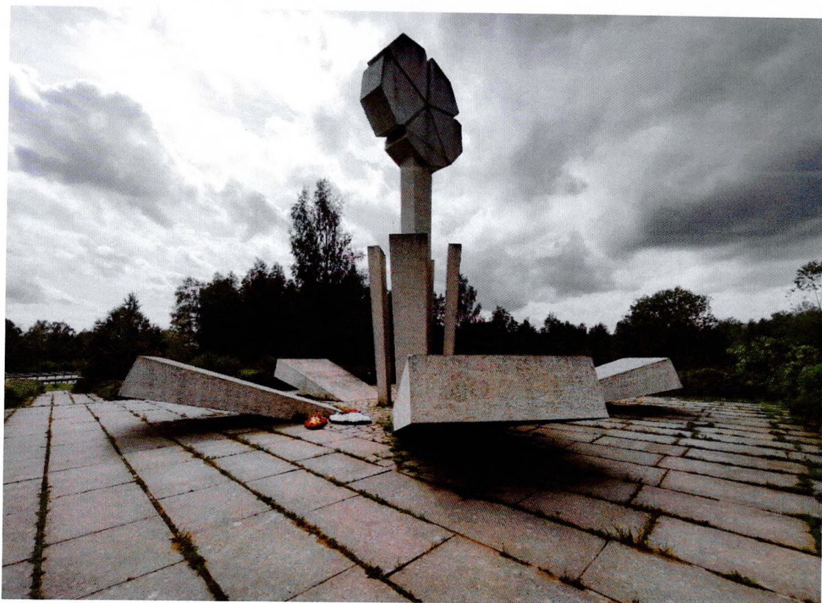
Фото 28. Вид на доминанту «Каменный цветок». Произрастание растительности в швах плит. Биопоражения элементов монумента. Общее загрязнение поверхности камня.
