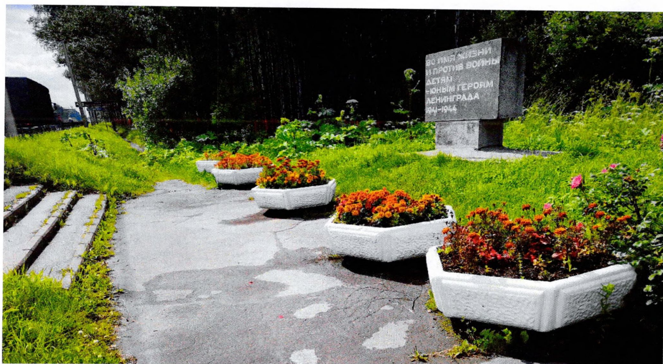
Фото 16. Общий вид мемориальной плиты 2. На площадке перед мемориальной плитой 2 наблюдаются следы намокания, биопоражения и трещины. Пять вазонов.
