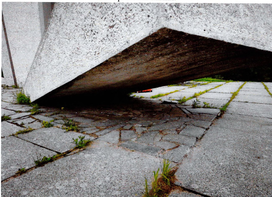
Фото 27. Лепесток доминанты «Каменный цветок». Сколы, следы замачиваний и биопоражения по элементу монумента. Нарушение горизонтального положения мозаичной плитки и гранитных плит под лепестком. Произрастание растительности в швах.
