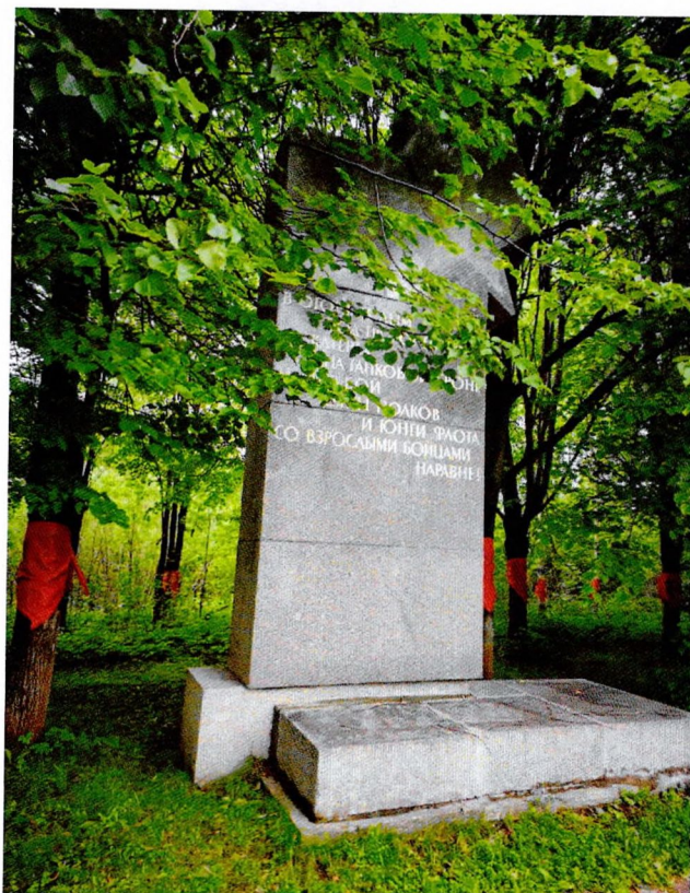
Фото 34. Памятная стела 2. Ремонтные поновления цементными растворами. Поверхностные пылеватые(сажистые) загрязнения. Сколы и трещины гранитных блоков. Образование трещин и зазоров по швам между отдельными блоками постаментов. Следы намокания и биопоражение по монументу.
