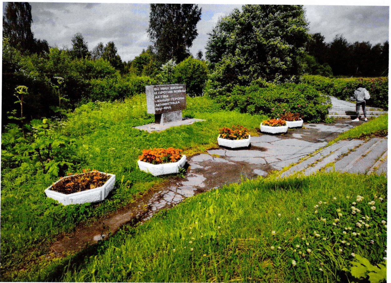
Фото 14. Общий вид мемориальной плиты 2. На площадке перед мемориальной плитой 2 наблюдаются следы намокания, биопоражения и трещины. Пять вазонов.
