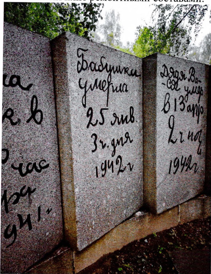
Фото 46. Мемориальные плиты «Дневник Тани Савичевой». Участки биопоражения по элементам монумента. Локальные участки сколов плит. Участки поновлений каменных плит ремонтными составами. Повреждение раствора в швах между блоками пьедестал. Поверхностные пылеватые(сажистые) загрязнения.
