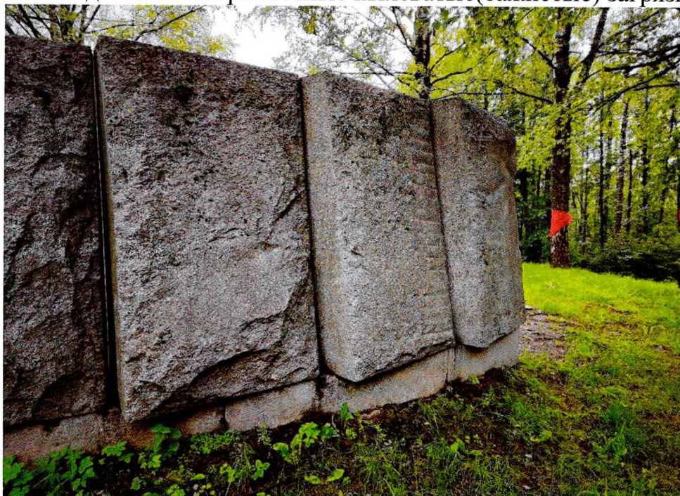
Фото 47. Мемориальные плиты «Дневник Тани Савичевой». Участки биопоражения по элементам монумента. Локальные трещины и участки сколов по плитам. Участки поновлений каменных плит ремонтными составами. Повреждение раствора в швах между блоками пьедестал. Поверхностные пылеватые(сажистые) загрязнения.
