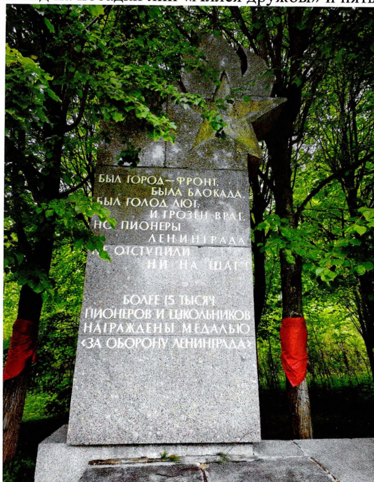
Фото 33. Памятная стела 1. Прорастание самопосевных растений. Ремонтные поновления цементными растворами. Поверхностные пылеватые(сажистые) загрязнения. Сколы гранитных блоков. Образование трещин и зазоров по швам между отдельными блоками постаментов.
