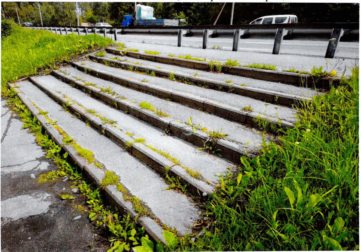
Фото 15. Общий вид одномаршевой лестницы перед мемориальной плитой 2. Множество биопоражений и следов намокания.
