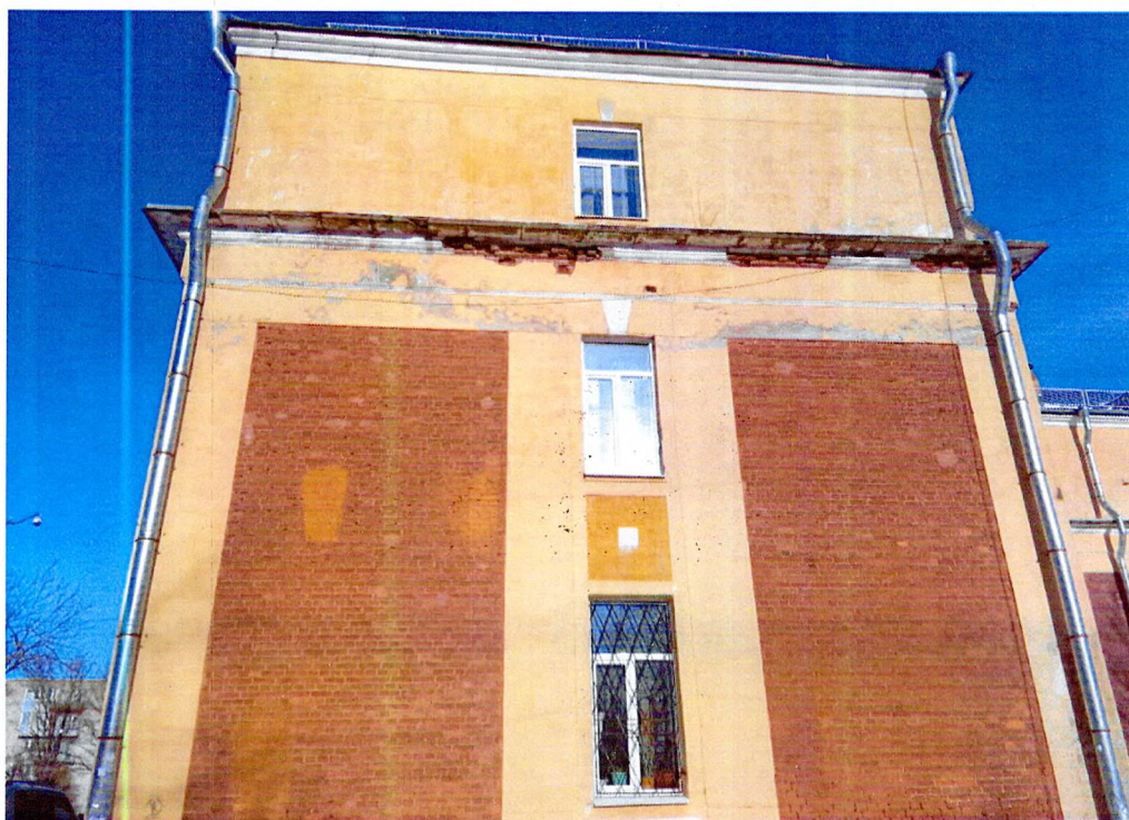
Фото 10. Юго-западный фасад. Утраты окрасочного слоя оштукатуренных поверхностей, многочисленные следы домазок окрашенной поверхности кирпичной кладки.
