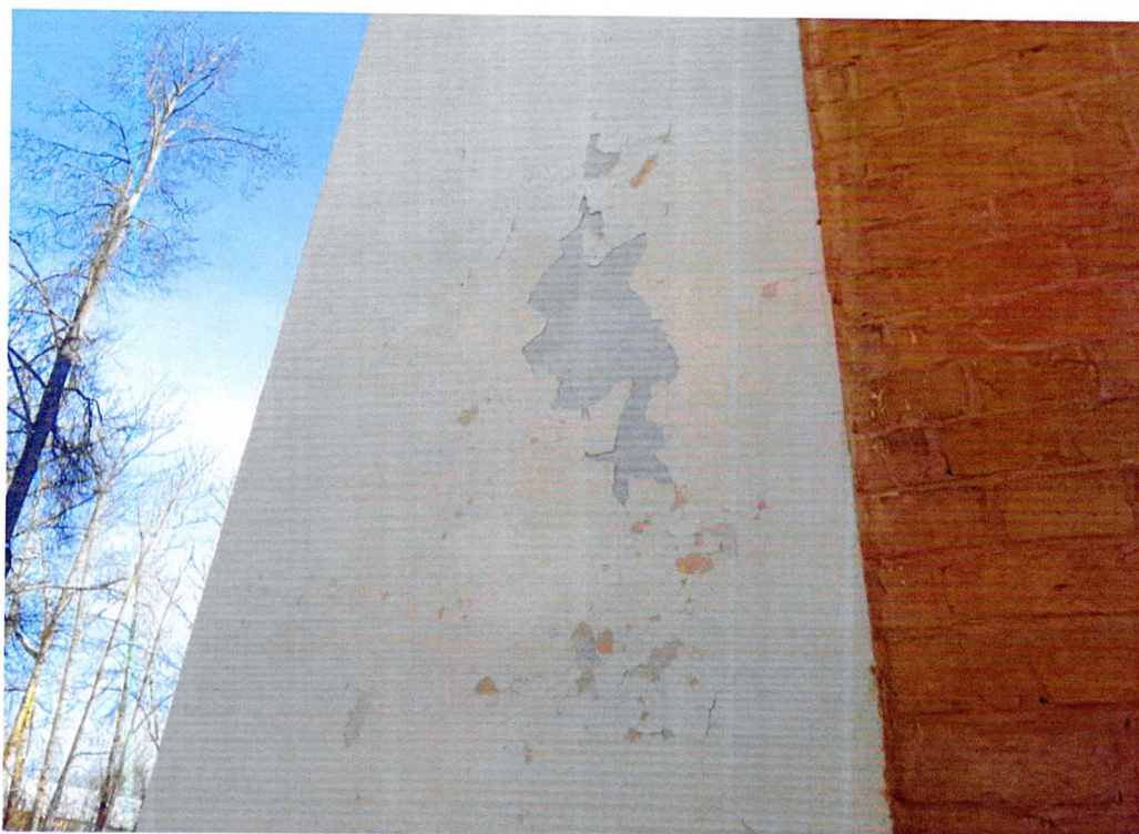
Фото 3. Фрагмент западного фасада. Отслоение окрасочного слоя стен фасада на оштукатуренных поверхностях.
