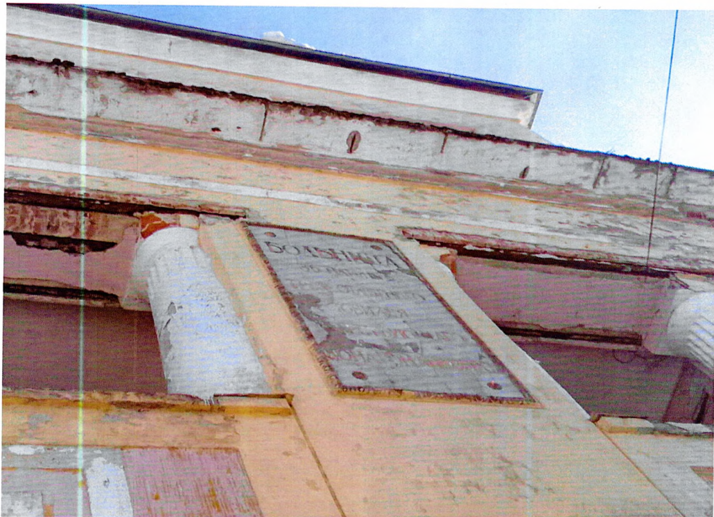
Фото 7. Фрагмент западного фасада. Разрушение штукатурного слоя, утрата надписей на памятной доске.
