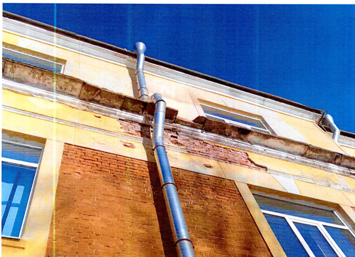
Фото 14. Фрагмент южного фасада, центральная часть. Разрушение карнизных плит. Утрата штукатурного слоя, обнажение кирпичной кладки.
