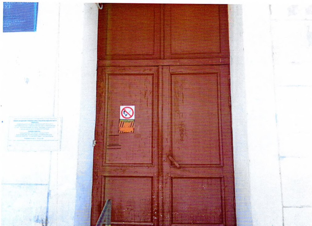
Фото 9. Фрагмент западного фасада. Стертость дверного полотна, щели в притворах, шелушение окраски двери главного входа.
