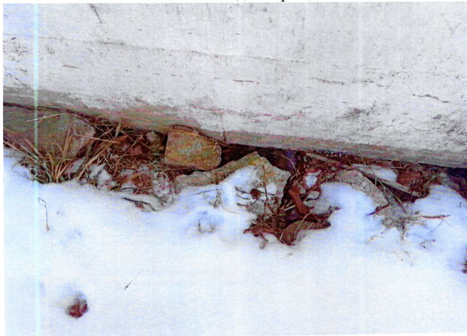
Фото 2. Фрагмент западного фасада. Разрушение бетонной отмостки, прорастание растений.
