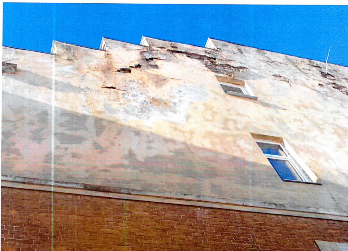
Фото 22. Фрагмент восточного фасада, центральная часть. Разрушение, отпадение штукатурного слоя в зоне ступенчатого щипца.
