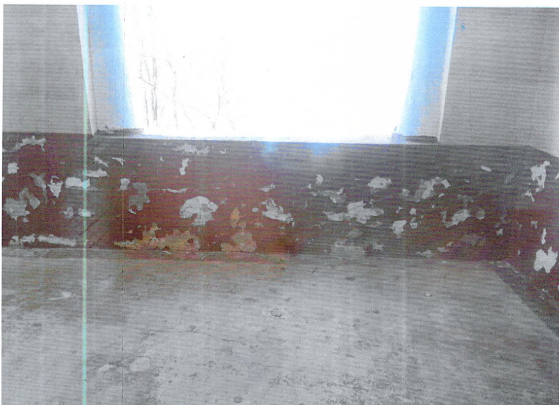
Фото 30. Терраса на третьем этаже. Отслоение окрасочного слоя внутренних поверхностей стен. Трещины в стяжке пола.
