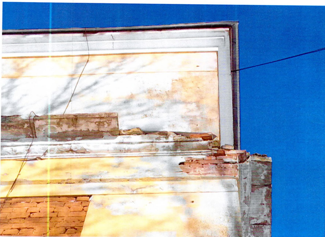
Фото 17. Юго-восточный фасад. Разрушение карнизных плит и штукатурных тяг, обнажение кирпичной кладки, выпадение отдельных кирпичей.
