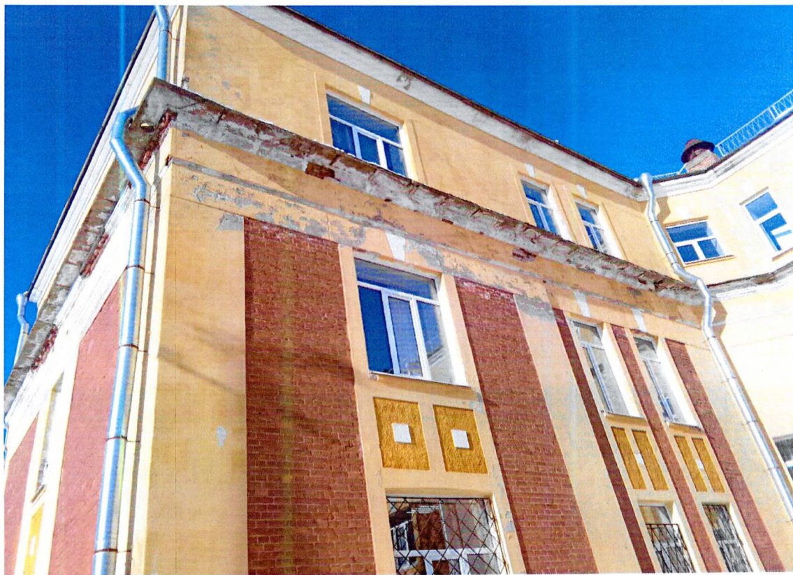
Фото 12. Юго-западный фасад, восточная часть. Утраты окрасочного слоя оштукатуренных поверхностей.
