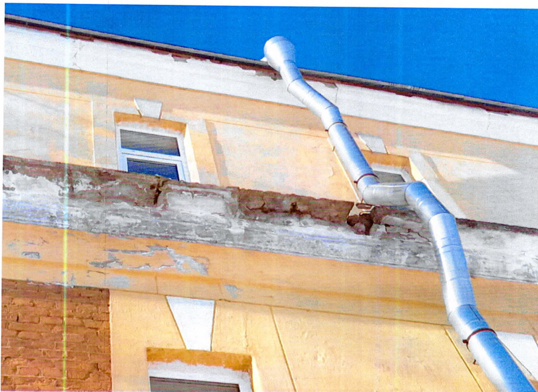
Фото 19. Фрагмент юго-восточного фасада, восточная часть. Разрушение карнизных плит в зоне примыкания водосточной трубы.
