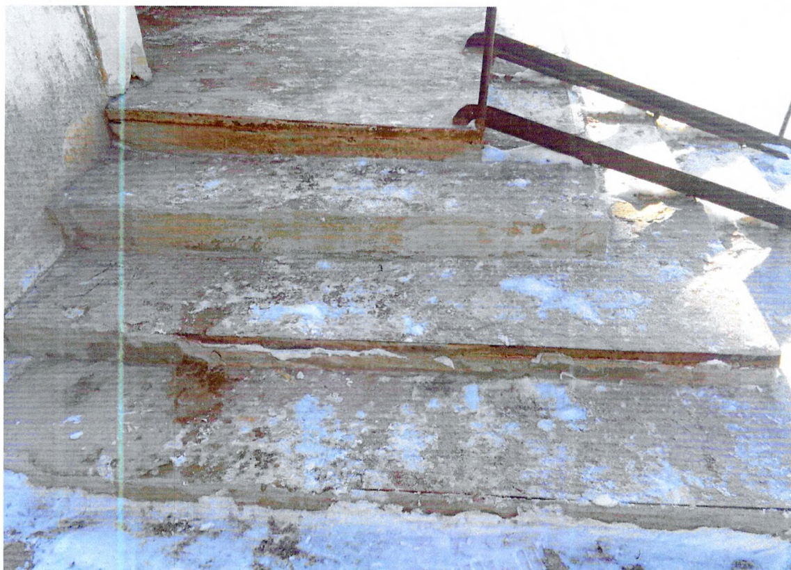
Фото 8. Фрагмент западного фасада. Трещины, сколы бетона ступеней.
