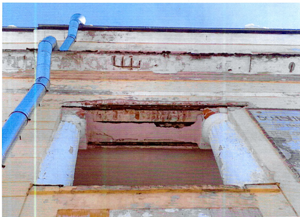
Фото 6. Фрагмент западного фасада. Утраты штукатурного слоя перемычки над террасой. Разрушение защитного слоя бетона, оголение и коррозия арматуры плит междуэтажного карниза.
